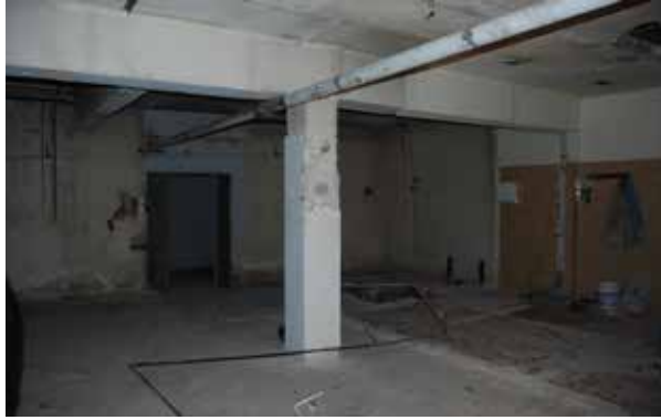
Εικ.89: Εικόνα απ το εσωτερικό του κτιρίου μας . Παρατηρούμε το χαμηλό ελεύθερο ύψος την κακή κατάσταση του εσωτερικού και τις μηχανολογικές εγκαταστάσεις .
