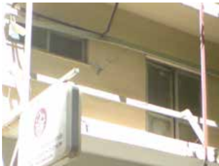
Εικ.87: Οι ρωγμές στους τοίχους είναι εμφανείς από μακριά
