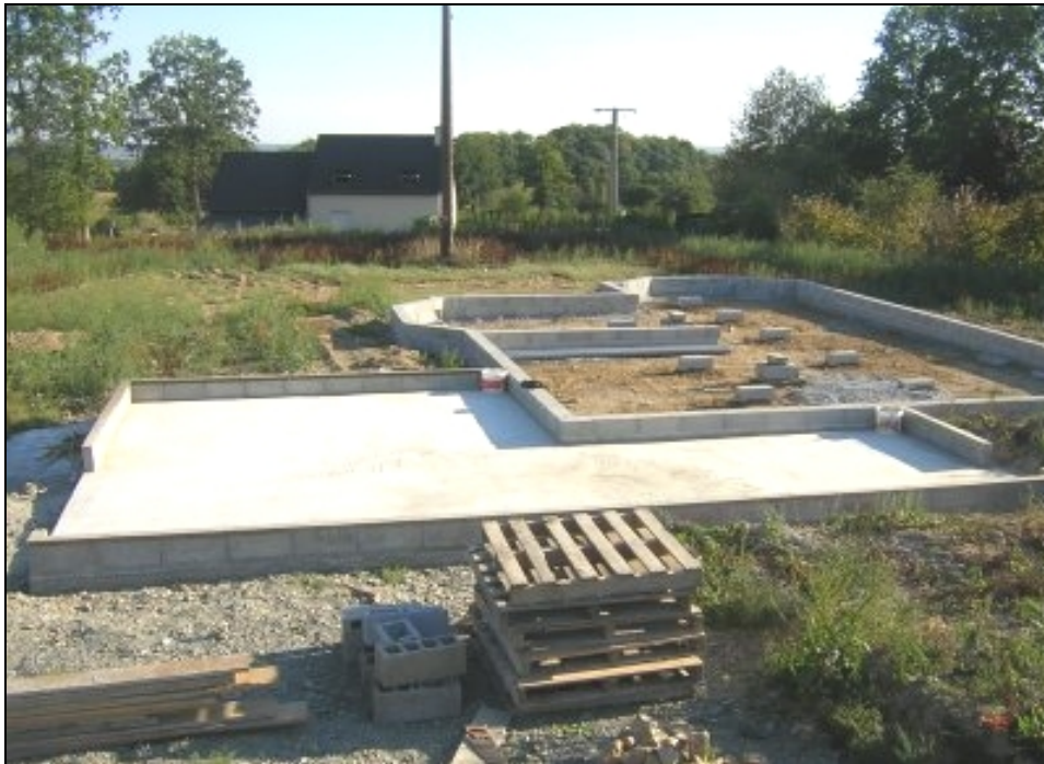
Εικ. 31 Πλατφόρμα θεμελίωσης
