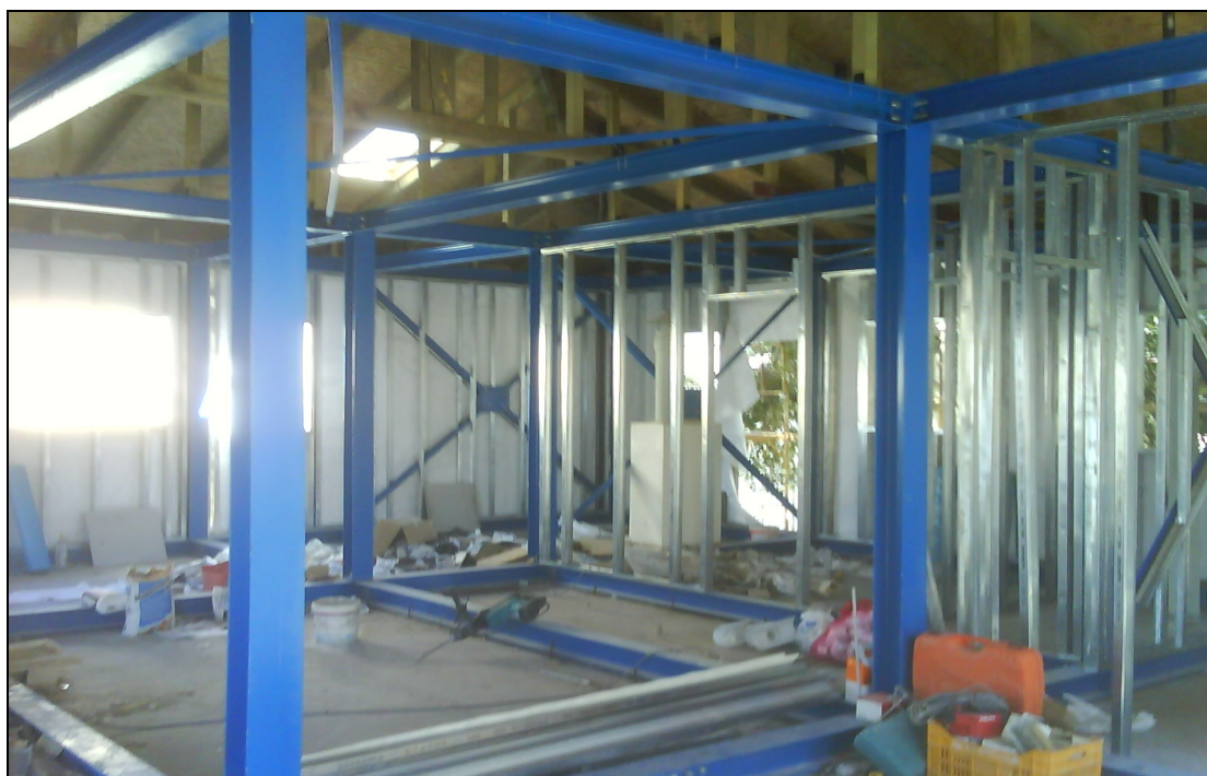
Εικ. 75 Τοποθέτηση κάθετων σιδερένιων ορθοστατών και οριζόντιων στρωτήρων για τη στήριξη γυψοσανίδας
