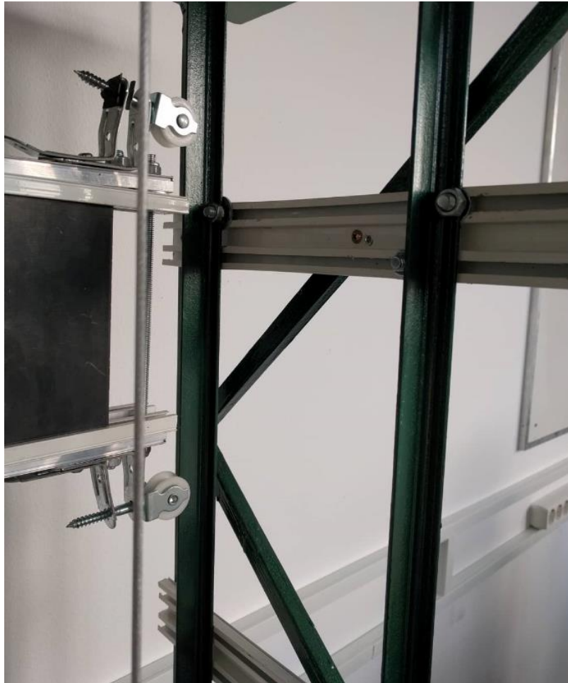
Εικόνα 10 Κάθετοι μεταλλικοί οδηγοί στήριξης θαλάμου – αντίβαρου
