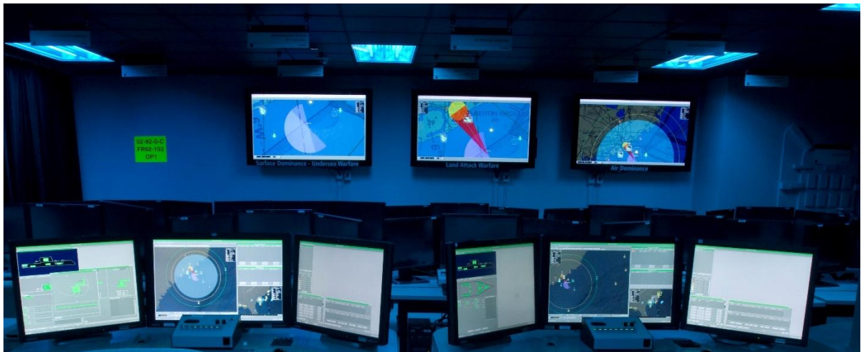
Εικόνα: Σύστημα Κεντρικού Ελέγχου
