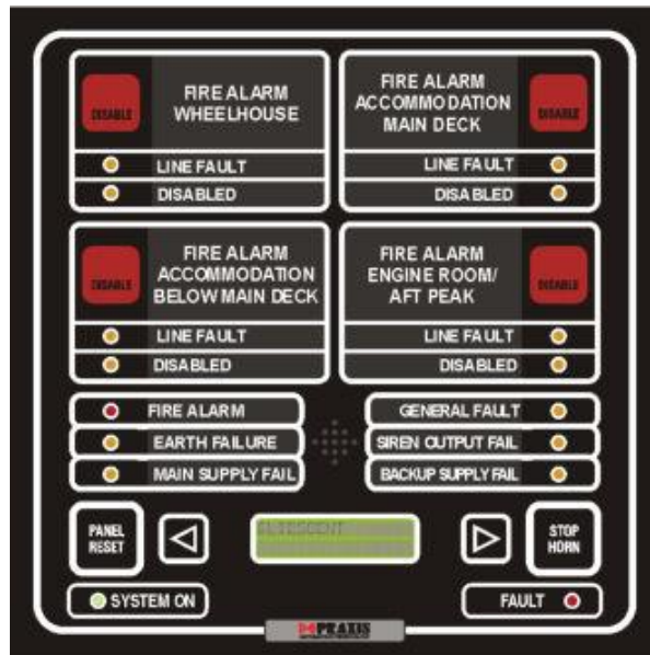
Εικόνα: Πάνελ συναγερμού πυρκαγιάς
