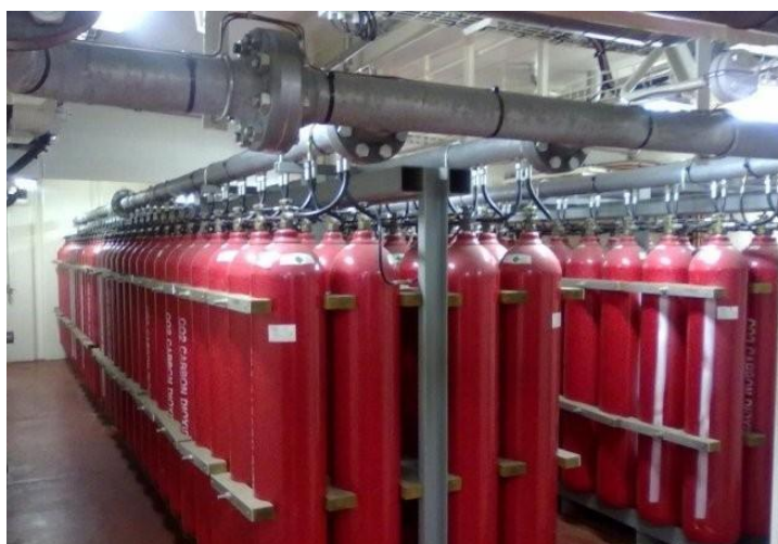
Εικόνα: Πυρόσβεση με CO 2
