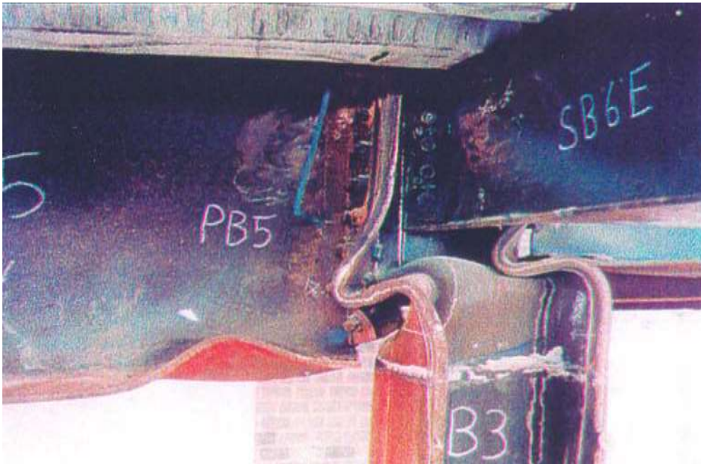
Εικόνα 6. Σύνθλιψη κεφαλής υποστυλώματος
