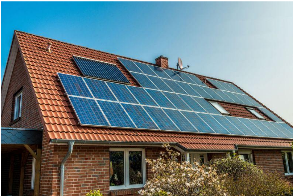
Εικόνα 1.6.3.1 Φωτοβολταϊκά πάνελ σε στέγη κτιρίου. Πηγή : http://www.insider.gr/sites/default/files/solar.jpg
