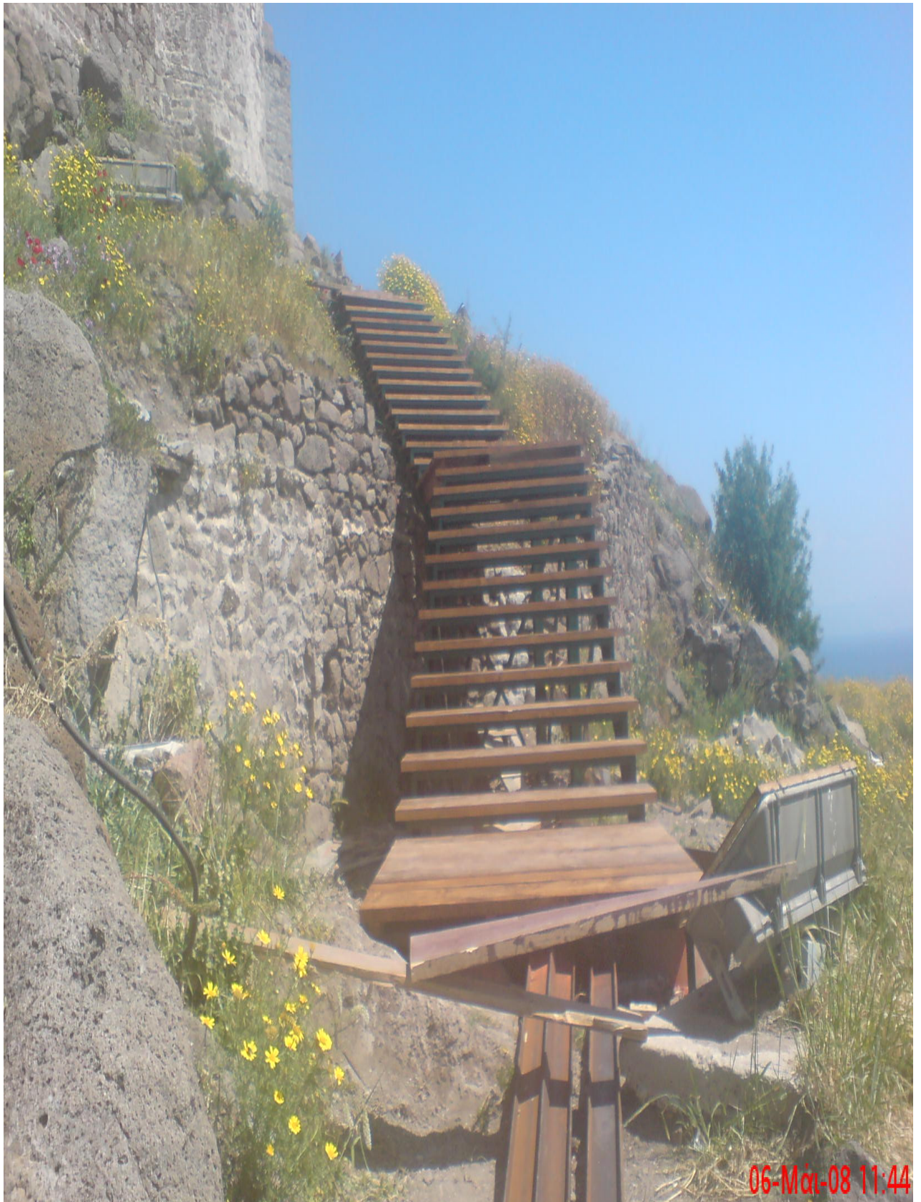
Μεταλλική πλατφόρμα (γέφυρα) από πολλαπλούς σιδεροδοκούς διατομής ΗΕΒ 140 στον περίβολο του κάστρου.
