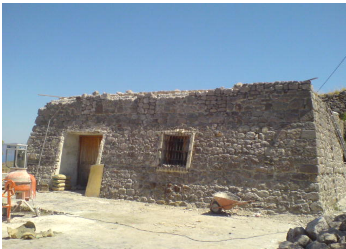
Επισκευη παλιας δεξαμενης για την χρηση Αναψυκτηριου Καθαιρεσεις και επενδυση κτιριου με τοπικους λιθους
