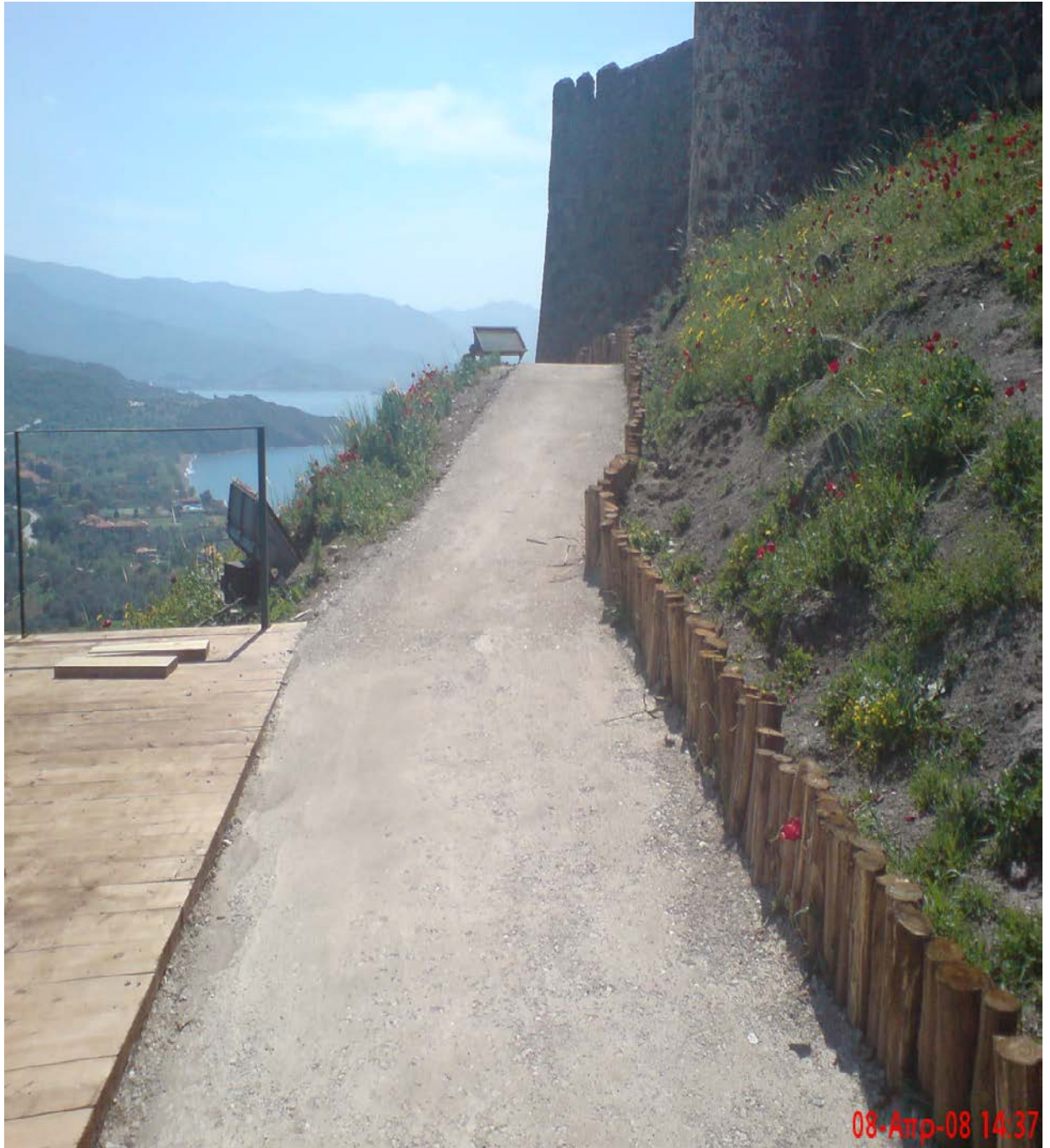
Διάδρομος από μίγμα χαλικιου-γαρμπιλιου-χωματος και λευκού τσιμέντου σε δυο στρώσεις των 6 εκατοστών.
