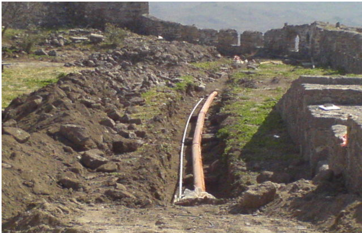
Ομβρια και σωληνας υδρευσης 1 ½ ιντσας
