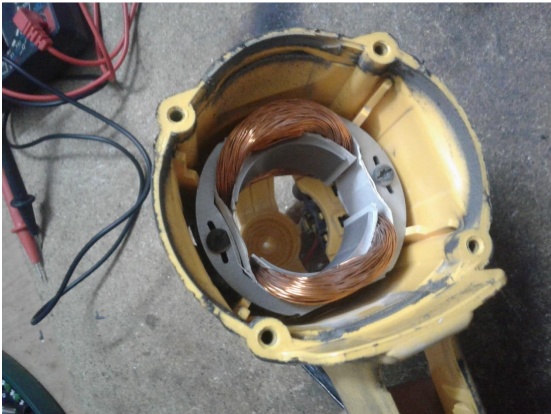
Εικόνα 45 Οπτικός έλεγχος πηνίου
