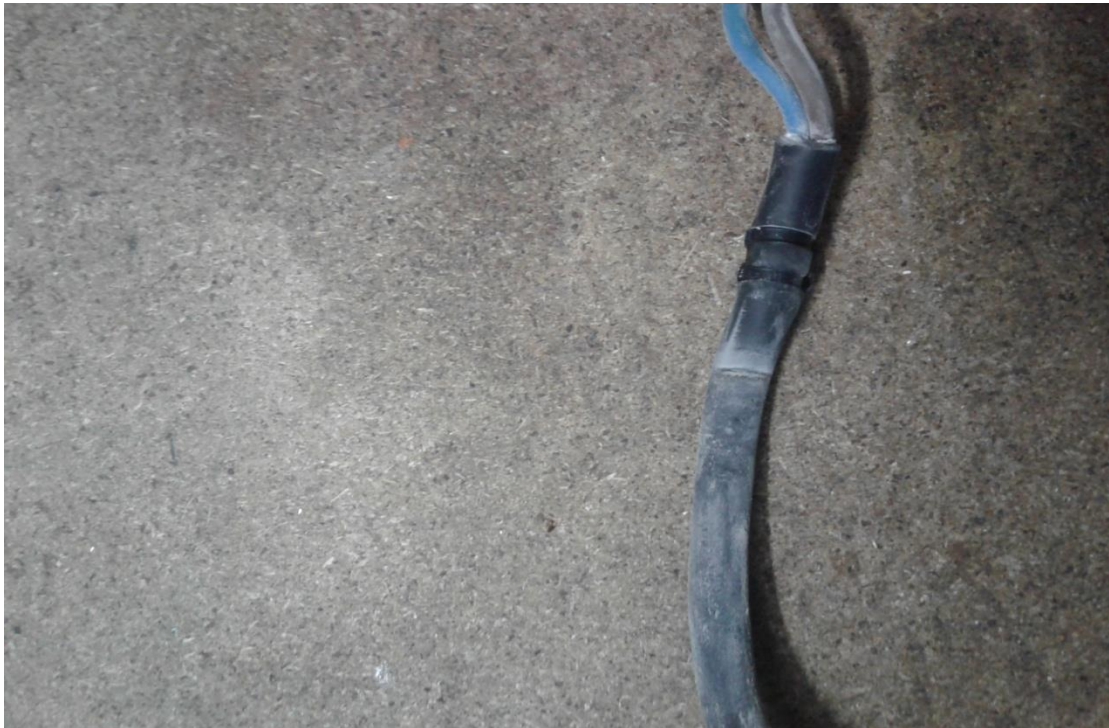
Εικόνα 38 Οπτικός έλεγχος καλωδίου
