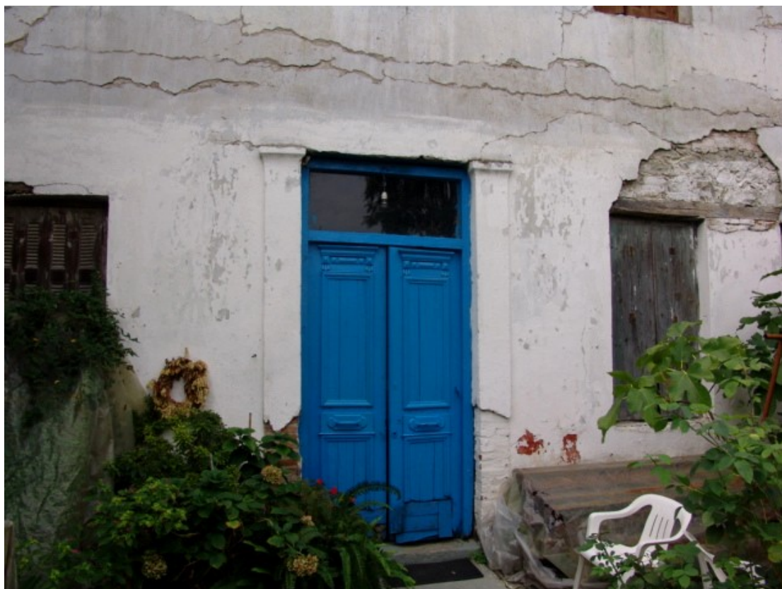
Φ71. Αποδιοργάνωση της τοιχοποιίας στο επίπεδο του δαπέδου ορόφου.
