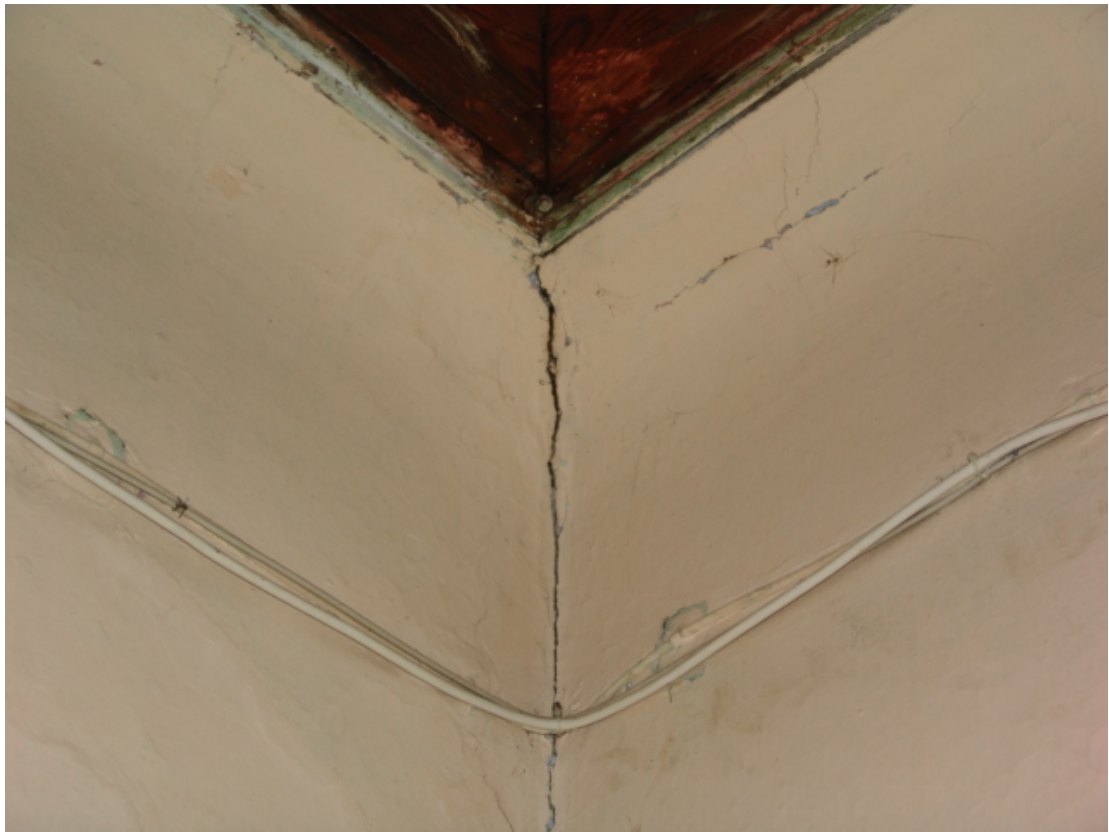
Φ114. Ρηγμάτωση ξύλινης τοιχοποιίας.
