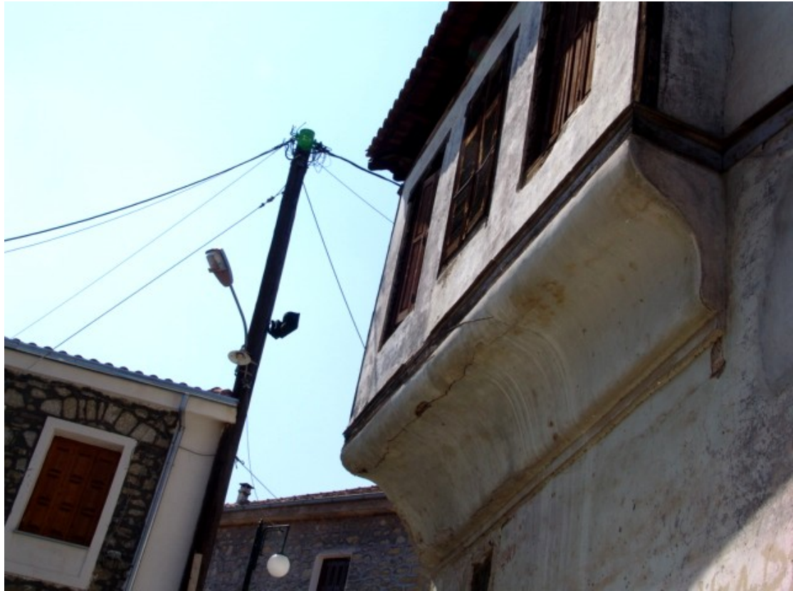
Φ57. Ρηγματώσεις στο φουρούσι του σαχισίου.
