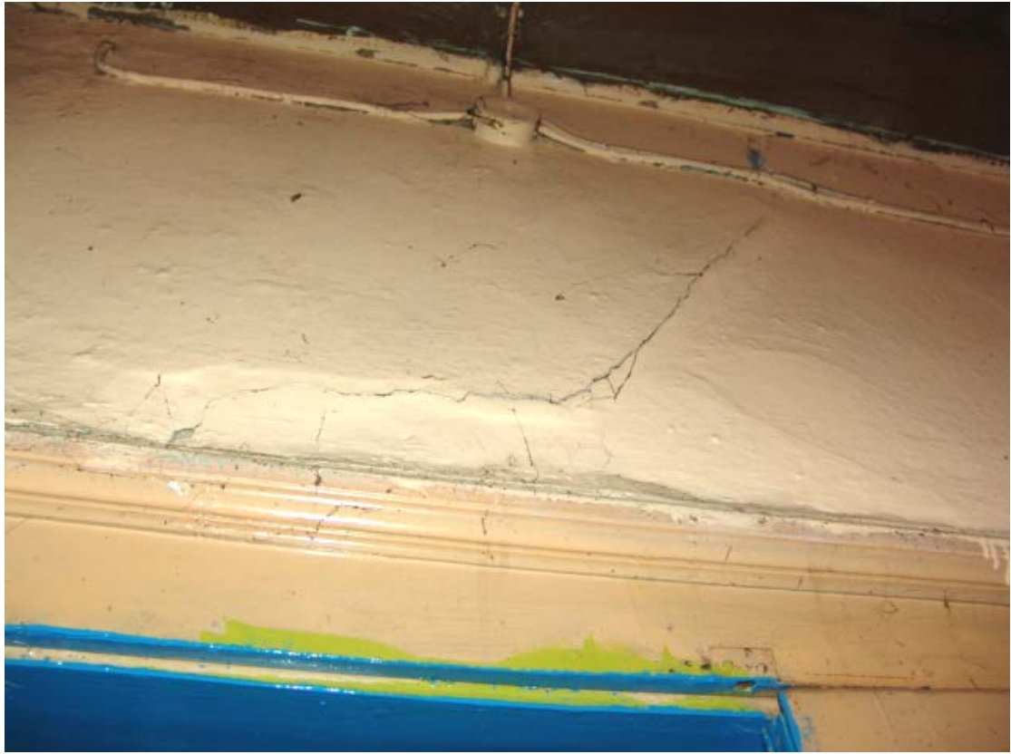
Φ94. Ρηγμάτωση στην τοιχοποιία.
