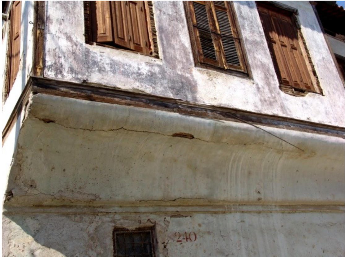
Φ60. Ρηγματώσεις στην έδραση και στη στέγη στο σαχνισί, γήρανση υλικών.
