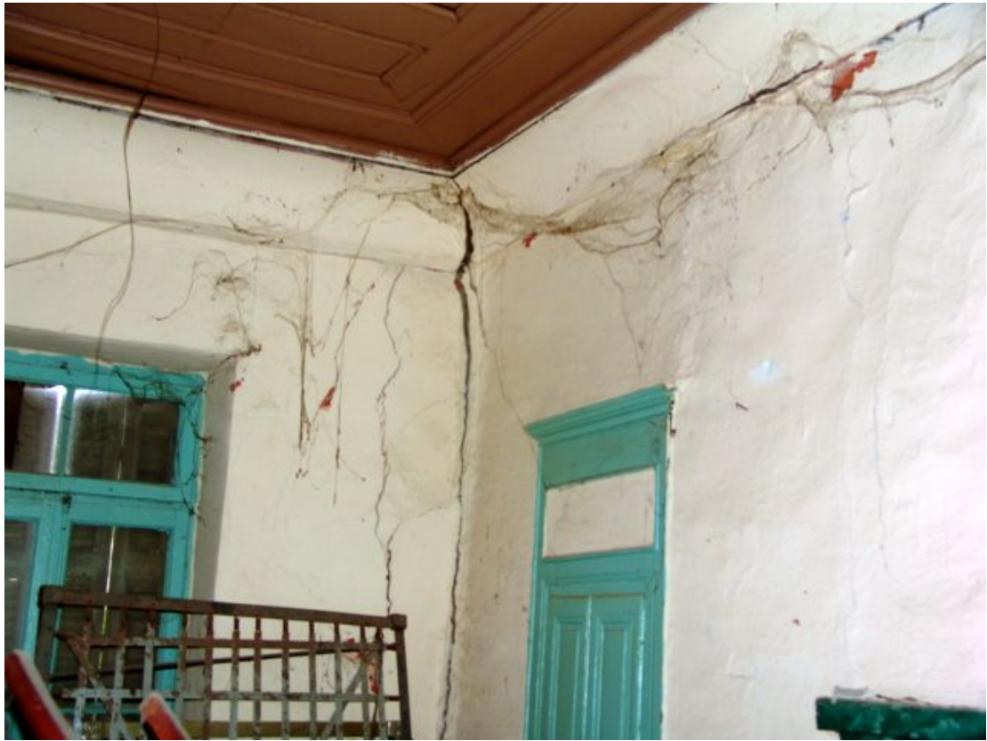
Φ108. Αποκόλληση εσωτερικής ξύλινης τοιχοποιίας από την εξωτερική από αοπτοπλινθοδομή.
