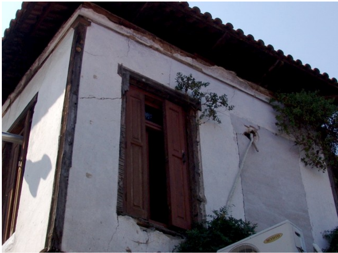
Φ80. Κλεισμένο παράθυρο και κατεστραμμένη κορνίζα στον όροφο. Ρηγματώσεις στην τοιχοποιία.
