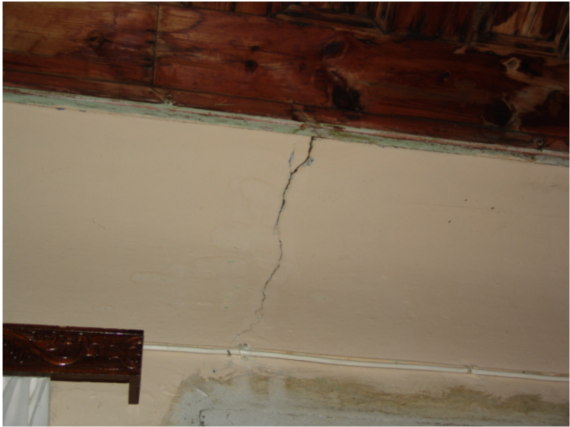
Φ113. Ρηγμάτωση ξύλινης τοιχοποιίας.
