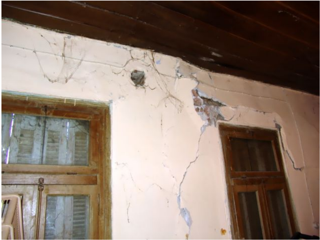
Φ99. Αποσύνθεση τοιχοποιίας από αοπτοπλινθοδομή στο ισόγειο.
