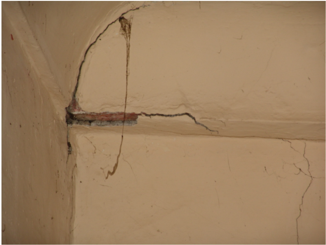
Φ110. Ρηγμάτωση στην ένωση της ξύλινης τοιχοποιίας.
