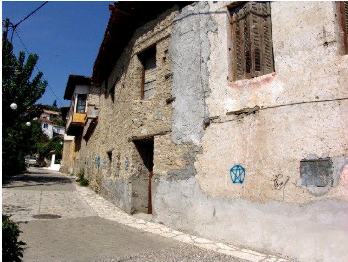
Φ90. Πρόχειρη επισκευή ρηγματώσεων της Φ89 (στην αποτοπλινοδομή του ορόφου).
