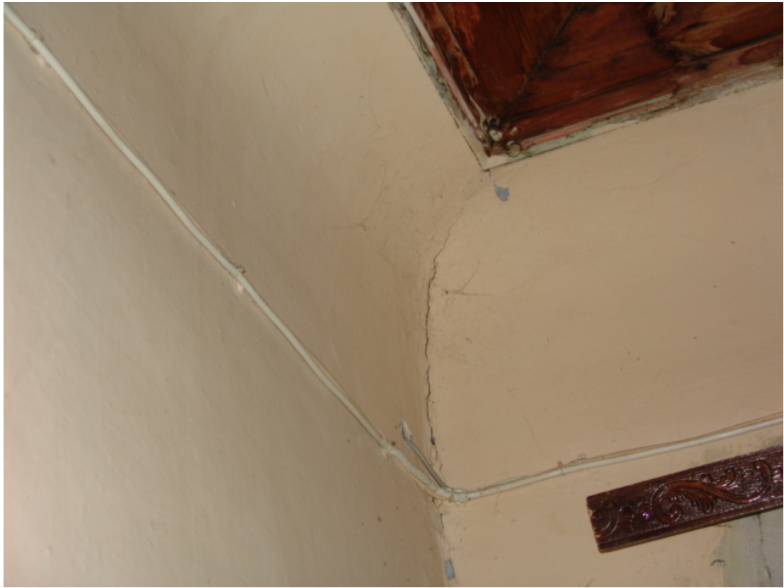
Φ112. Ρηγμάτωση ξύλινης τοιχοποιίας.
