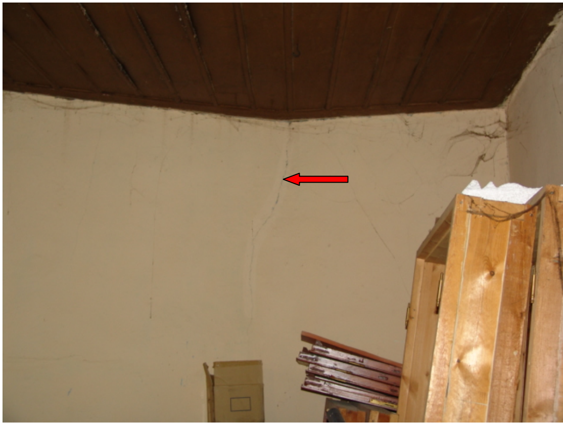
Φ96. Ρηγμάτωση στην τοιχοποιία.
