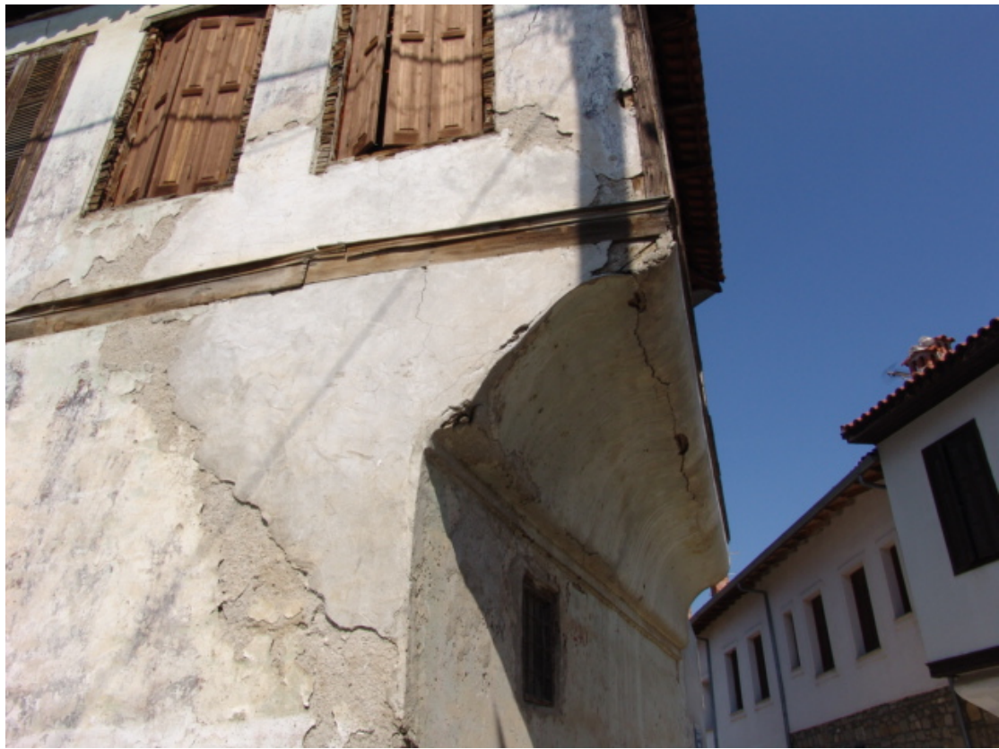
Φ62. Ρηγματώσεις στο ισόγειο και στον όροφο, αποσάθρωση κονιαμάτων.
