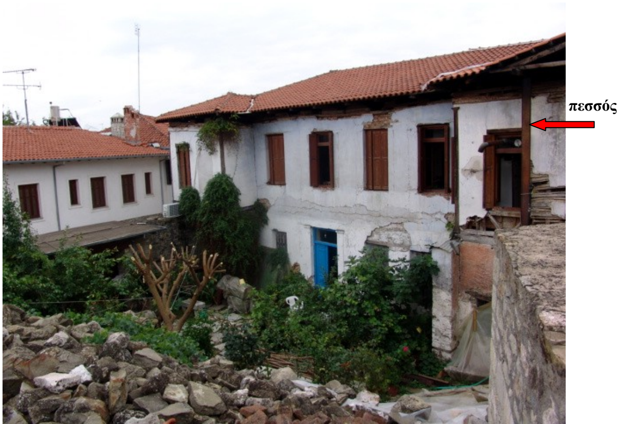
Φ13. Εσωτερική όψη, διακρίνεται ο πεσσός που συνδέει το κατεστραμμένο τμήμα με το υπόλοιπο κτίριο.
