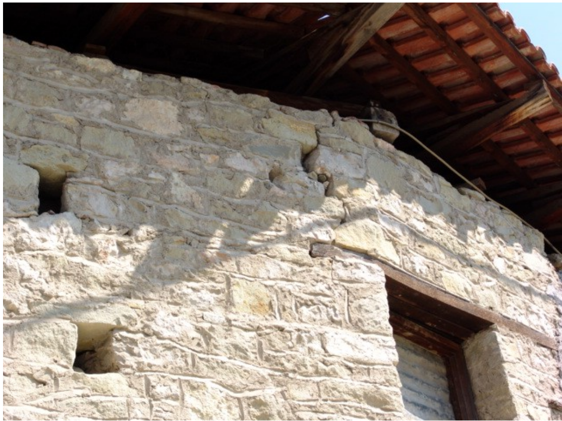
Φ92. Λεπτομέρεια - εμφανής ρηγμάτωση στην αλλαγή κατεύθυνσης της τοιχοποιίας από λιθοδομή (πάνω από το ξύλινο πρέκι).
