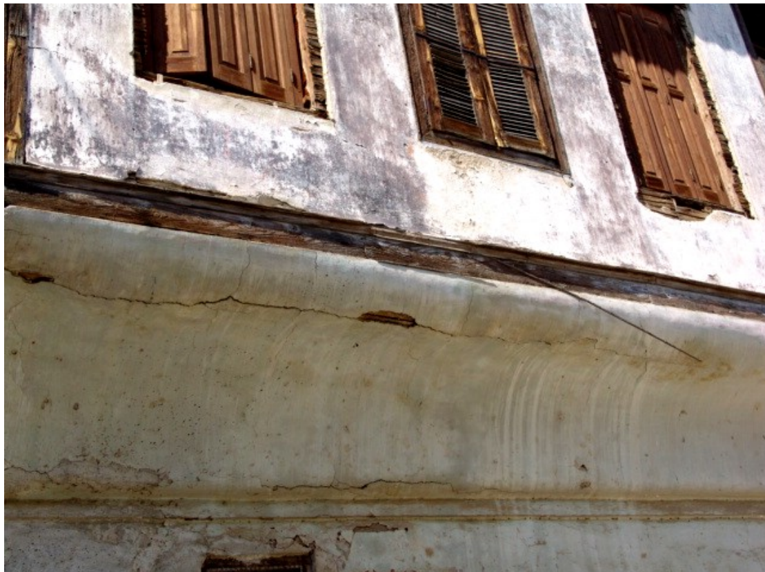
Φ59. Οριζόντιες ρηγματώσεις στον όροφο και το σαχνισί.
