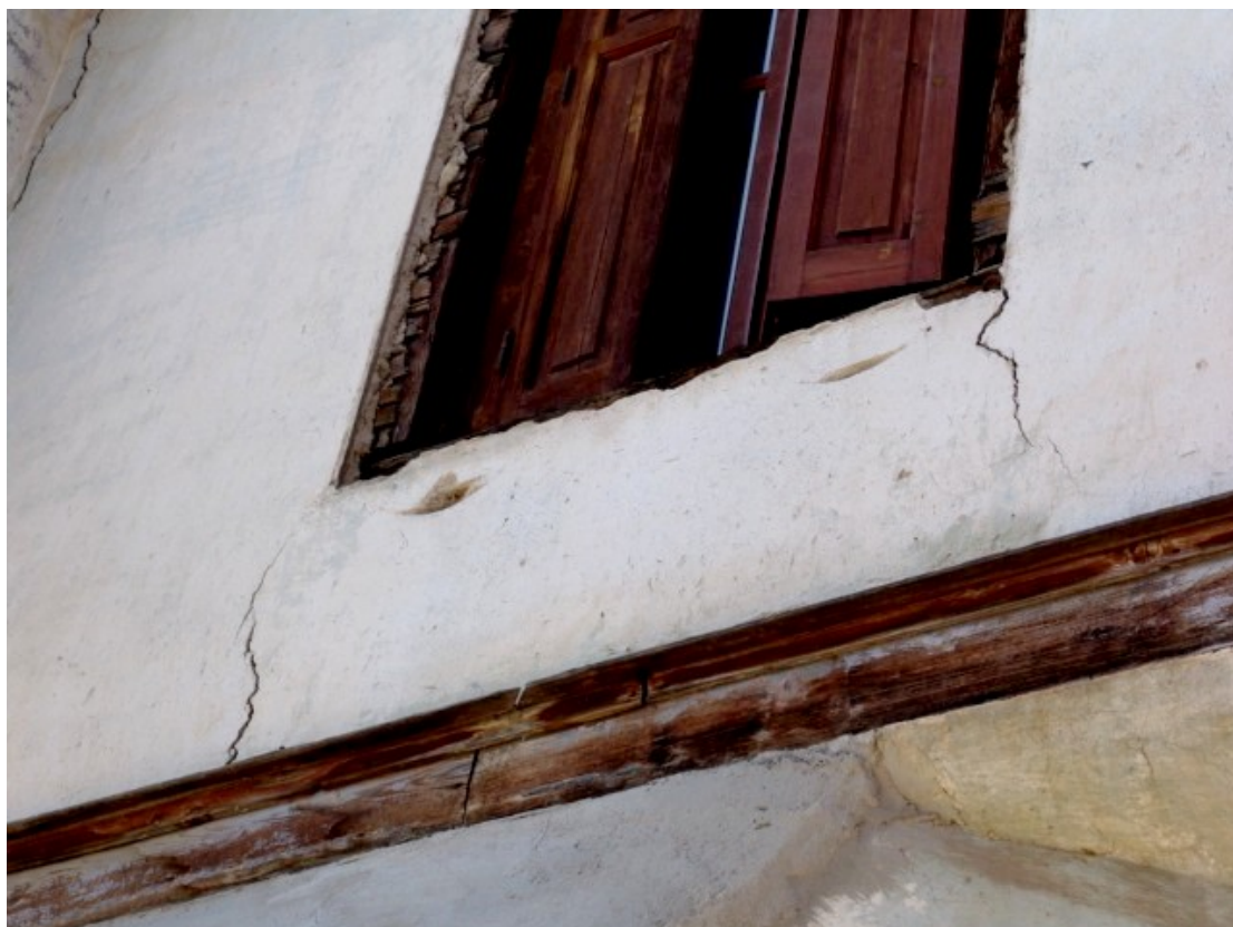
Φ81. Ρηγματώσεις στην ξύλινη τοιχοποιία (όροφος).
