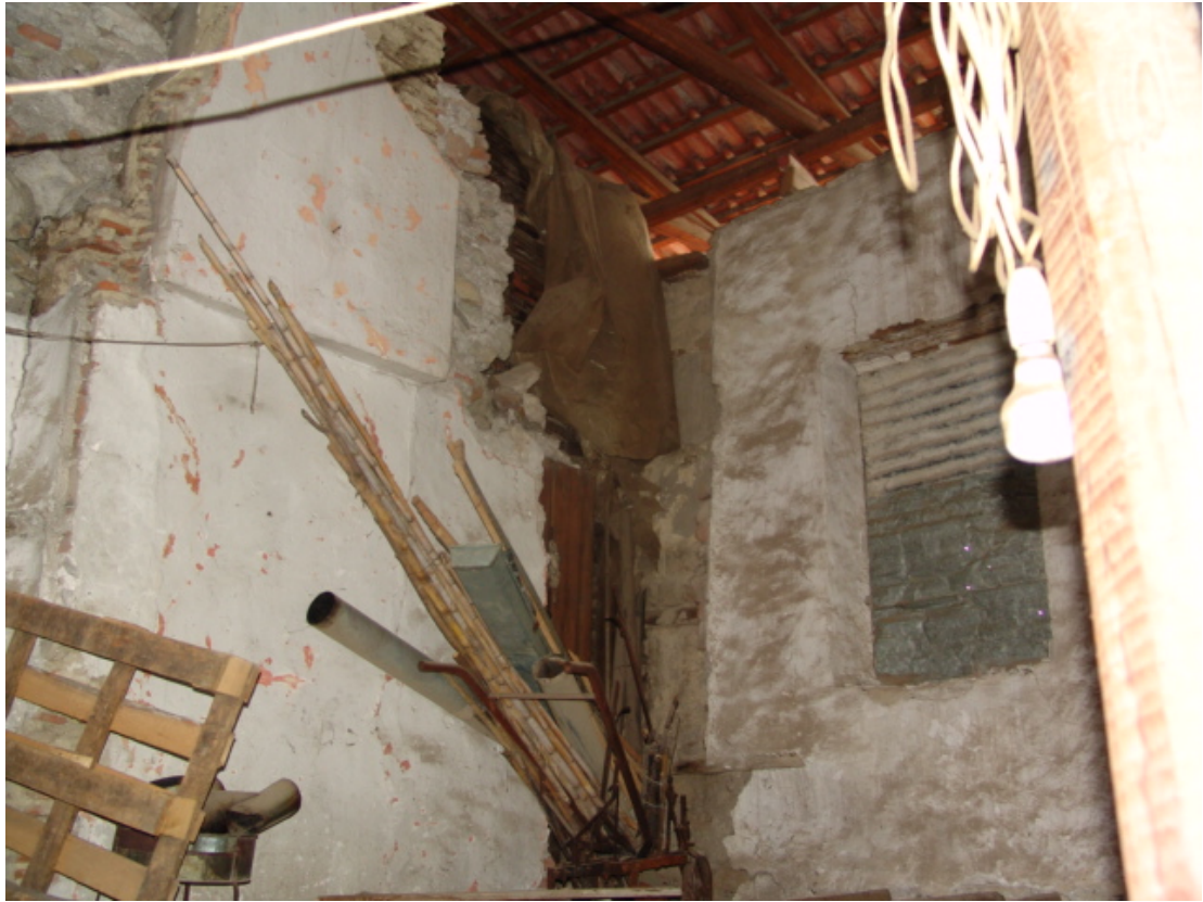
Φ104. Αποκόλληση εσωτερικής ξύλινης τοιχοποιίας από την αντίστοιχη εξωτερική από αοπτοπλινθοδομή (επί της Τέλλου Άγρα).
