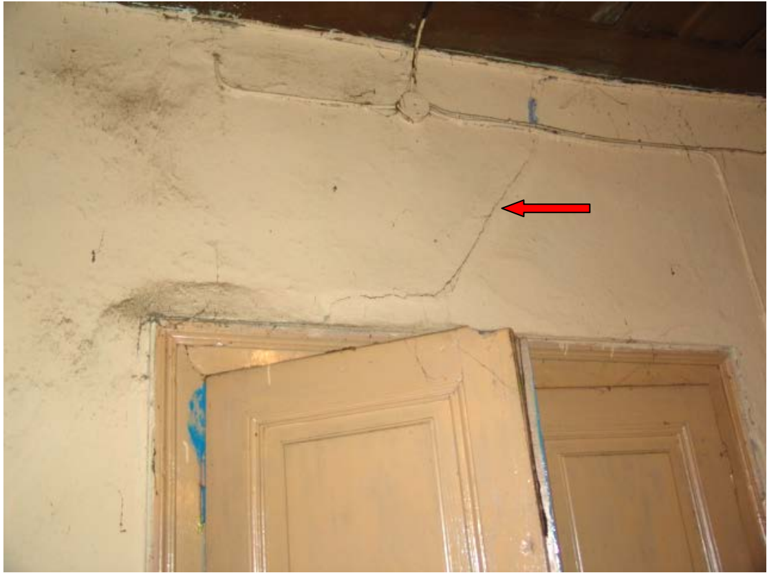
Φ95. Ρηγμάτωση στην τοιχοποιία.
