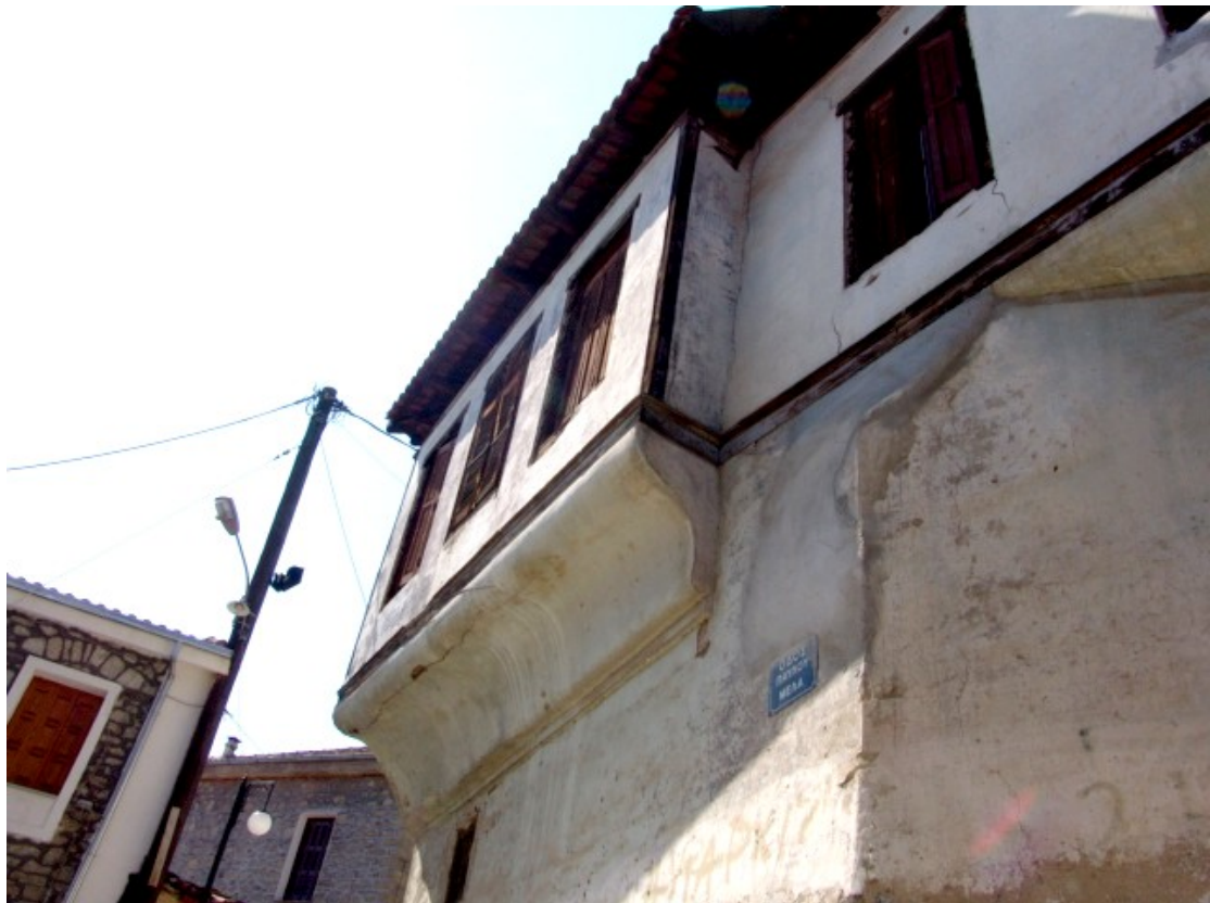
Φ32. Εξωτερικό αρχιτεκτονικό στοιχείο Εύλινες λεπτομέρειες στην αλλαγή κατεύθυνσης (κατακόρυφα και στο δάπεδο ορόφου).
