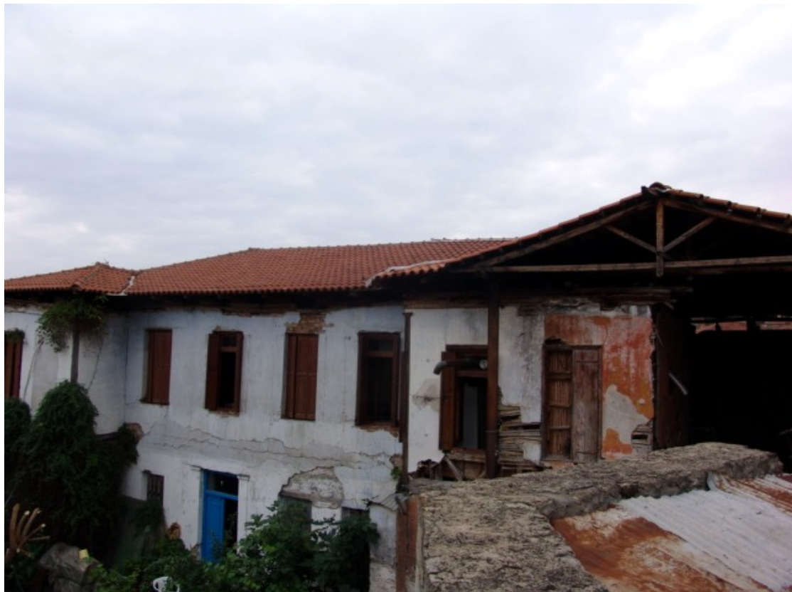
Φ64. Ρηγματώσεις στο ισόγειο και στον όροφο, άποψη ερειπωμένου τμήματος.
