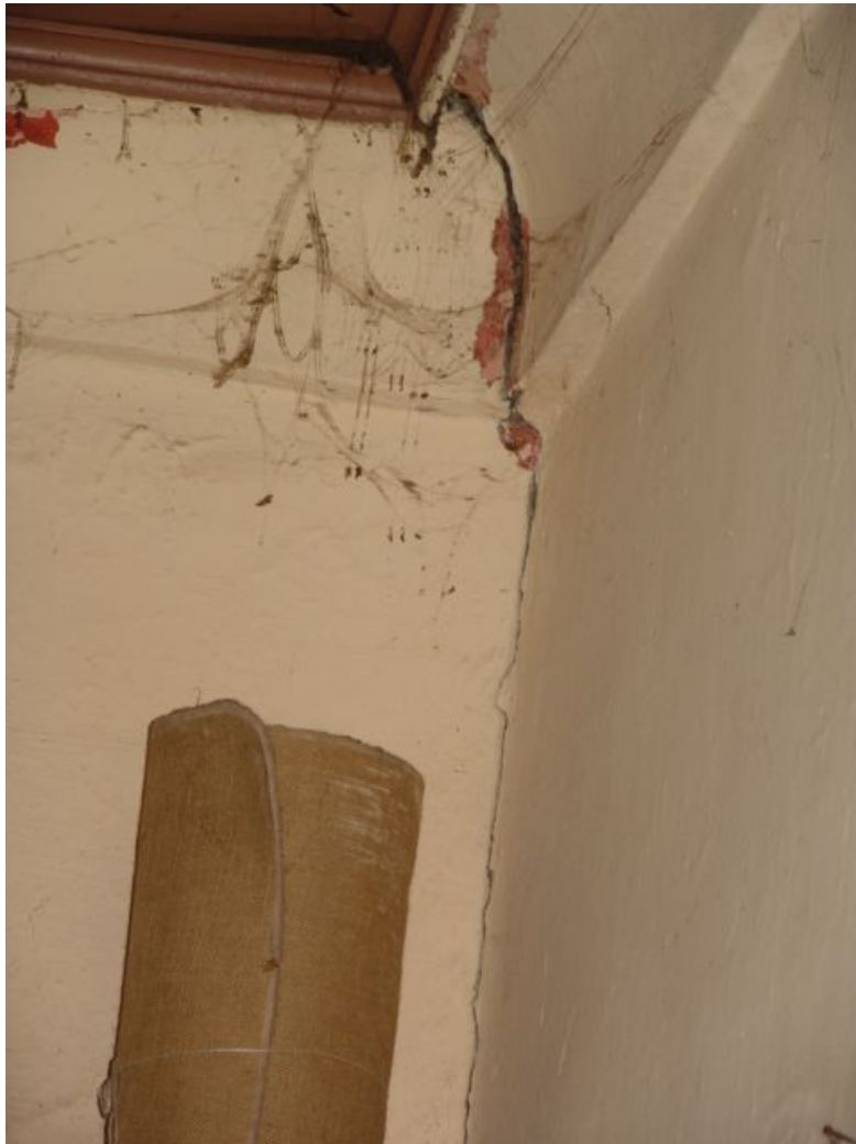
Φ111. Ρηγμάτωση στην ένωση της ξύλινης τοιχοποιίας.
