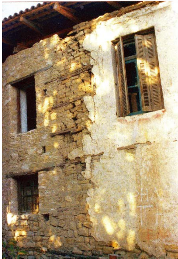
Φ89. Αποσύνθεση τοιχοποιίας από αοπτοπλινθοδομή με ιδιαίτερη έμφαση στις θέσεις σύνδεσης της με την λιθοδομή. Μετατόπιση οριζοντίων ξύλινων σενάξ της τοιχοποιίας.
