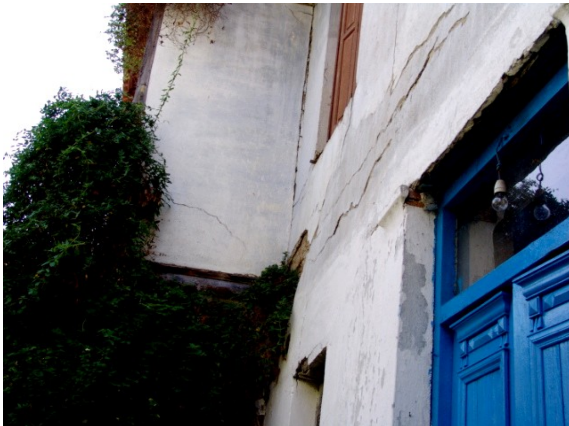
Φ76. Ρηγματώσεις, λεπτομέρεια στην αλλαγή κατεύθυνσης της τοιχοποιίας.
