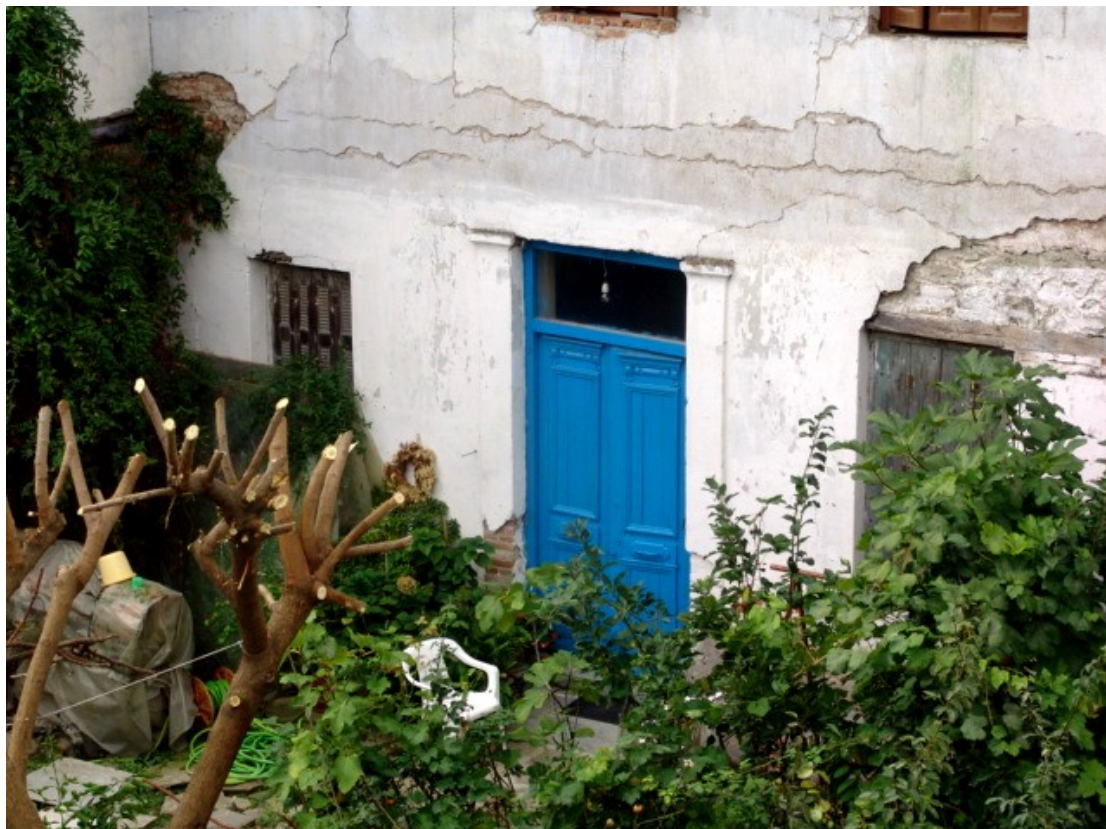
Φ70. Αποδιοργάνωση της τοιχοποιίας στο επίπεδο του δαπέδου ορόφου.
