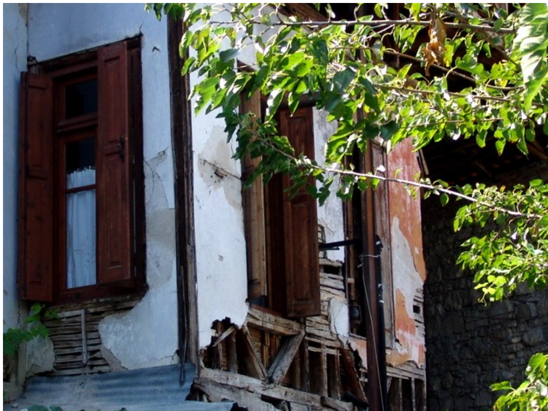
Φ67. Αποκολλήσεις των επιχρισμάτων του ορόφου στην ξύλινη κατασκευή (γήρανση υλικών).
