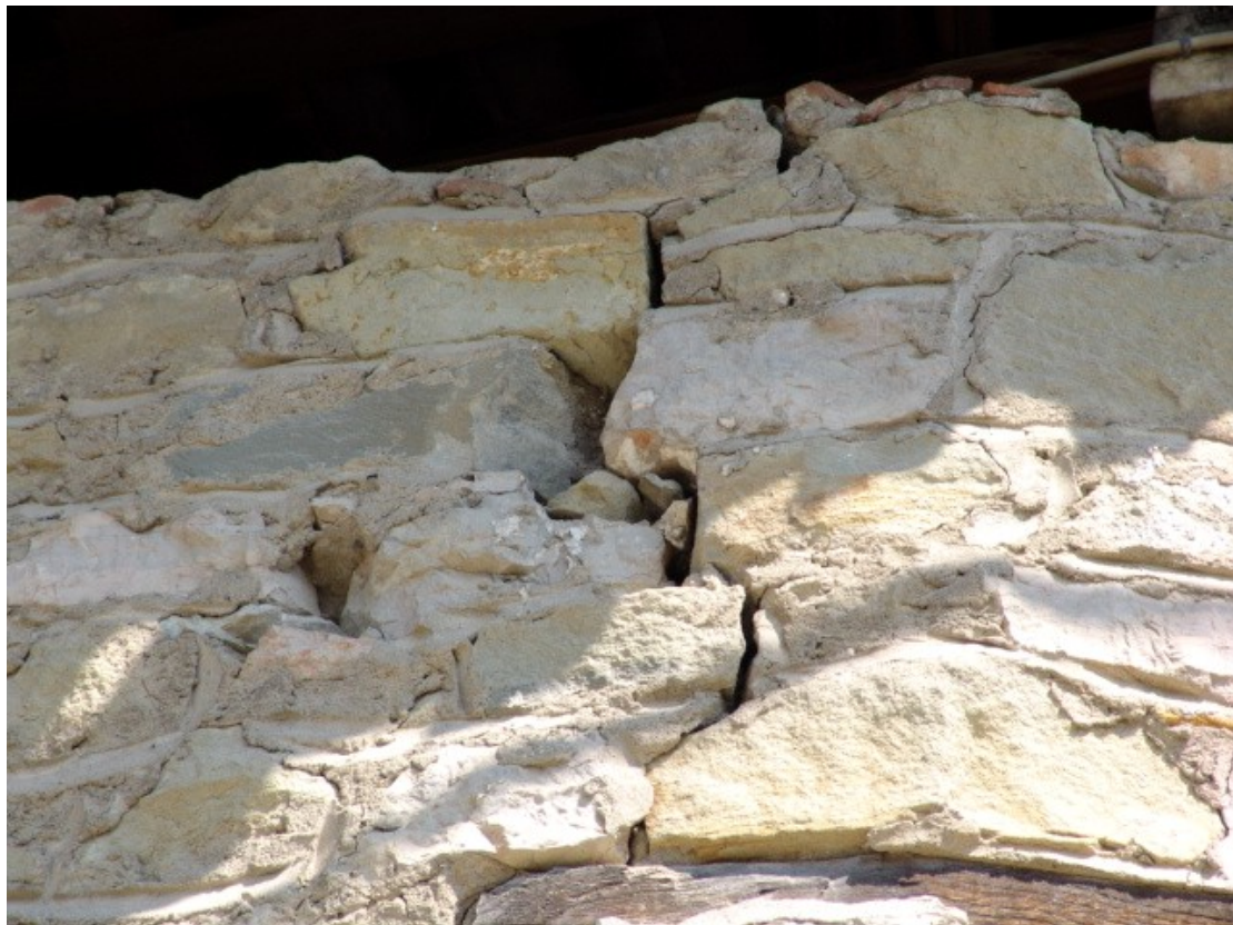
Φ93. Λεπτομέρεια - εμφανής ρηγματώση στην αλλαγή κατεύθυνσης της τοιχοποιίας από λιθοδομή στον όροφο.
