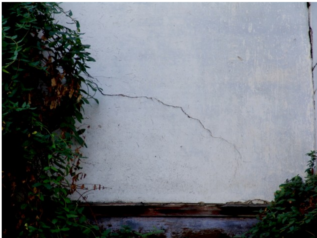
Φ78. Ρηγμάτωση (ξυλόπηκτη κατασκευή στον όροφο).
