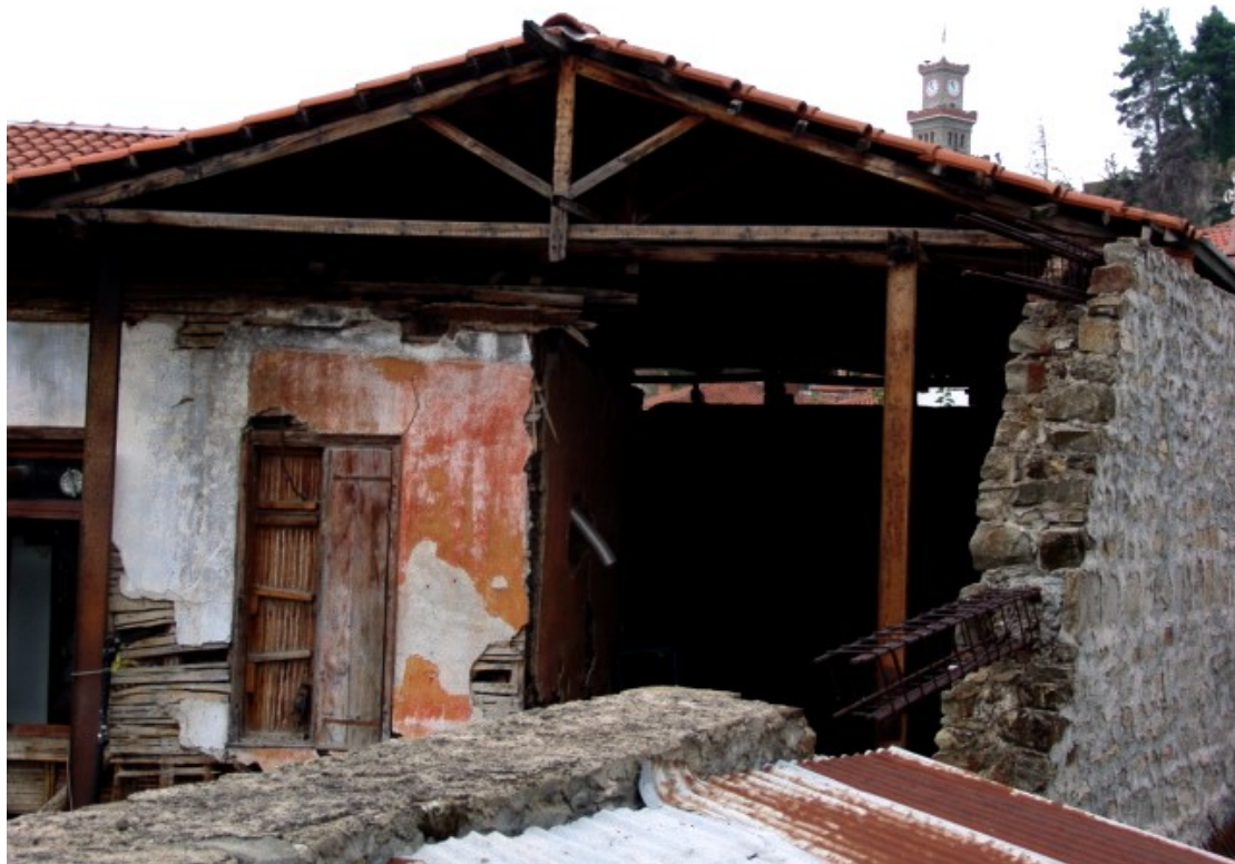
Φ83. Λιθοδομή στο όριο με ιδιοκτησία Σιμή, αποδιοργάνωση ξύλινης τοιχοποιίας ορόφου.
