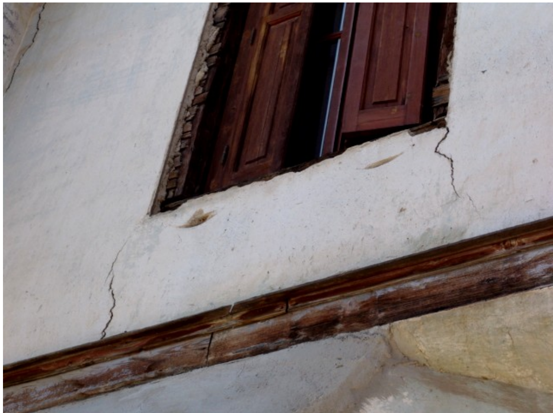
Φ63. Αποκόλληση τοιχοποιίας στην αλλαγή κατεύθυνσης – ρηγματώση στα επιχρίσματα του ισόγειου και του ορόφου.
