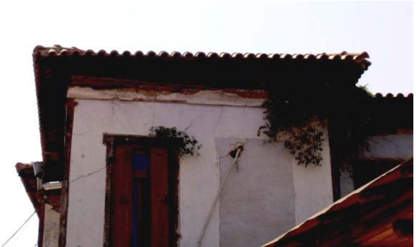
Φ79. Κλεισμένο παράθυρο και κατεστραμμένη κορνίζα στον όροφο. Ρηγματώσεις στην τοιχοποιία.
