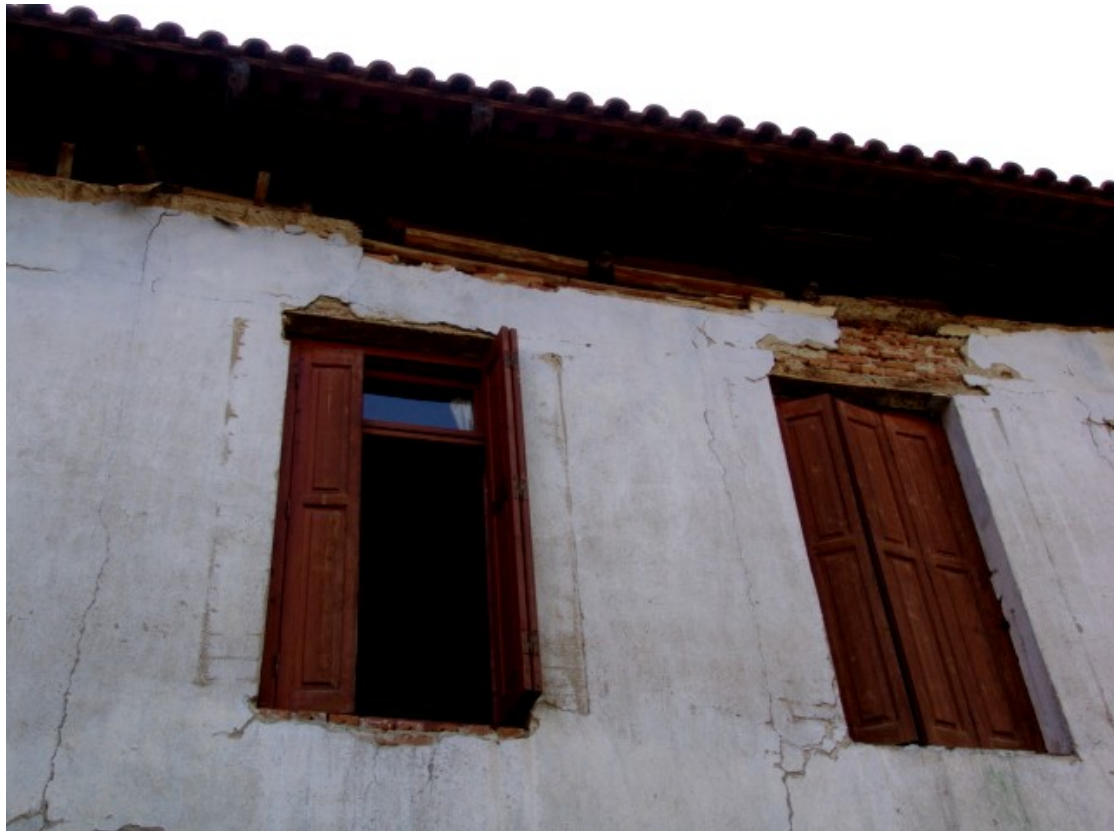
Φ75. Αποδιοργάνωση τοιχοποιίας από οπτοπλινθοδομή στον όροφο, ρηγματώσεις, αποκόλληση επιχρισμάτων και στέγης οροφής στην προεξοχή της στέγης.
