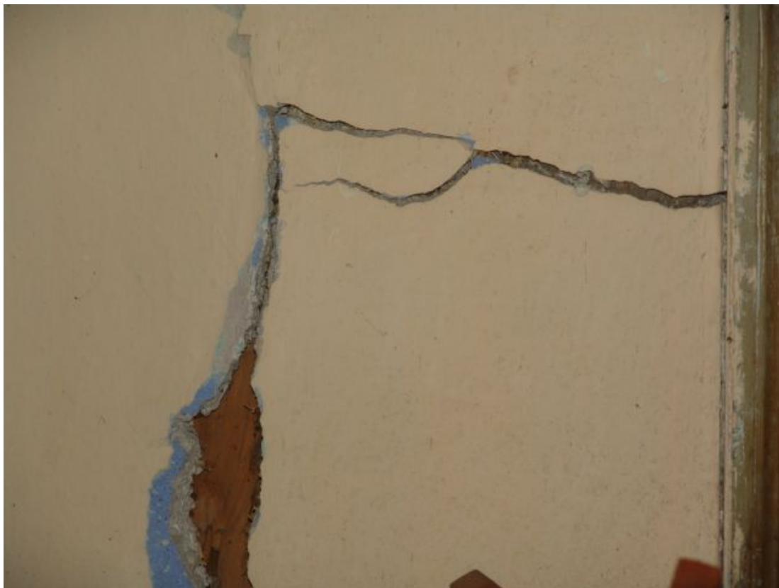
Φ97. Αποδιοργάνωση της τοιχοποιίας από αποτολιθοδομή στο ισόγειο. Διακρίνεται κάτω από το επίχρισμα ο ενσωματωμένος στην τοιχοποιία ξύλινος ορθοστάτης.
