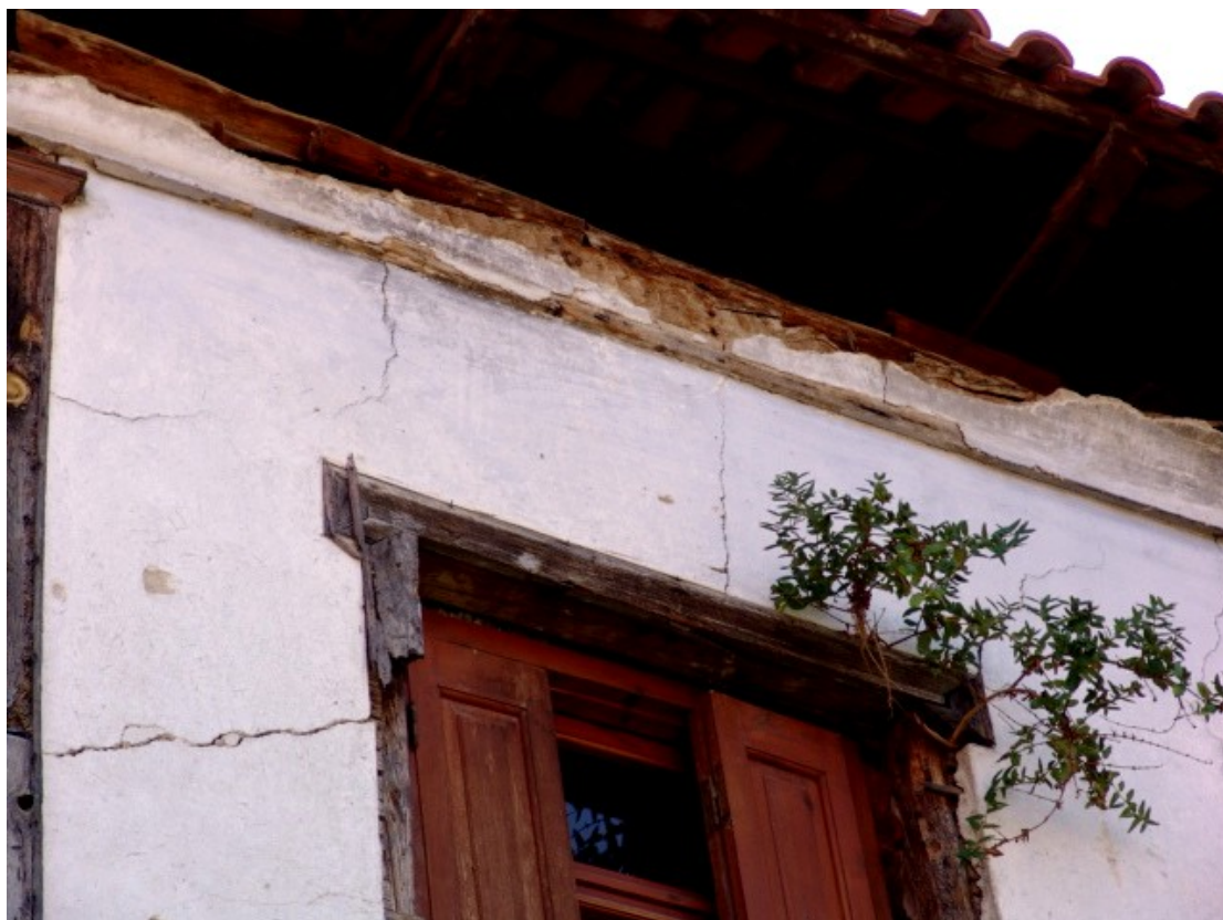
Φ82. Πολύμορφες ρηγματώσεις στην ξύλινη τοιχοποιία και κατεστραμμένη κορνίζα.
