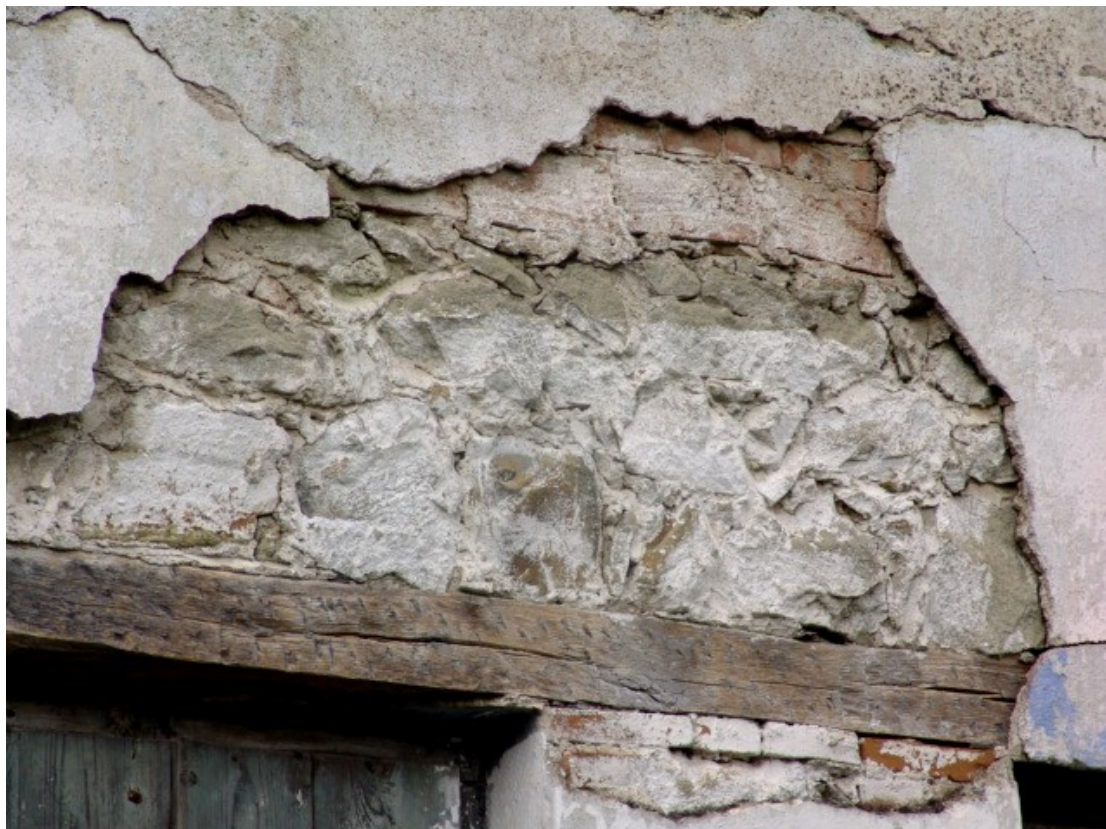
Φ72. Λεπτομέρεια στη λιθοδομή ισόγειου(οριζόντιες ρηγματώσεις-αποκόλληση επιχρισμάτων).
