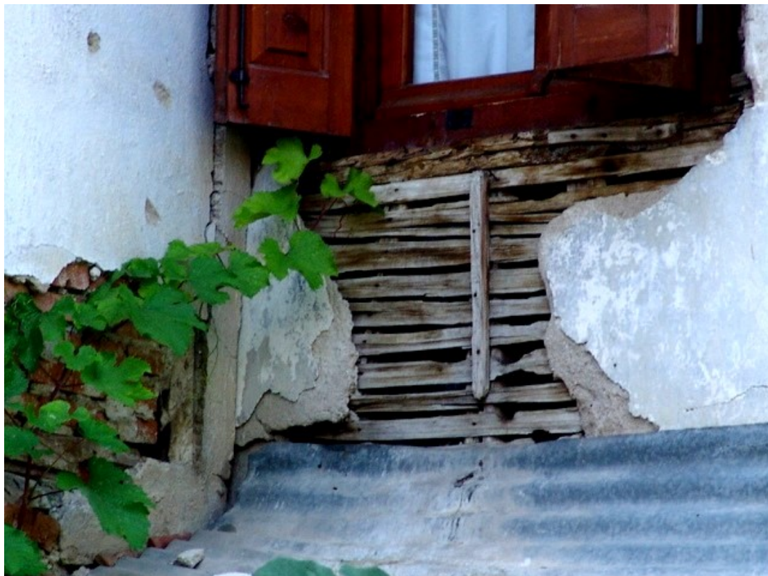
Φ69. Λεπτομέρεια στην τοιχοποιία ορόφου (αποδιοργάνωση της ξύλινης ξυλόπηκτης κατασκευής και των επιχρισμάτων).
