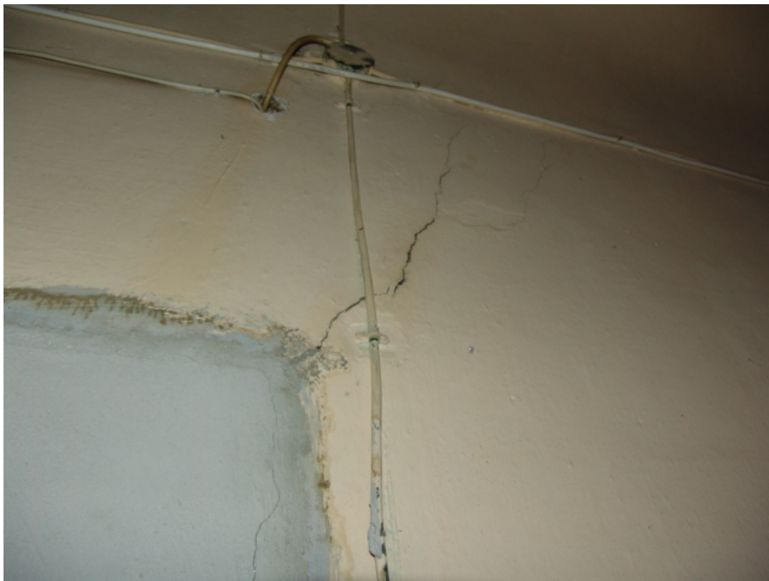
Φ115. Ρηγμάτωση ξύλινης τοιχοποιίας.
