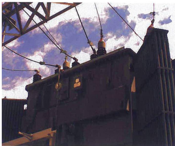
Εικόνα 6.31 Μετασχηματιστής 23kV. Πηγή εικόνας: ITC USA
