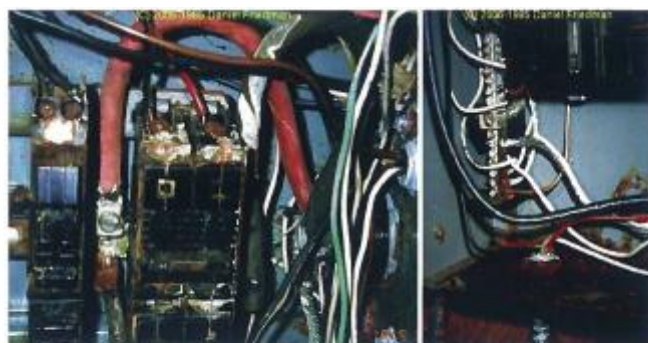
Εικόνα 3.8 Διάβρωση σε διακόπτη επαφής και γειώμενο δίαυλο
