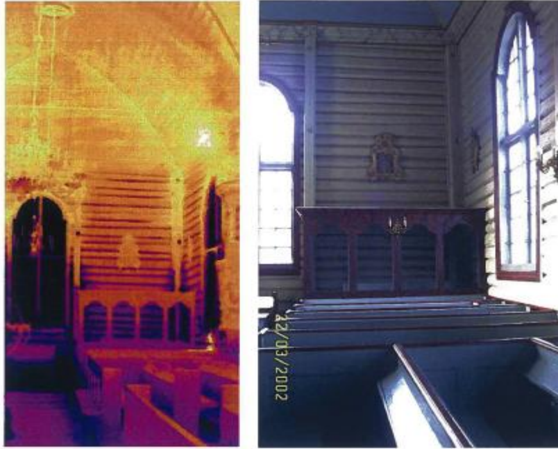
Εικόνα 4.25 Θερμογραφία και ορατή εικόνα του εσωτερικού μιας εκκλησίας. Πίστωση Θερμογραφίας και ορατης εικόνας Karl Grimnes - Termografi og Maleteknik.
