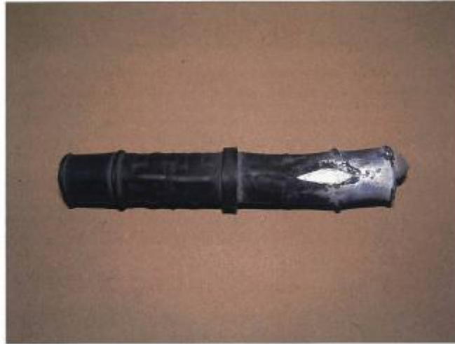
Εικόνα 3.9 Ελαττωματική χάλκινη/ αλουμιένια πτυχωτή άρθρωση λόγω γαλβανικής (διμεταλλικής) διάβρωσης
