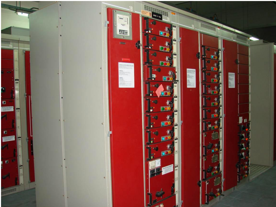
Εικόνα 16 Πίνακας Χαμηλής Τάσης MCC, 400 V
