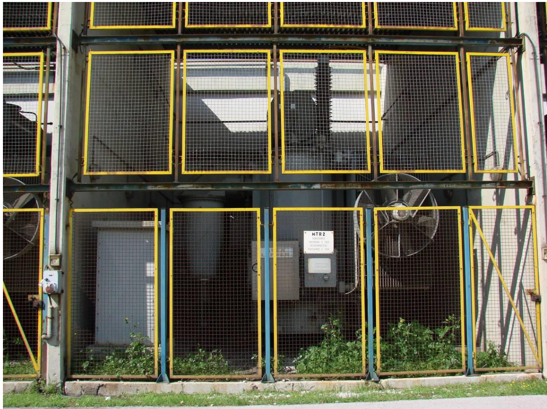
Εικόνα 10. Μετασηματιστής τάσης 150 KV/ 6 KV, R-7000, 24/30 MVA
