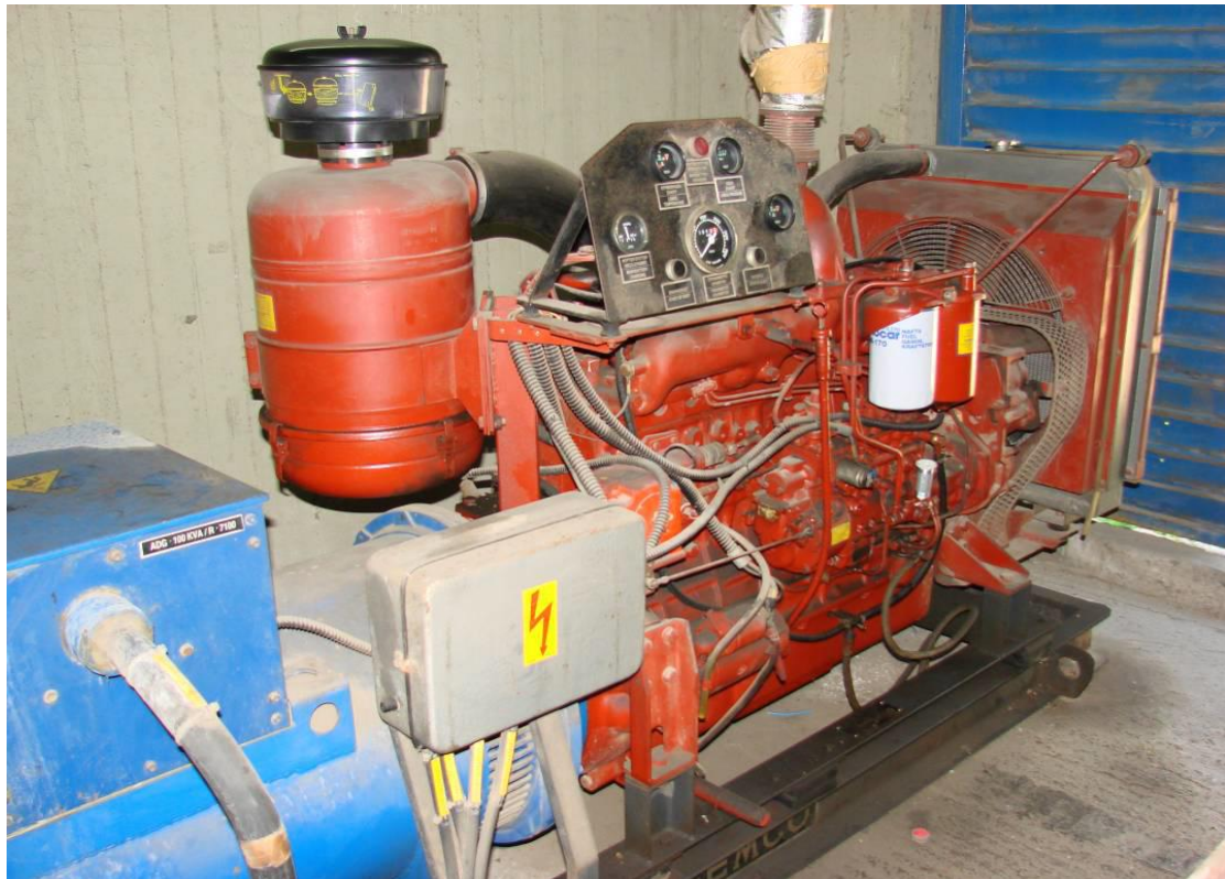
Εικόνα 22 Γεννήτρια Εκτάκτου Ανάγκης (Emergency Diesel Generator, EDG)
