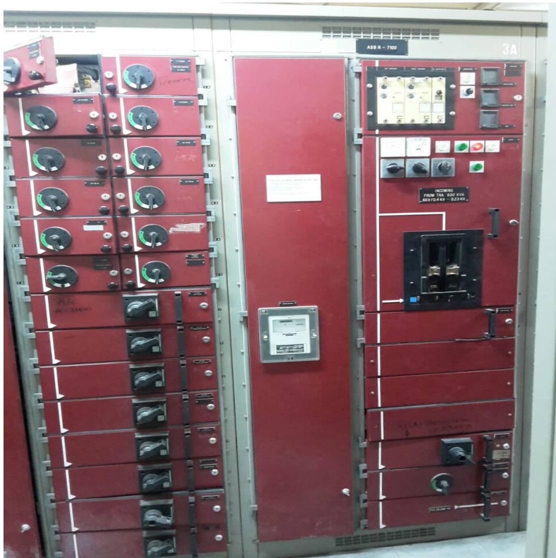
Εικόνα 17 Πίνακας ASB (Auxiliary Service Board)
