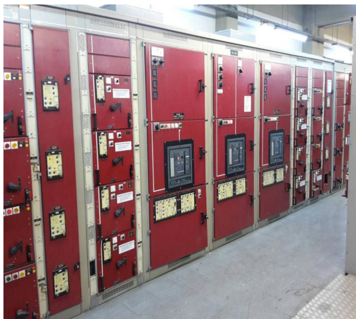
Εικόνα 15 Πίνακας Χαμηλής Τάσης PCC,400V.
