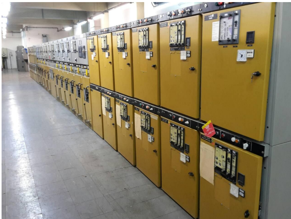
Εικόνα 14 Πίνακες Μέσης Τάσης. 6 KV
