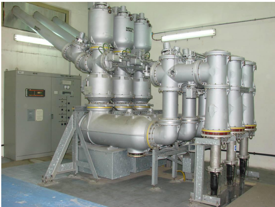
Εικόνα 4 Υποσταθμός R-7001, Υψηλή Τάση 150 KV
