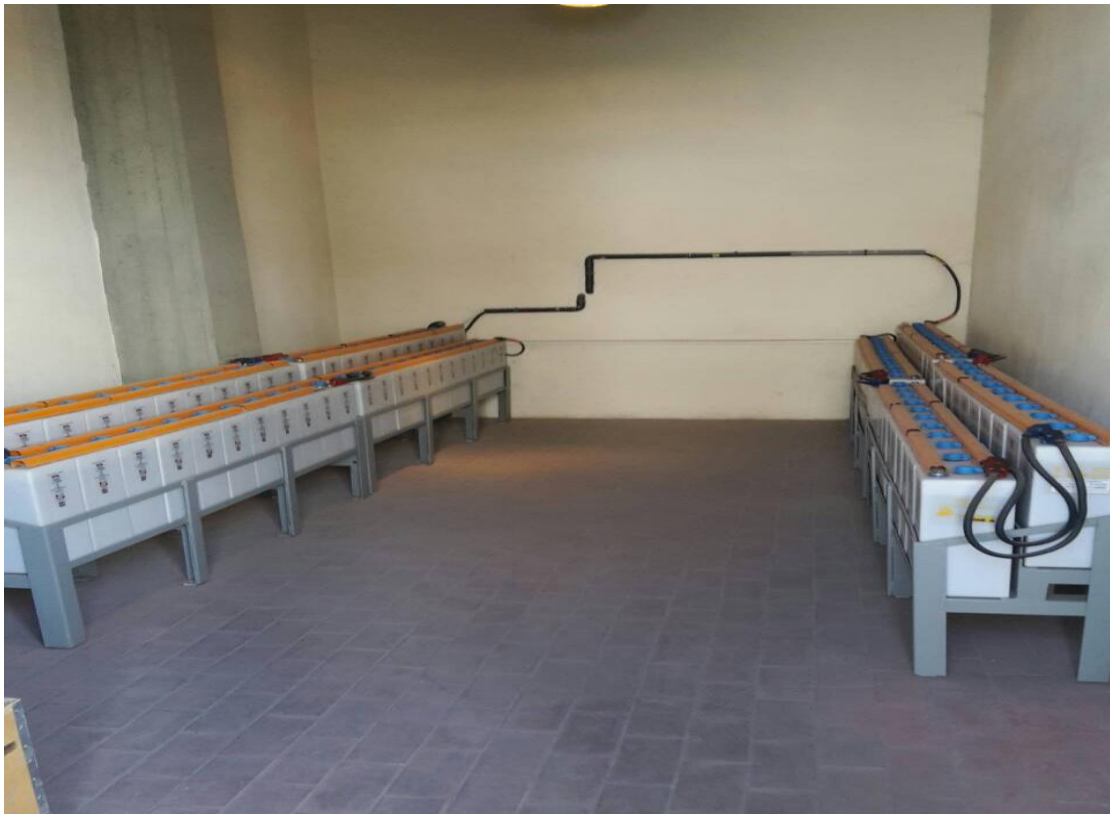
Εικόνα 19 Χώρος Συσσωρευτών Ni-Cd, Υποσταθμού (Battery Room)
