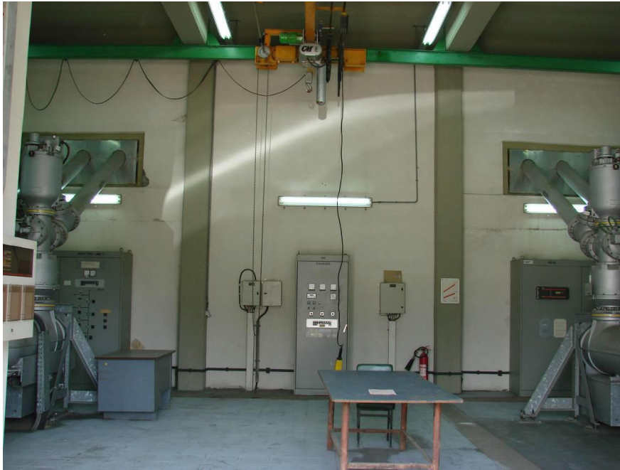
Εικόνα 3 Εσωτερική όψη υποσταθμού R-7001
