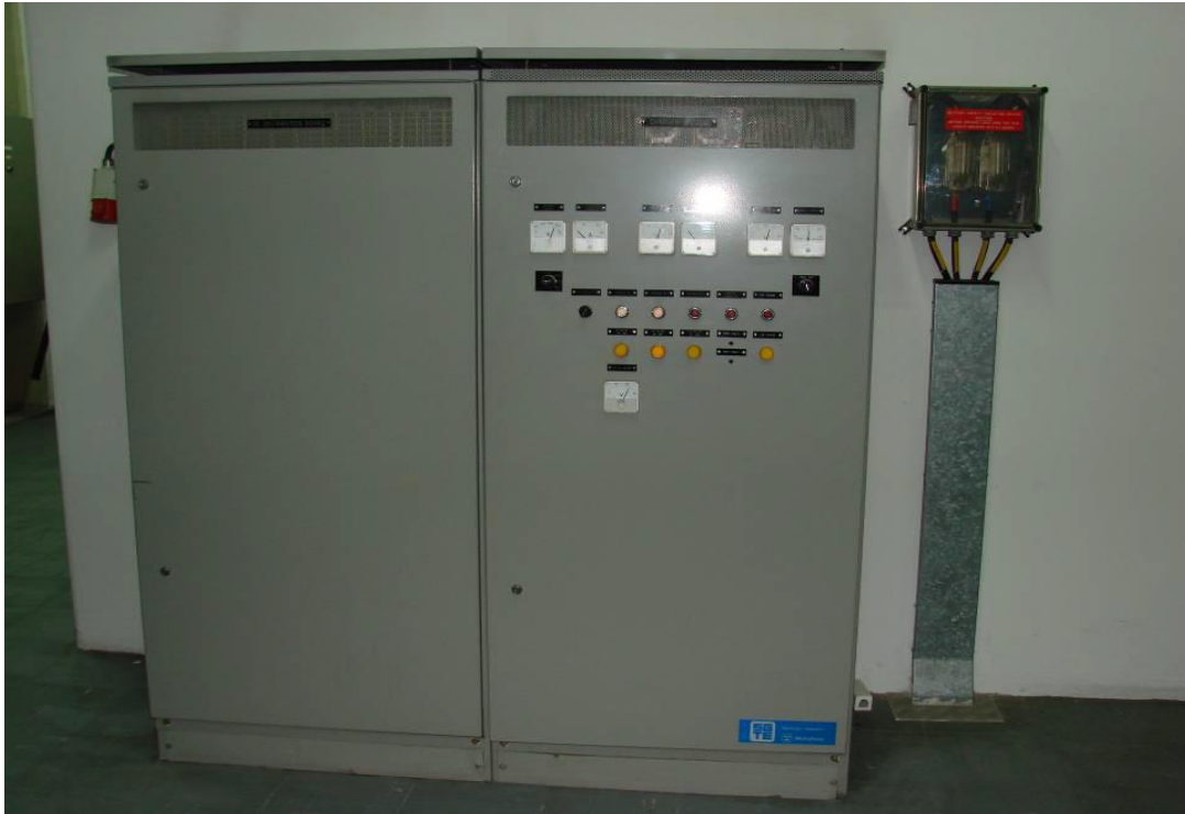
Εικόνα 20 Φορτιστής Συσσωρευτών - Battery charger
