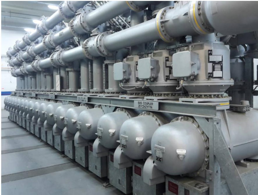
Εικόνα 9 Διακόπτες ζεύξης ζυγών Υψηλή Τάση, 150 KV
