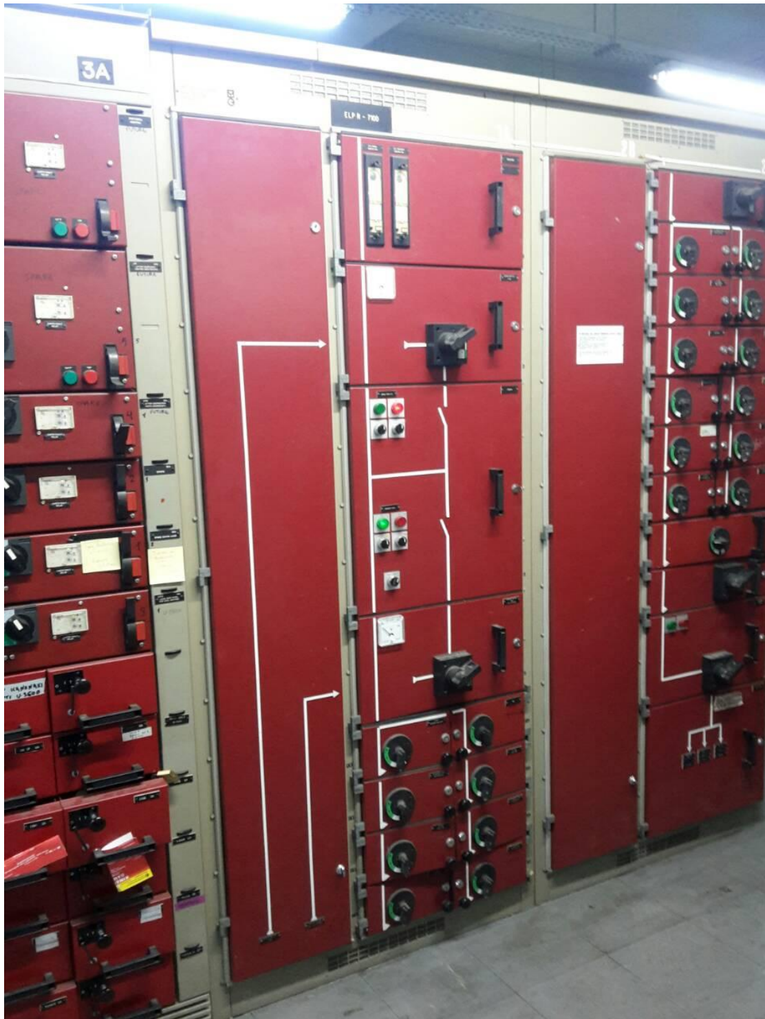
Εικόνα 18 Πίνακας ELP (Emergency Lighting Panel)
