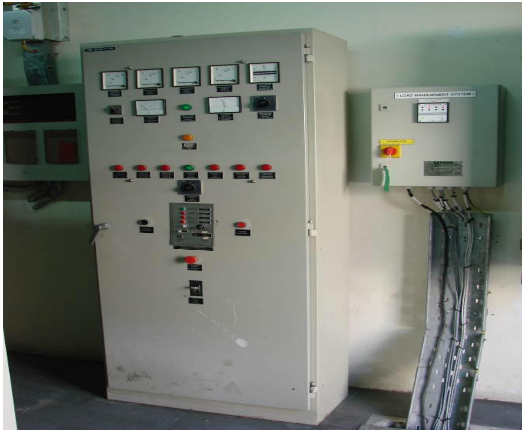
Εικόνα 23 Πίνακας Γεννήτριας Εκτάκτου Ανάγκης (EDG Panel)
