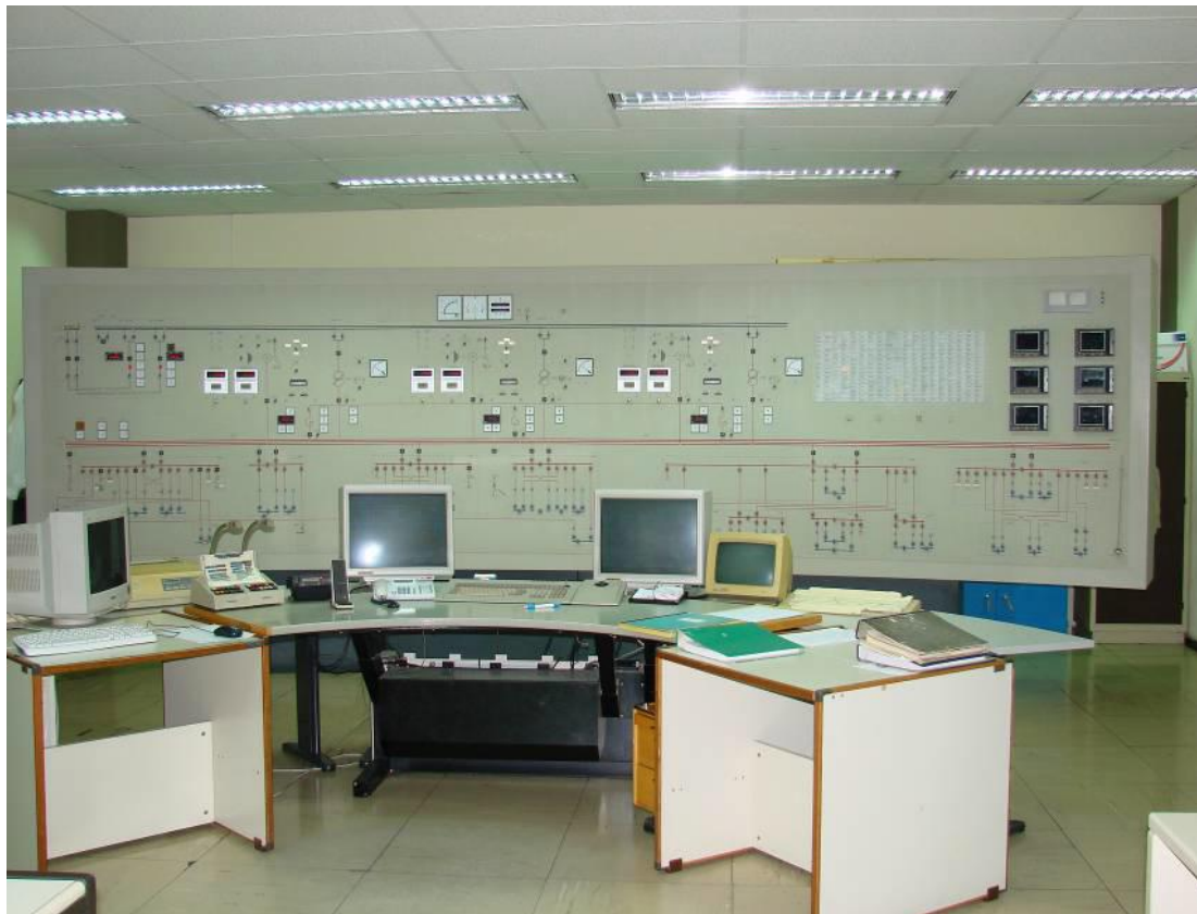
Εικόνα 19 Αίθουσα Ελέγχου & Παρακολούθησης Ηλεκτρικού Δικτύου (Main Electrical Control Room/LSS)
