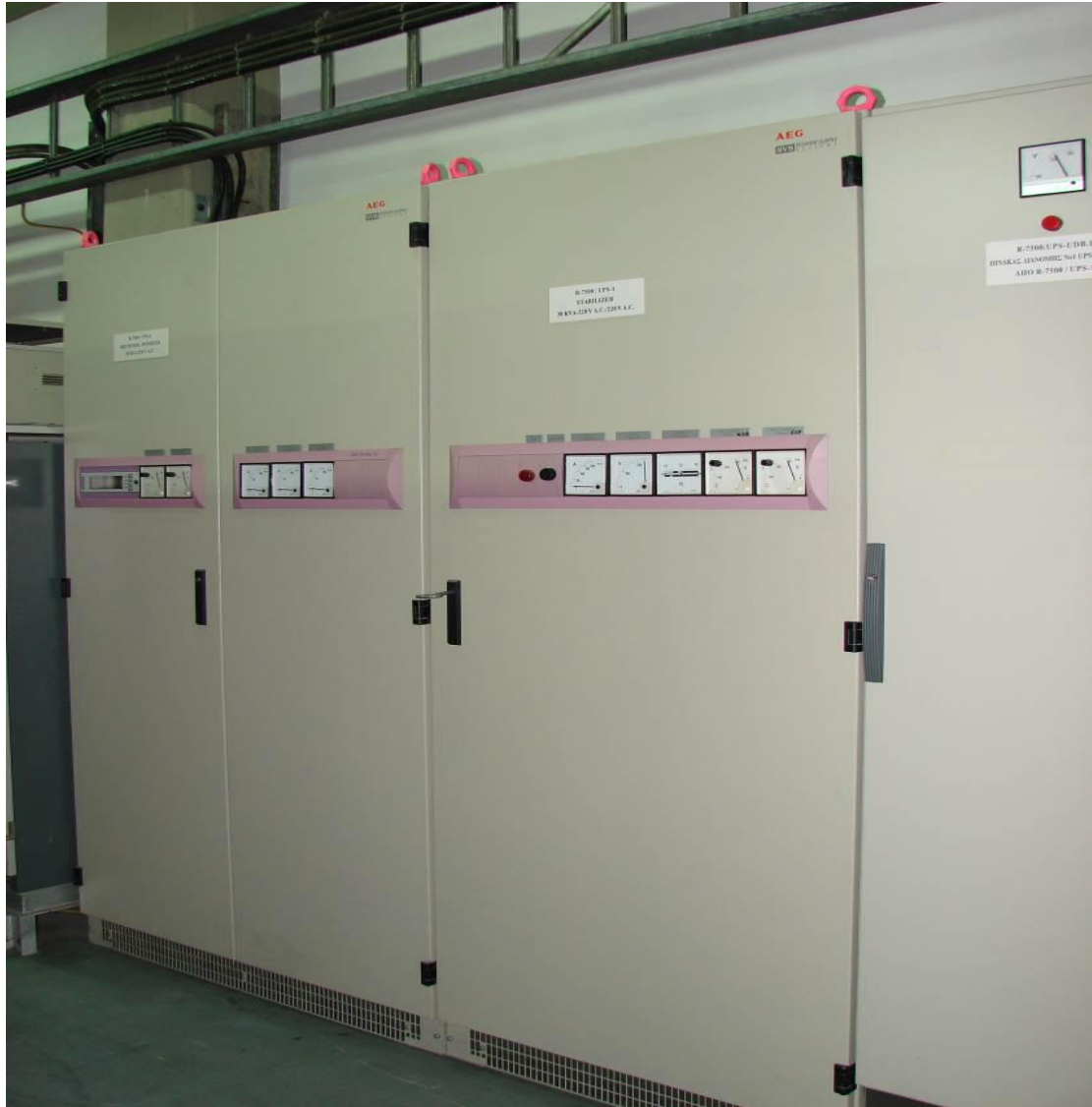
Εικόνα 22 Σύστημα Αδιάλειπτης Παροχής Ισχύος (UPS)
