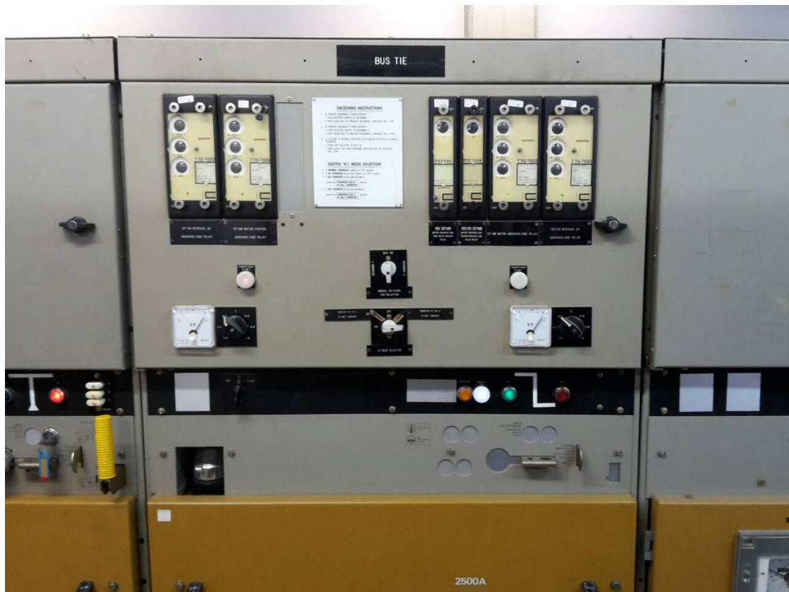
Εικόνα 12 Διακόπτης Bus Tie
