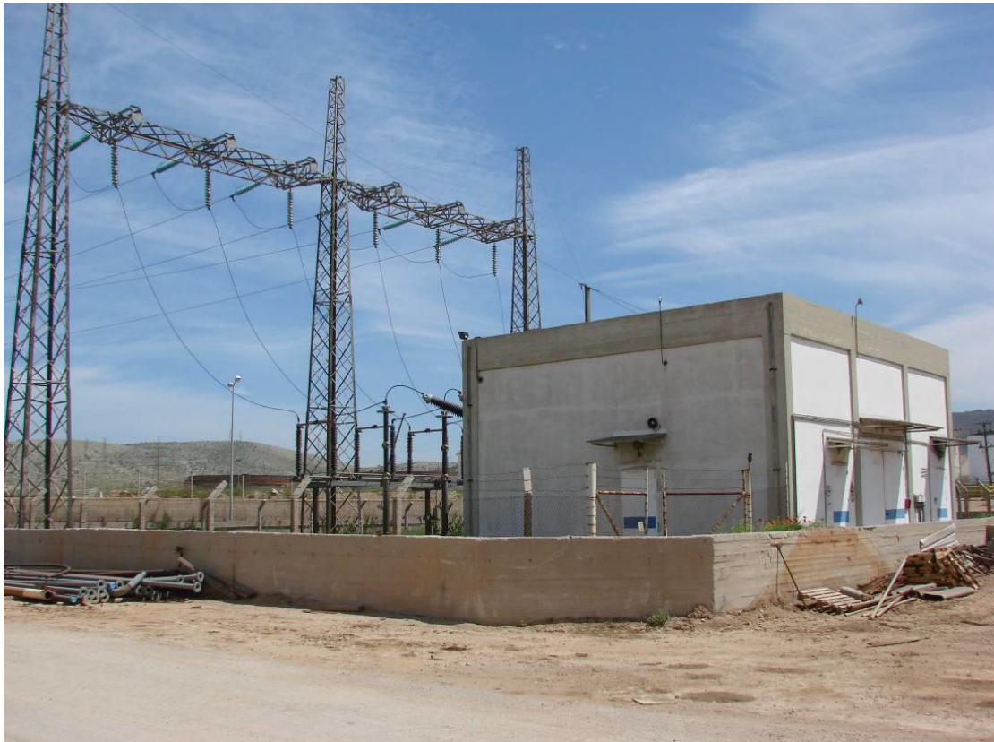
Εικόνα 2 Είσοδος από Δ.Ε.Η υποσταθμός R-7001
