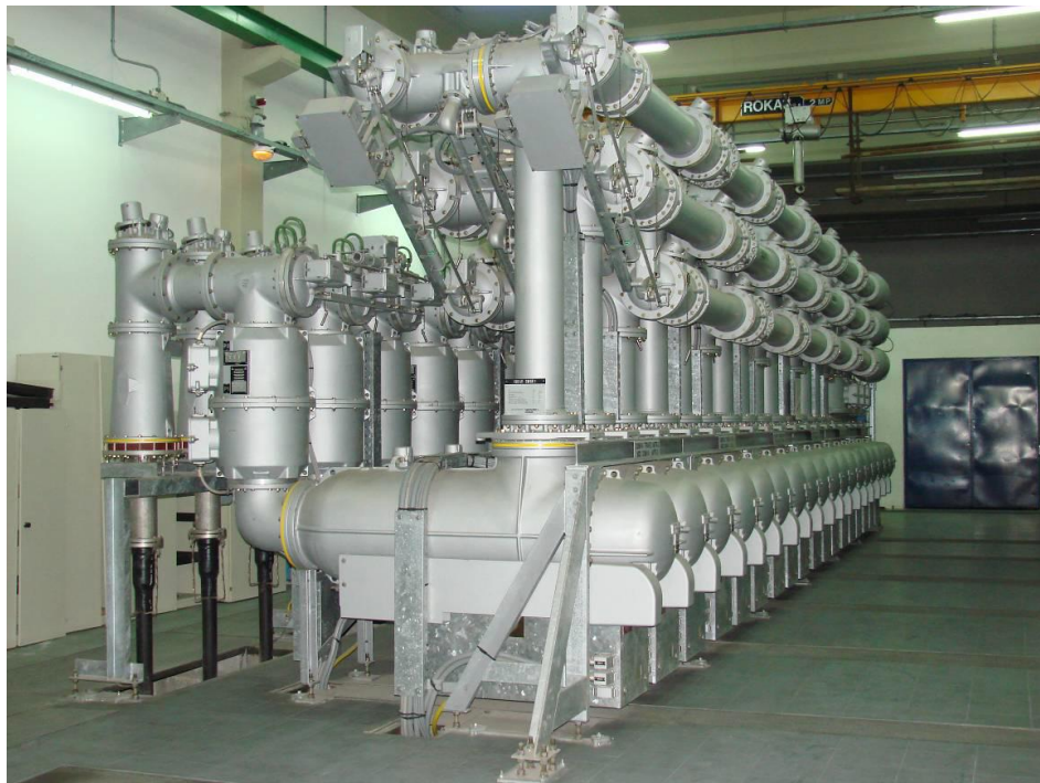
Εικόνα 8 Εσωτερική όψη R-7000, Υψηλή Τάση, 150 KV
