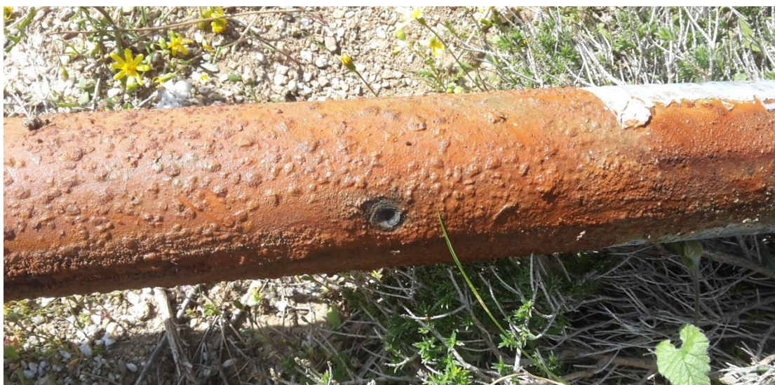
Σχήμα 10.4 : Ηλεκτρόλυση κατά μήκος όλου του σωλήνα.
