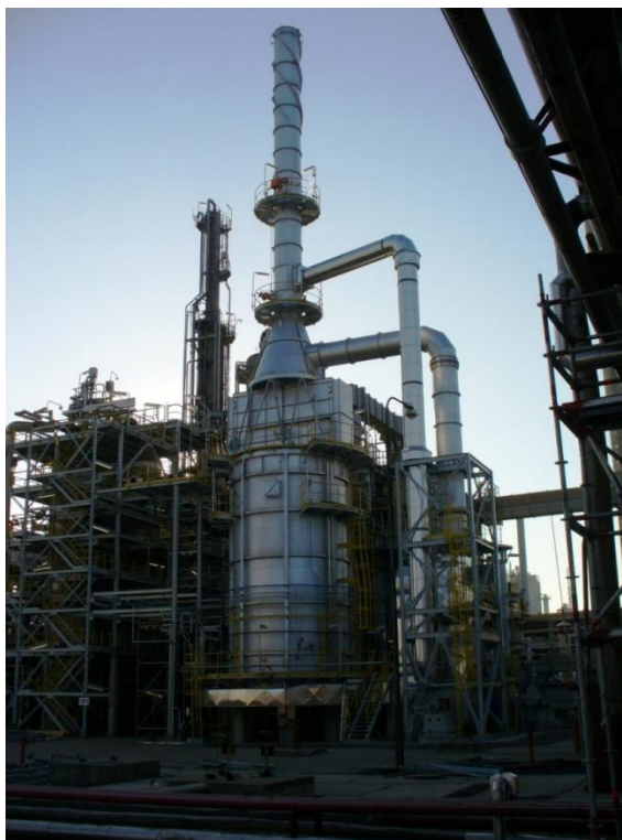
Εικόνα 3.10 Φούρνος θέρμανσης [xii]
