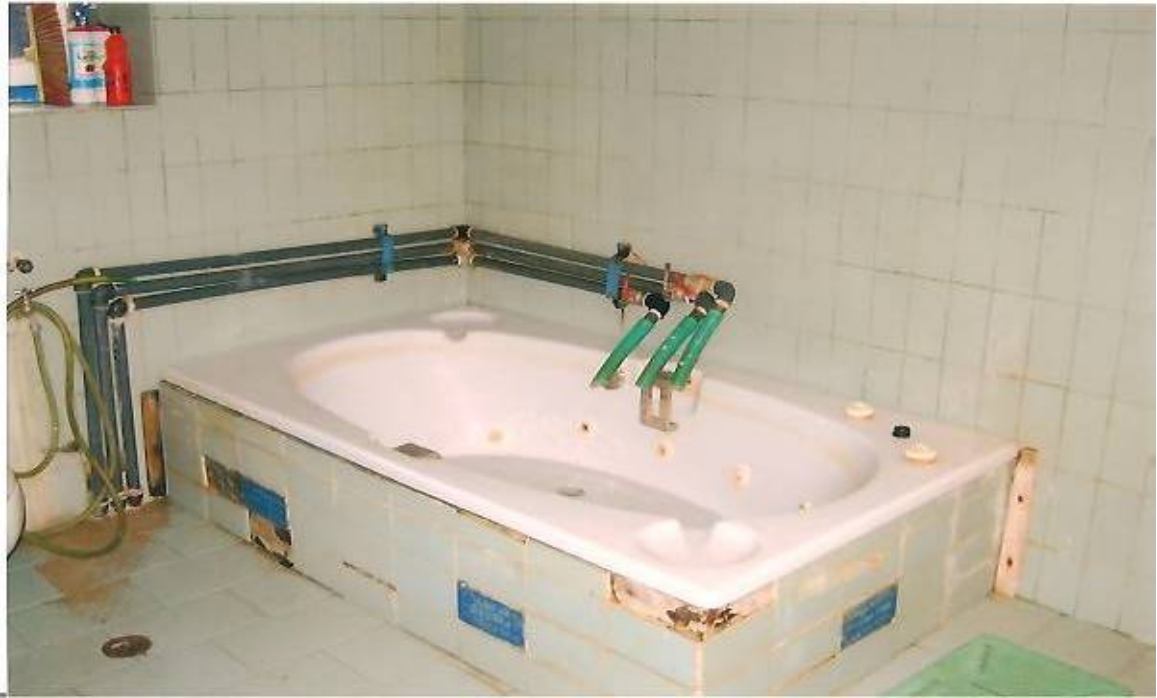
Η άσχημη κατάσταση του υδρομασάζ Φωτογραφία 6.8
