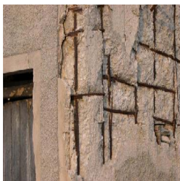
•Εικόνα 28•Διάβρωση χάλυβα
