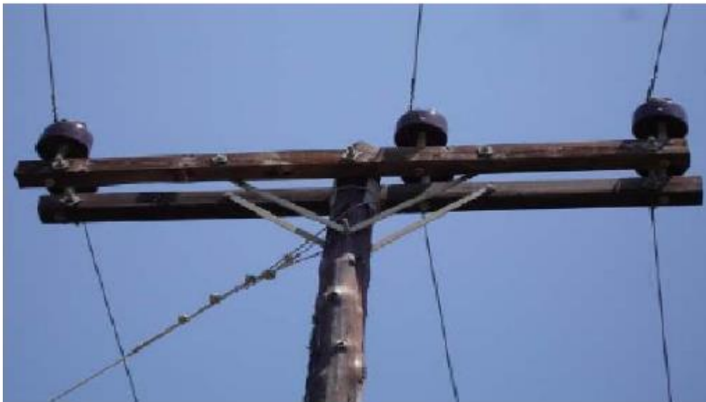
Εικόνα 9 Τυπική διάταξη μέσης τάσης επί ξύλινου στύλου
