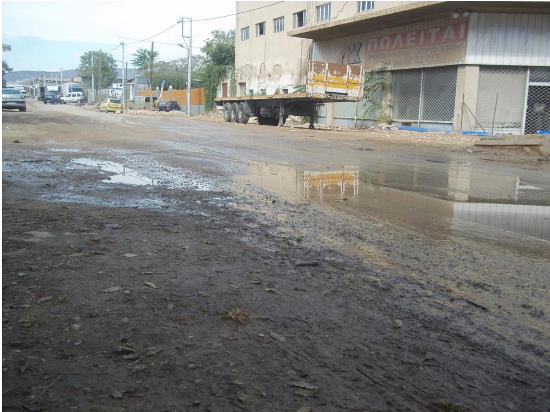
Εικόνα 32 Οι κακοτεχνίες σε όλο το οδικό δίκτυο της περιοχής, σε συνάρτηση με την διέλευση βαρέων οχημάτων έχουν καταστρέψει το οδόστρωμα
