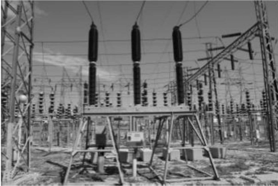
Φωτογραφία 2.3: Διακόπτες SF6 (Πηγή Δ.Ε.Η. Α.Ε.)
