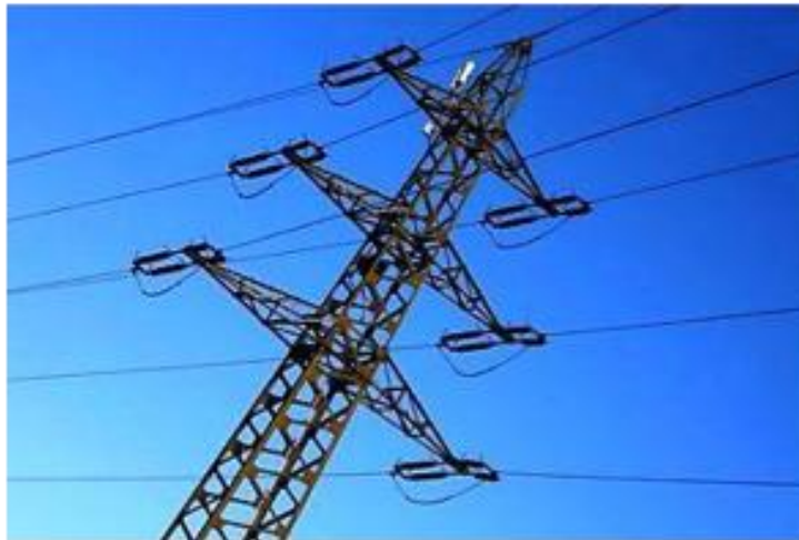
Φωτογραφία 1.3: Υποσταθμός ΔΕΗ
