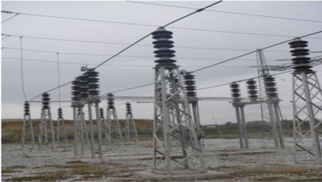
Φωτογραφία 3.4: Αποζεύκτες και γειωτές Υποσταθμού [1]
