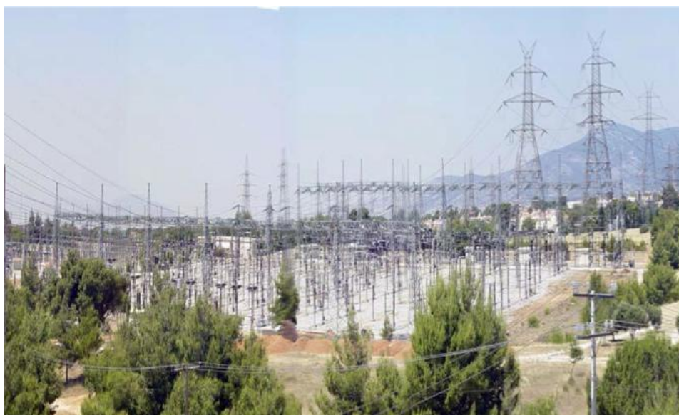
Φωτογραφία 1.6: Κέντρο Υπερυψηλής Τάσης Λάρισας (Πηγή Δ.Ε.Η. Α.Ε.)
