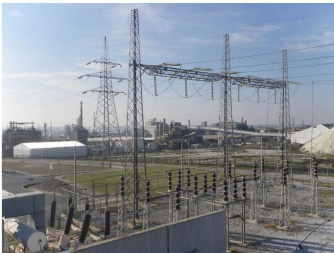
Φωτογραφία 3.3: Υπαίθριος Υποσταθμός 150kV Βιομηχανικής Μονάδας Πολυπροπυλενίου [1]
