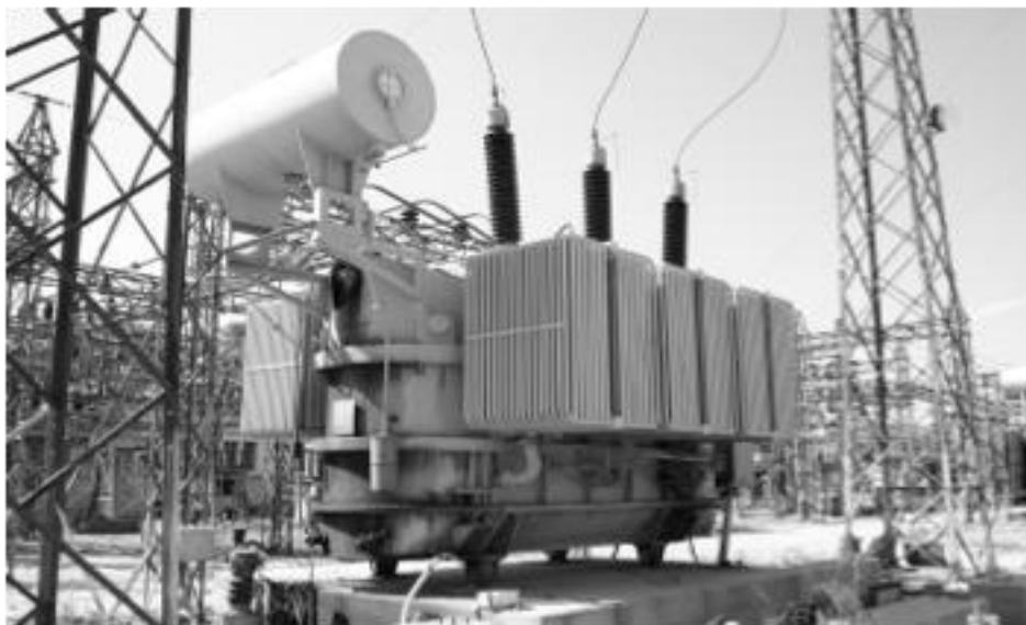
Φωτογραφία 2.1: Μετασχηματιστής με μονωτικά λάδια [ΔΕΗ Α.Ε]
