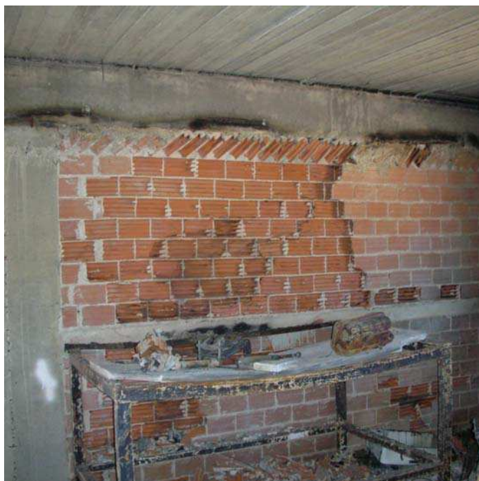
Αποφλοίωση τοίχων πλήρωσης, αποσύνθεση κονιάματος, ρηγμάτωση.
