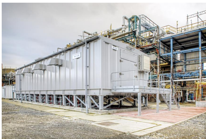
Σχήμα 2.12 - Υποσταθμός διανομής MT/XT
