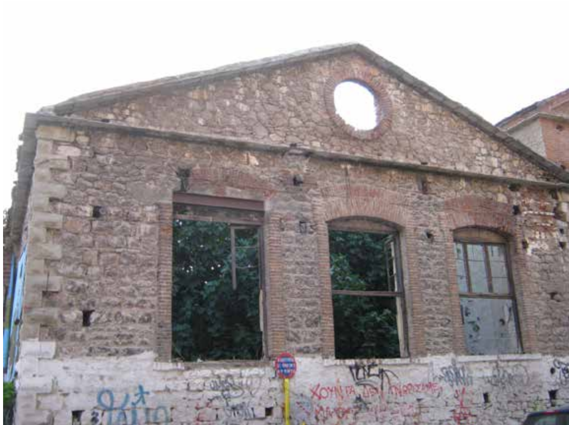
Εικόνα 22: Ανατολική όψη στην οποία μπορούμε να δούμε την λιθοδομή, τα ανοίγματα, την επισκευή ενός πρέκι, την κλίση της στέγης και το φεγγίτης.
