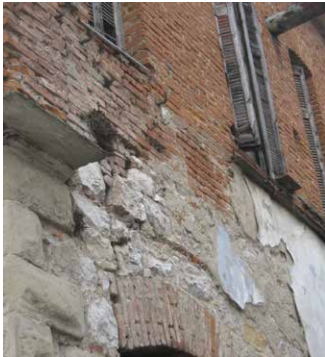
Εικόνα 3: Άποψη δυτικής όψης όπου φαίνονται τα δομικά υλικά της φέρουσας τοιχοποιίας και οι εναλλαγές τους. Ακόμα, βλέπουμε τα αγκωνάρια, τη γεφυροποίηση του πρεκιού αλλά και την τοποθέτηση μαρμάρου στην ποδιά των ανοιγμάτων.
