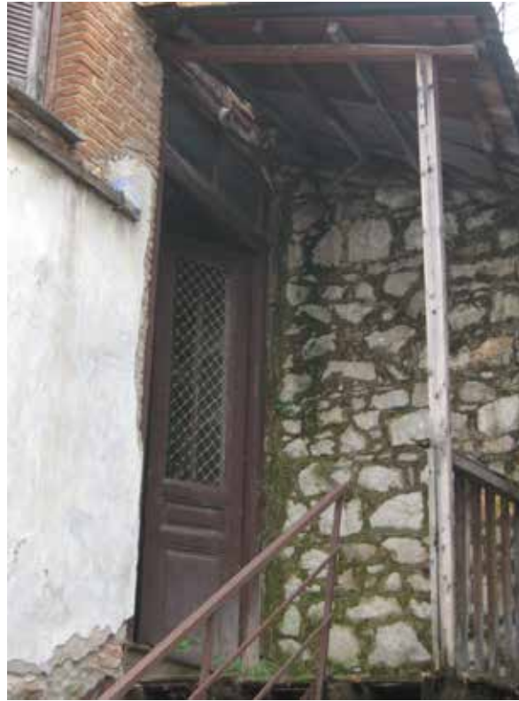
Εικόνα 4: Άποψη δυτικής όψης στην οποία φαίνεται η πόρτα που συνδέει το ισόγειο με τον όροφο μέσω της μεταλλικής σκάλας.
