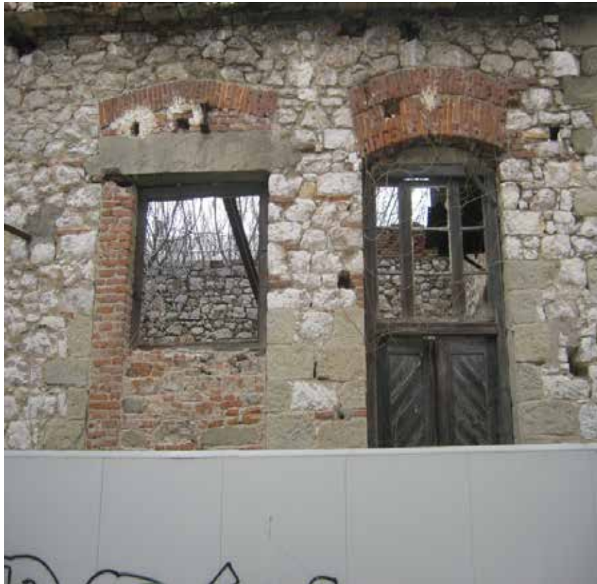
Εικόνα 23: Ανοίγματα δυτικής όψης όπου φαίνεται η επισκευή τους αλλά και η αλλαγή στο ύψος του πρεκιού.
