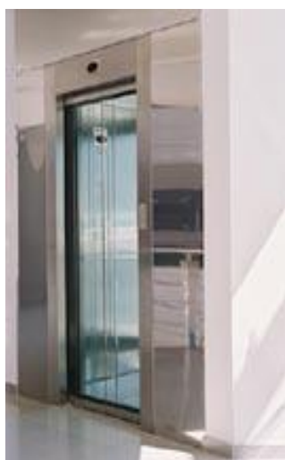
Εικόνα 6.6 Αυτόματη θύρα φρέατος (Πηγή: Metron)
