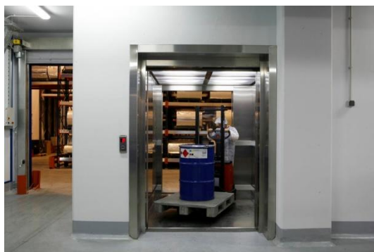
Εικόνα 3.3 Ανελκυστήρας μεγάλων φορτίων, (Πηγή: Kleemann Ελλάς ABEE)
