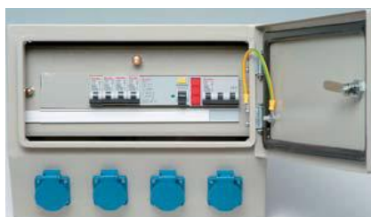
Εικόνα 12.5 Πίνακας κίνησης και φωτισμού. (Πηγή: Γκολώνης Χρ.)
