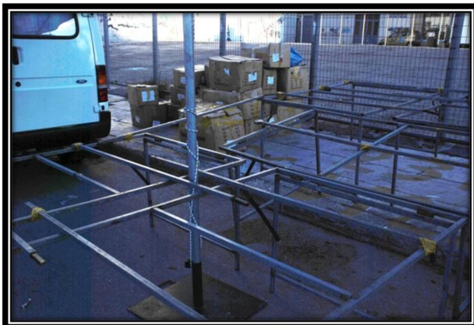
Εικ.2.30. : Οι μεταλλικές βάσεις κατά το στήσιμο των πάγκων. ΠΗΓΗ : προσωπικό αρχείο.
