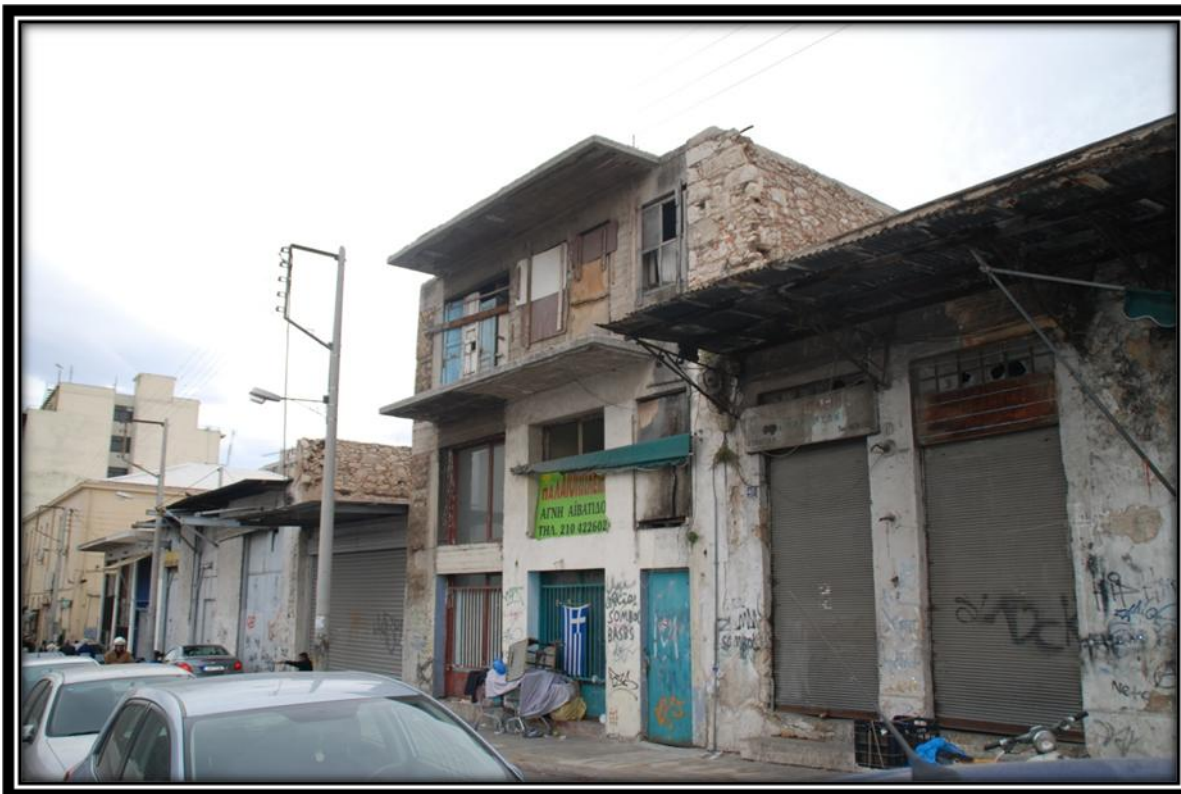
Εικ. 2.17. : Το 2όροφο κτίριο στο κέντρο της εικόνας είναι πλινθόκτιστο με μεταγενέστερες προσθήκες προβάλων με πιθανή ηλικία 60-80 ετών, σε κακή κατάσταση λόγω παλαιότητας . Στο
