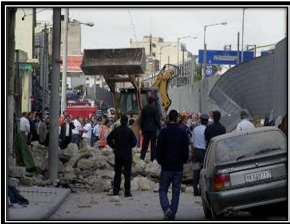
Εικ. 2.3. : Φωτογραφία την ημέρα της κατάρρευσης. ΠΗΓΗ : εφημερίδα «ΡΙΖΟΣΠΑΣΤΗΣ», σελ 29, Πέμπτη 13 Οκτώβρη 2005.
