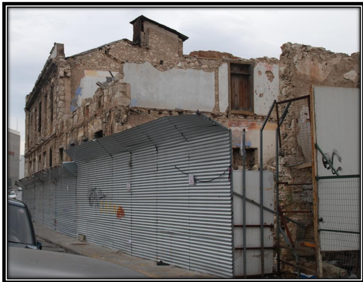
Εικ. 2.26. : Εγκαταλελειμμένο κτίριο κτισμένο στις αρχές του αιώνα, πλινθόκτιστο και υπό κατάρρευση (σχολαρχείο «Ξούρα»)· Κυματιστές λαμαρίνες έχουν
