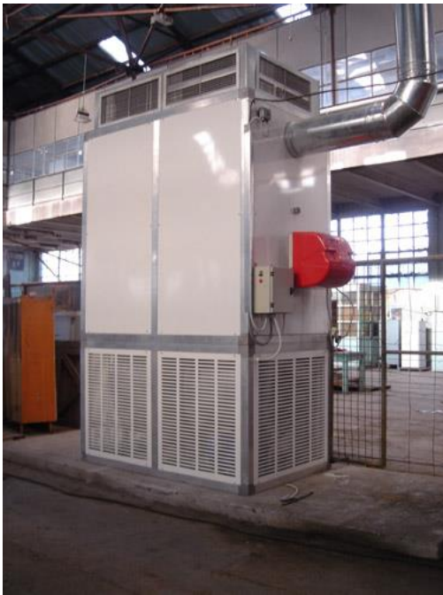
α) Αερολέβητας αερίου
