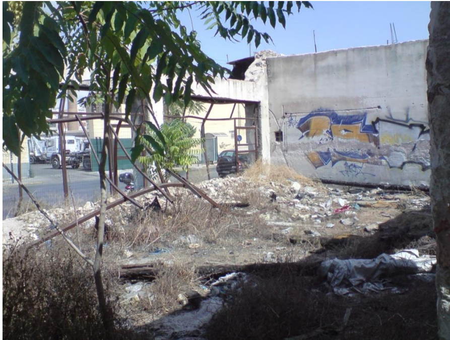
Εικόνα 5.18: Το καταστρεμμένο νότιο τμήμα του κτιρίου Δ4
