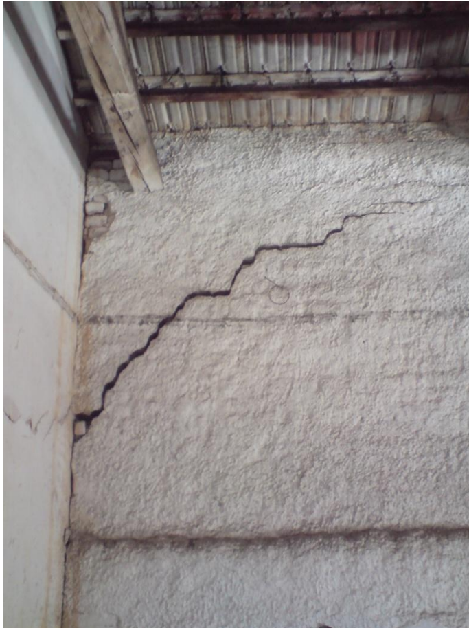
Εικόνα 5.24: Ρηγματώσεις στη φέρουσα τοιχοποιία.
