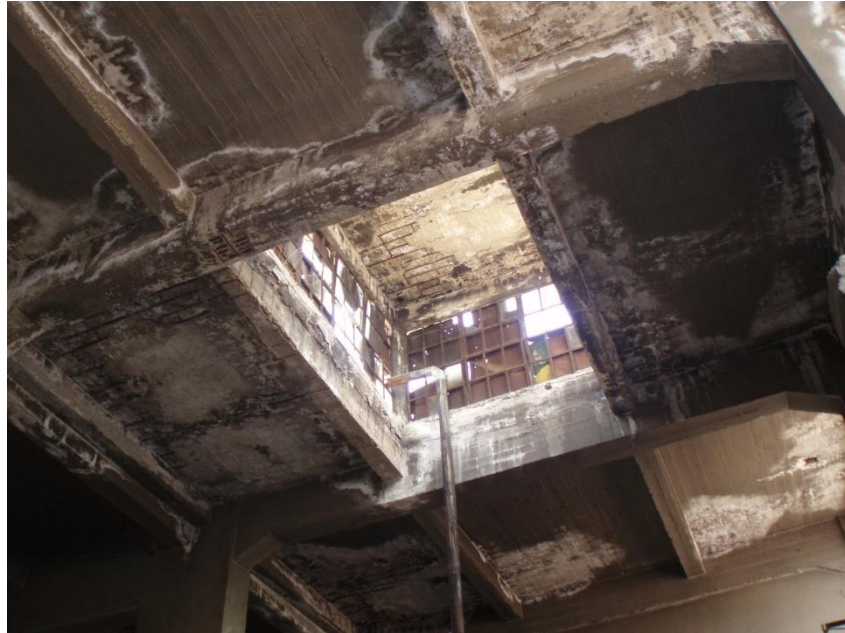
Εικόνα 5.23: Τμήμα της διαβρωμένη πλάκας οροφής
