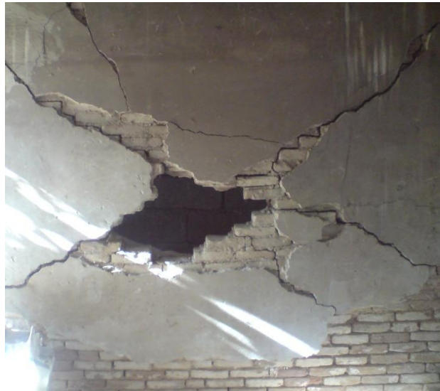
Εικόνα 5.47: Τοίχος υπό κατάρρευση
