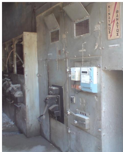
Εικόνα 5.12: Το εσωτερικό του υποσταθμού.
