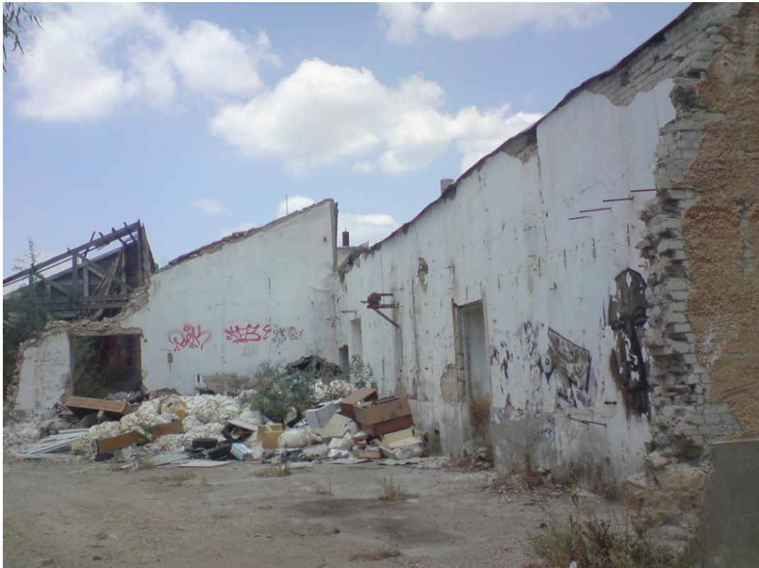
Εικόνα 5.10: Τμήμα Γ7 του παλιού υφαντουργείου. Στο βάθος φαίνεται το Τμήμα Γ6 που είναι υπό κατάρρευση
