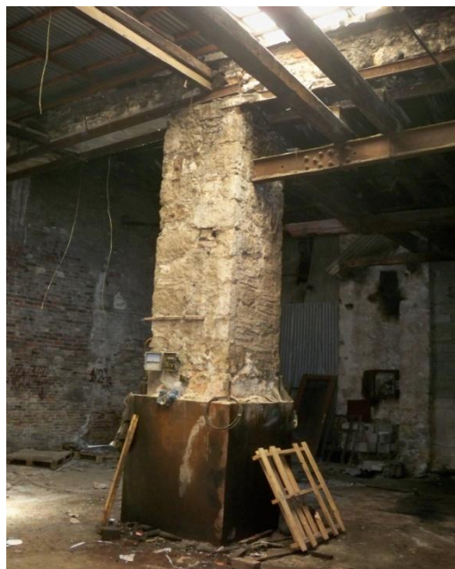
Εικόνα 5.9: Κολώνα με μεταλλική περίσφιξη στο εσωτερικό του κτιρίου A5
