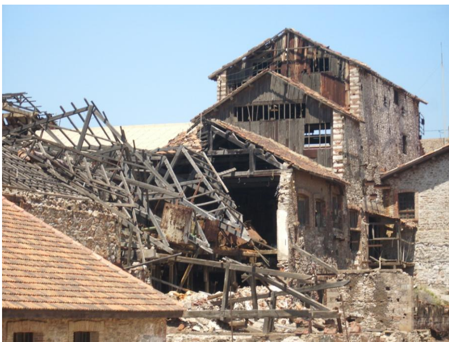
Εικόνα 3.11: Κτίρια που δεν έχουν αποκατασταθεί
