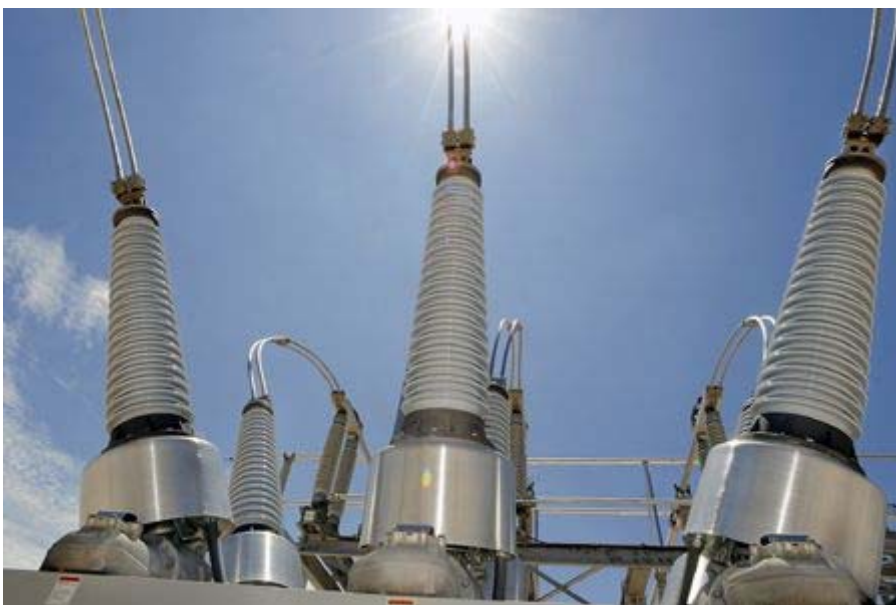
Εικ. 3.9 Μονωτήρες διέλευσης
