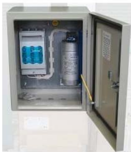
Εικ. 3.11 Κεντρική αντιστάθμιση Υποσταθμού
