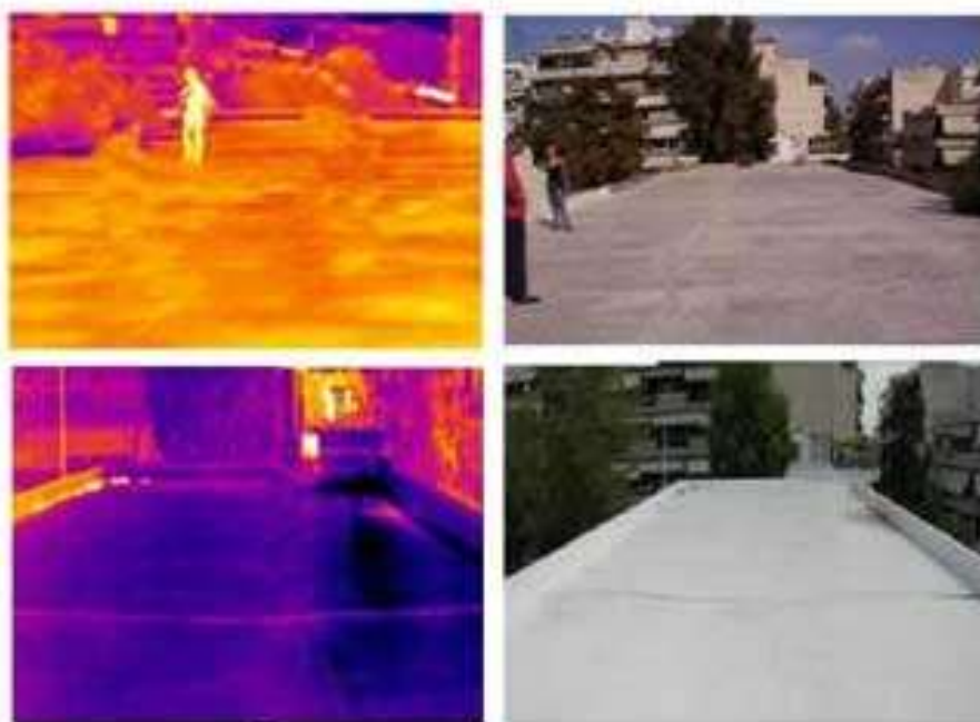
Εικόνα 33 Υπέρυθρη και ορατή απεικόνιση οροφής, που δείχνει τη διαφορά θερμοκρασίας πριν και μετά την εφαρμογή του ψυχρού υλικού
