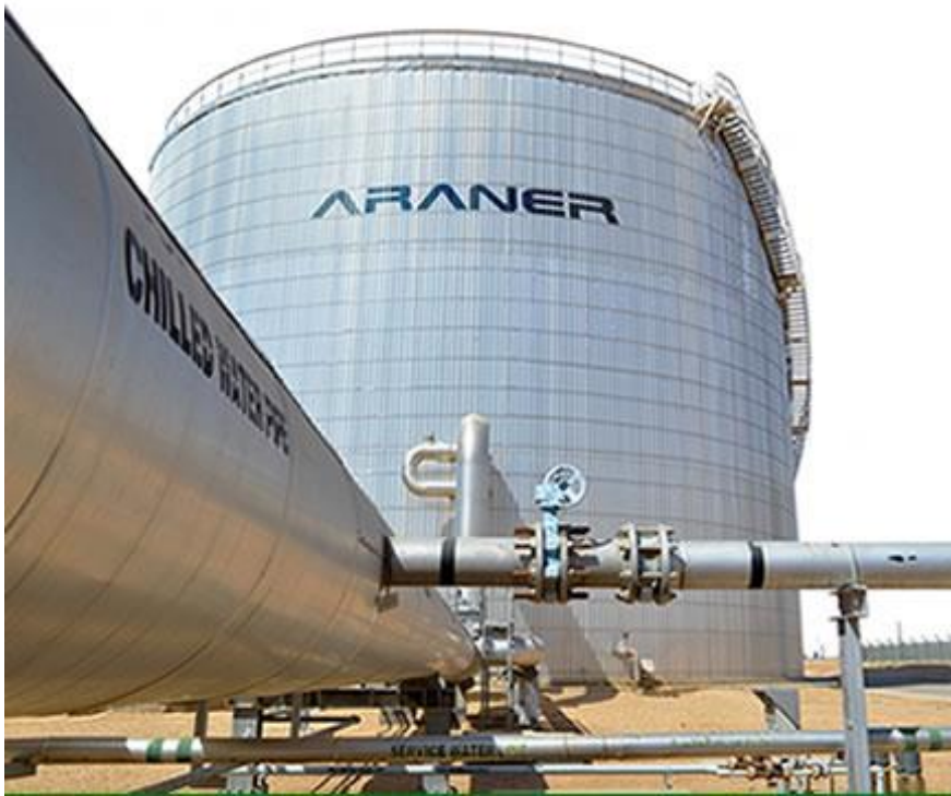
Εικόνα 1.2 Διαστρωματοποιημένη Δεξαμενή Αποθήκευσης Νερού βιομηχανικής κλίμακας ( http://www.araner.com/blog/stratified-thermal-energy-storage-tanks )
