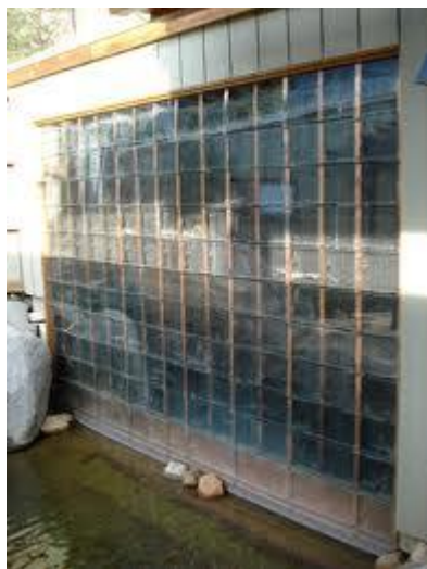
Εικόνα 23: Τοίχος Trombe στην Νεβάδα (www.obermeyer.com)
