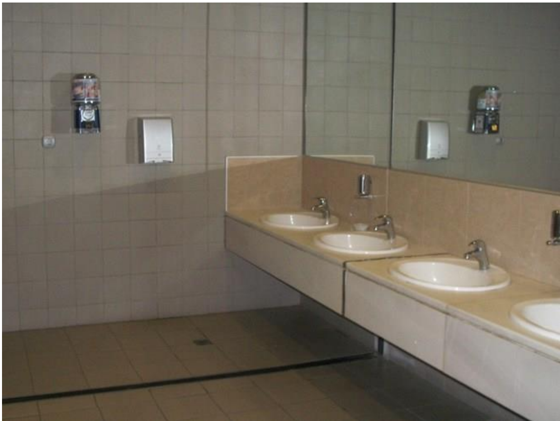
Εικόνα 25 Η πλακόστρωση των χώρων υγιεινής θα γίνει με λευκά πλακάκια διαστάσεων 15*15cm 36
