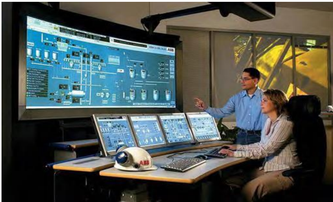
Αίθουσα χειρισμού σταθμών SCADA σε βιομηχανία
