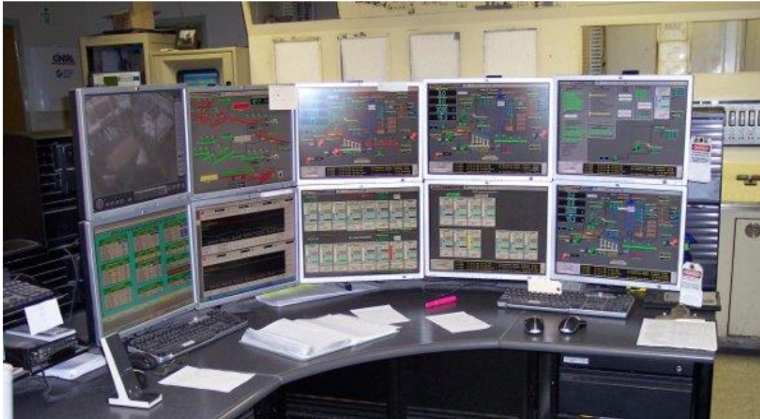
Σύστημα HMI για βιομηχανικό έλεγχο
