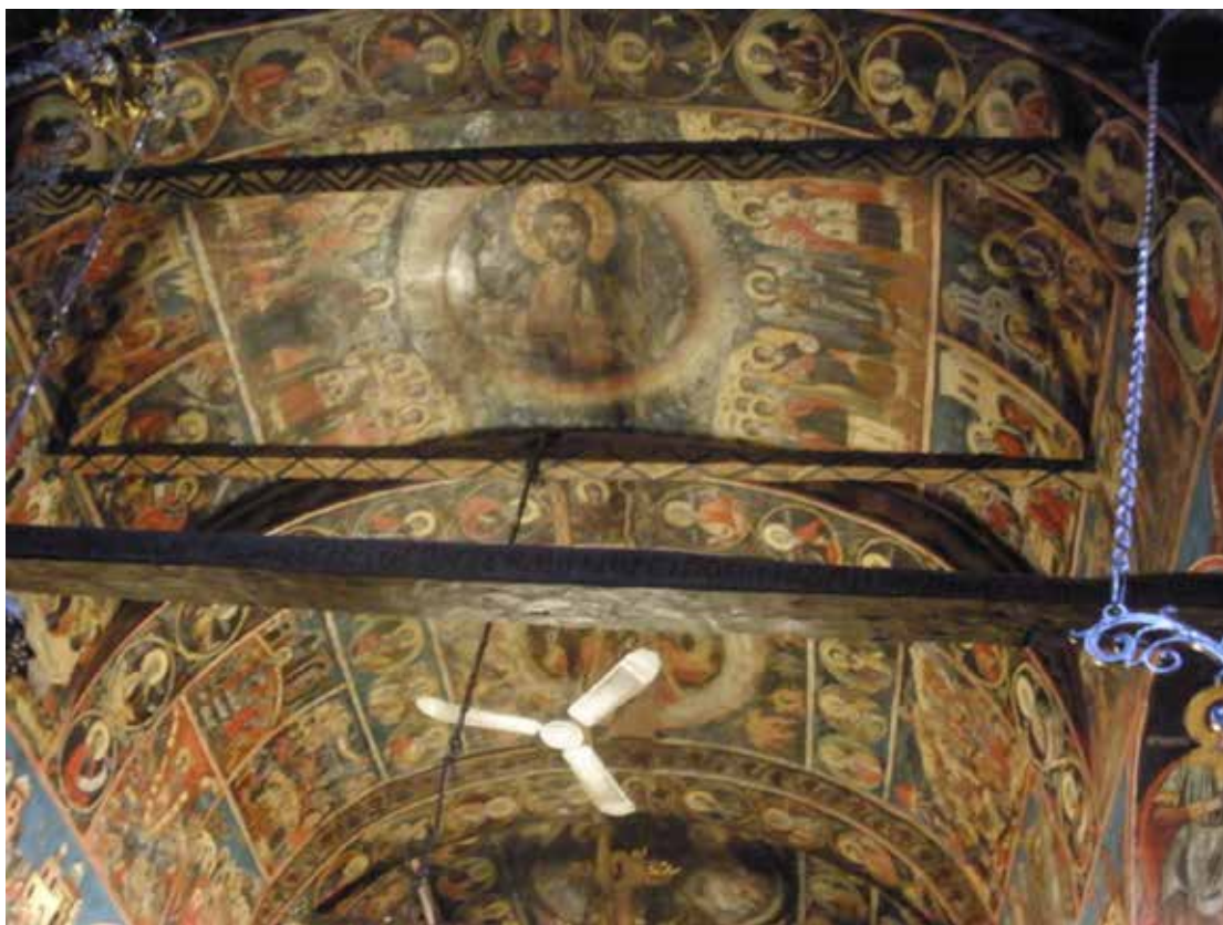
Εικόνα 30 : Ρωγμή στο κεντρικό κλίτος του ναού, από την είσοδο του κυρίως ναού προς το Ιερό Βήμα. Κατά μήκος της αγιογραφίας του Παντοκράτορα.
