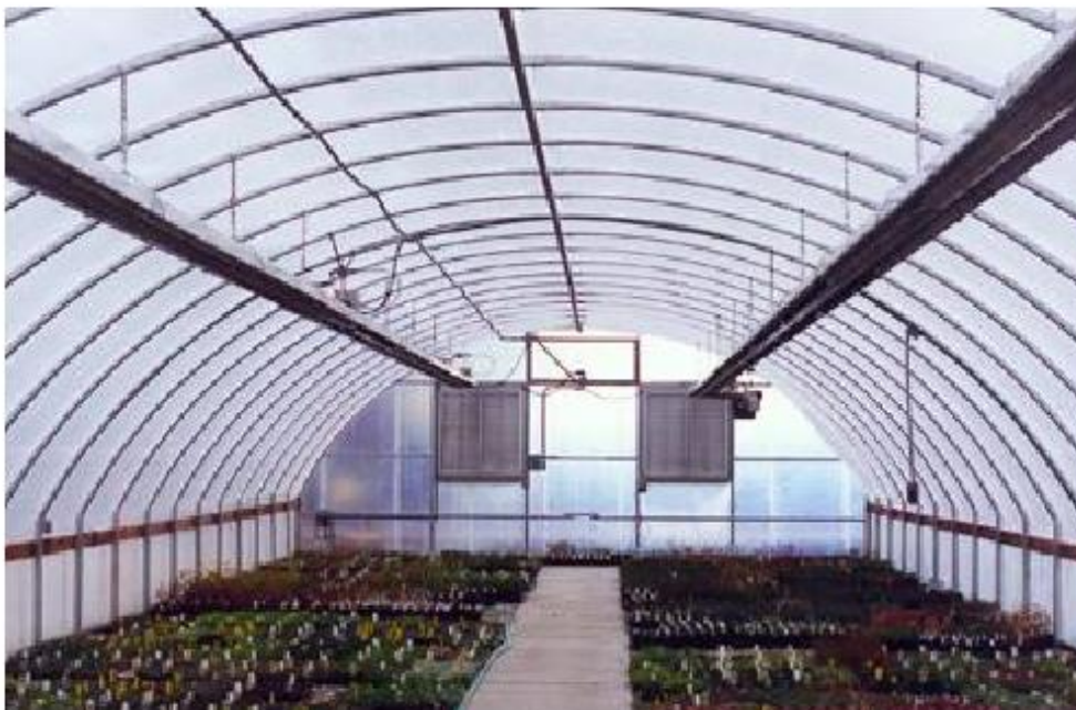
Εικόνα27. Gas-Fired Infrared Heating System
