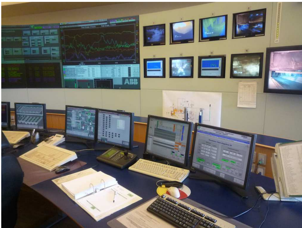
Εικόνα 5.1.6 Παράδειγμα προγράμματος SCADA Control Room
