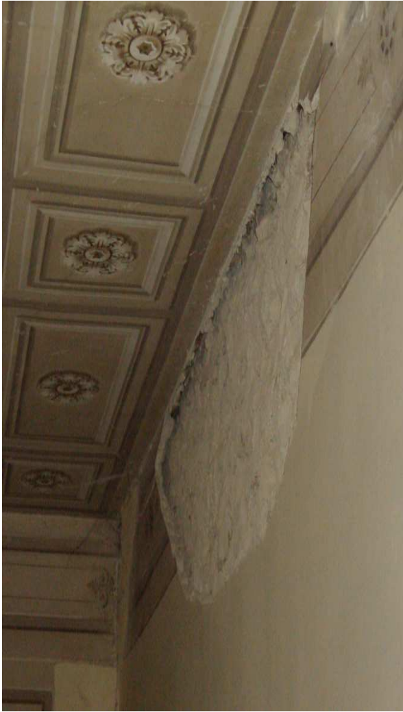
Εικ.2.63 Αποκόλληση επιχρίσματος στο κλιμακοστάσιο του ορόφου.
