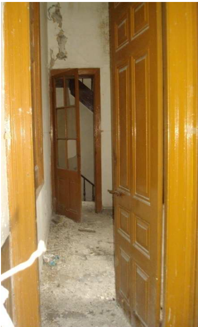
Εικ.2.28 Μονόφυλλη ταμπλαδοτή πόρτα κουζίνας ορόφου. Στο βάθος μονόφυλλη ταμπλαδοτή πόρτα με φεγγίτη, είσοδος κεντρικού κλιμακοστασίου.
