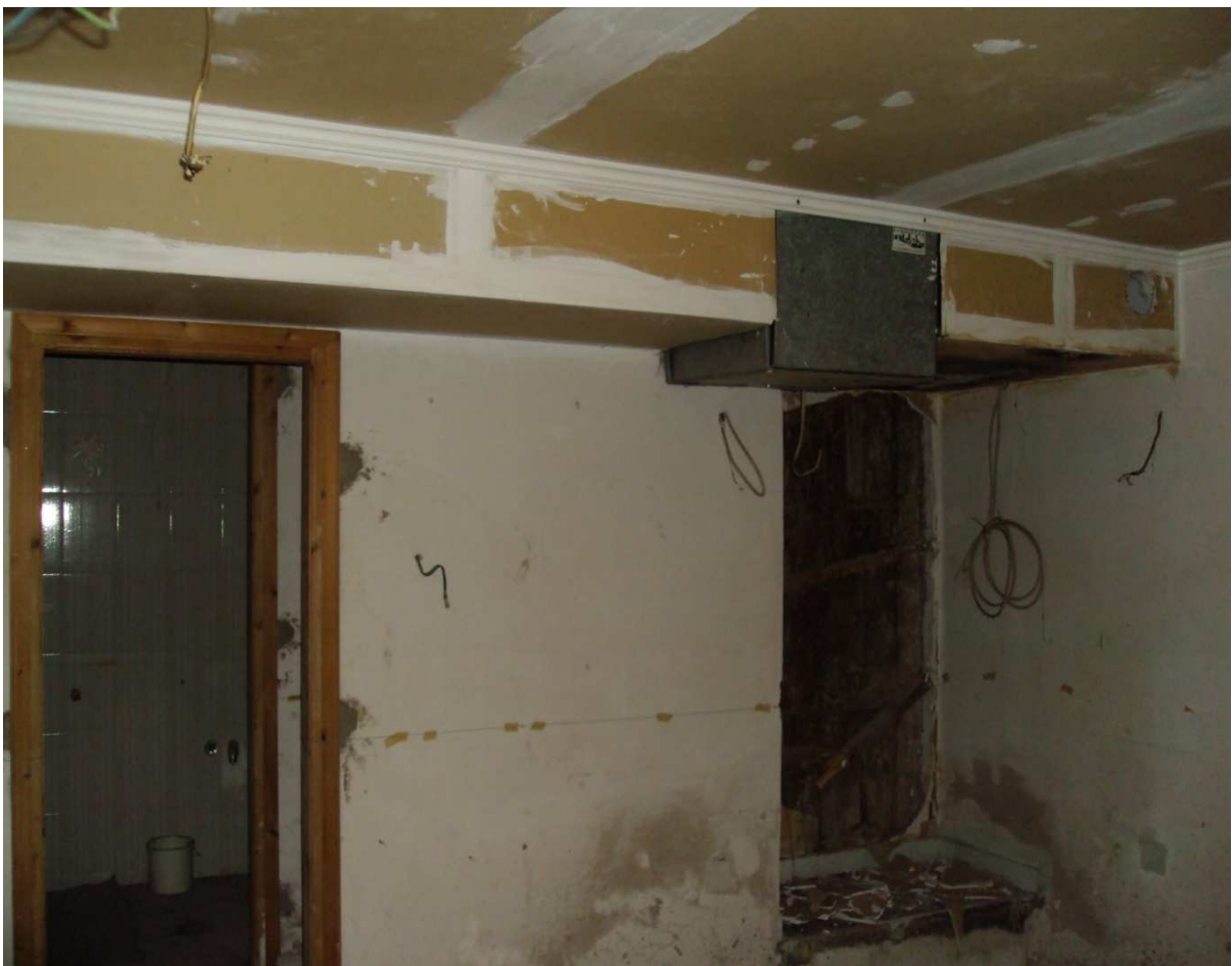
Εικ.2.10 Αριστερά το W.C. του καταστήματος, δεξιά ξύλινη πόρτα που οδηγεί στον προαύλιο χώρο. Διακρίνεται επίσης η παράνομη ψευδοροφή.
