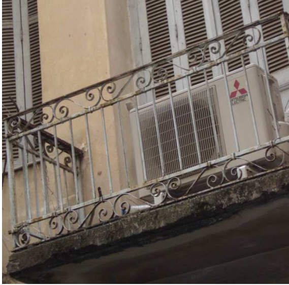
Εικ.2.71 Αποκόλληση σκυροδέματος και οξείδωση σιδηρού οπλισμού.
