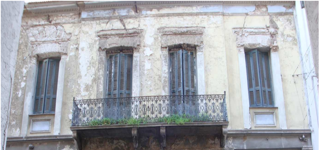
Εικόνα 2.61 Ρωγμές στα υπέρθυρα των ανοιγμάτων της πρόσοψης που εξαντλούνται στην στέψη της τοιχοποιίας.
