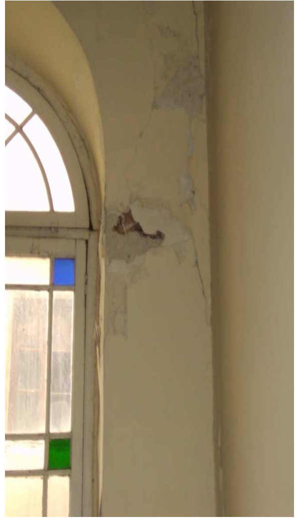
Εικ.2.64 Ρωγμές δεξιά του παραθύρου στο κλιμακοστάσιο του ορόφου.
