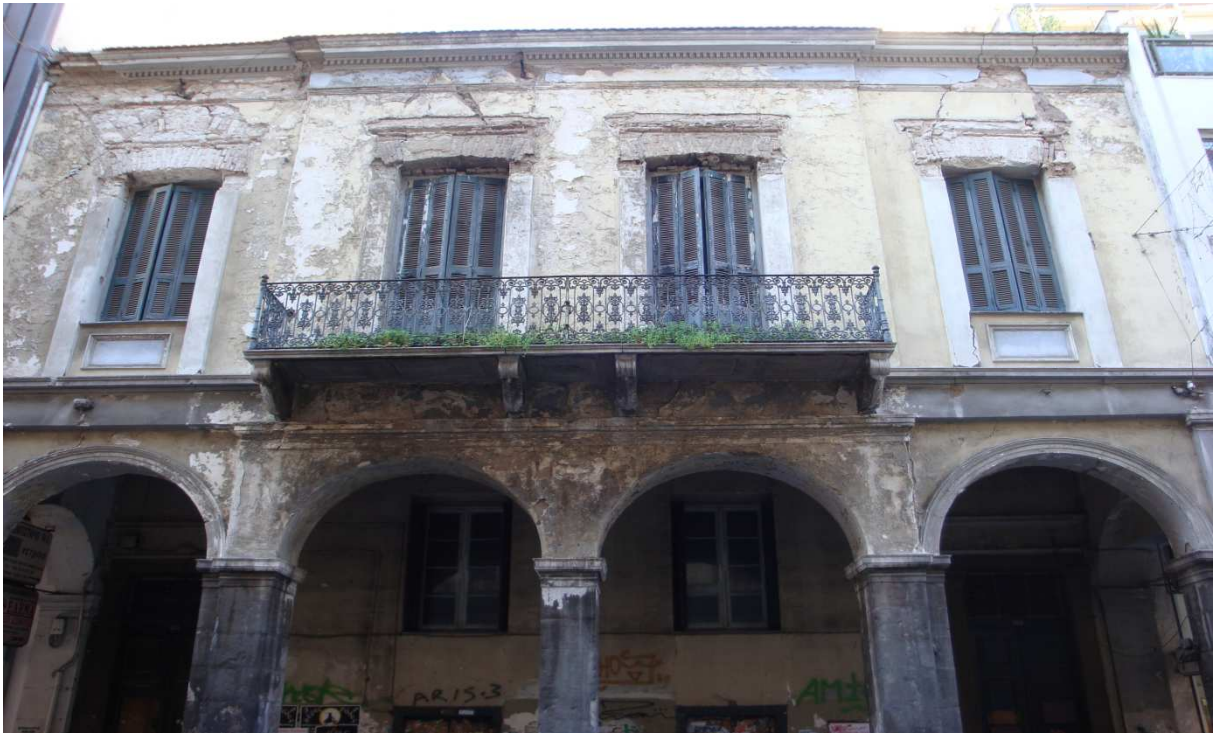
Εικ.2.5 Σημερινή άποψη της πρόσοψης. Μετά το σεισμό του 2008 τα αετώματα αποκολλήθηκαν και μεταφέρθηκαν σε χώρο της Πυροσβεστικής
