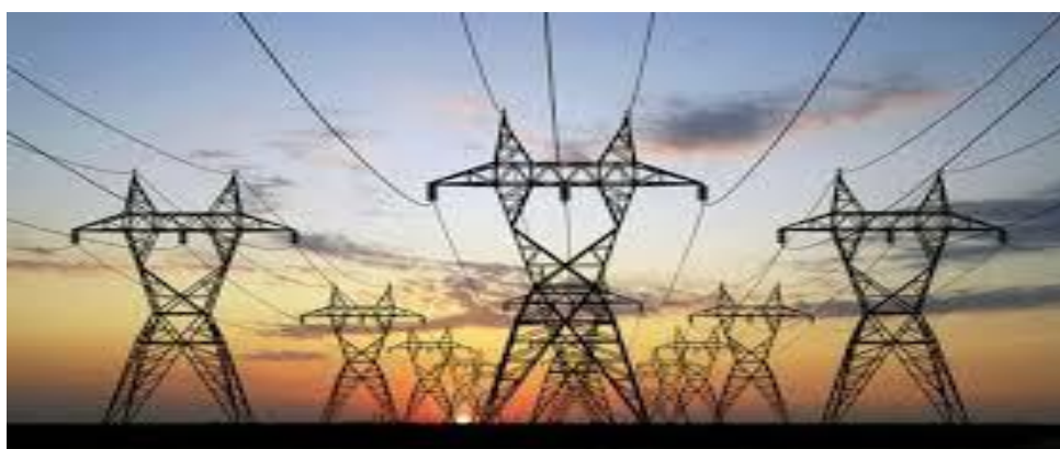
Σχήμα 1.2 Γραμμές μεταφοράς ηλεκτρικής ενέργειας.
