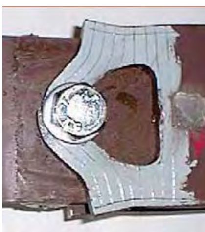
Εικόνα 13: Σύνθλιψη Άντυγας Οπής – Πηγή: Σημειώσεις «ΣΙΔΗΡΕΣ ΚΑΤΑΣΚΕΥΕΣ II» Εθνικού Μετσόβιου Πολυτεχνείου - Διάλεξη III
