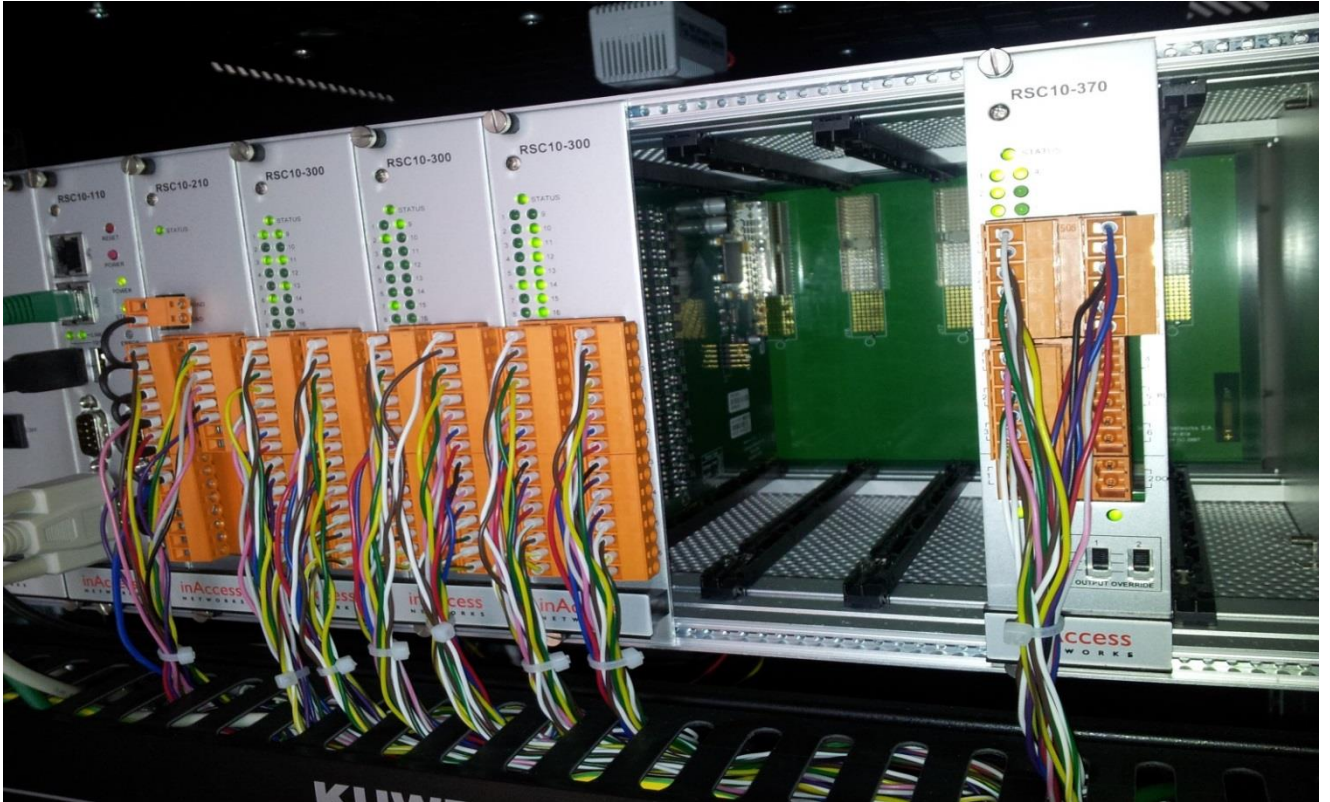
Εικόνα 3.15 Σύστημα RSC10 εγκατεστημένο σε Φ/Β πάρκο
