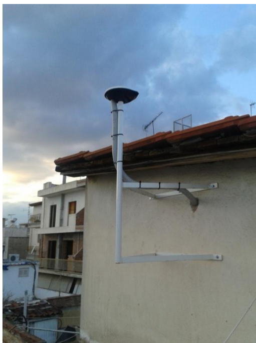
Εικόνα Μόνιμου Σταθμού Αναφοράς στον Πειραιά
