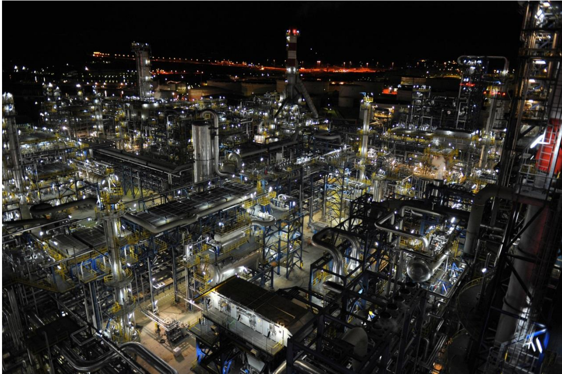
Εικ. 3.16 Οι εγκαταστάσεις του διυλιστηρίου ΕΛ.ΠΕ. ΑΕ στην Ελευσίνα, με επαρκή τεχνητό φωτισμό σε όλες τις εγκαταστάσεις.
