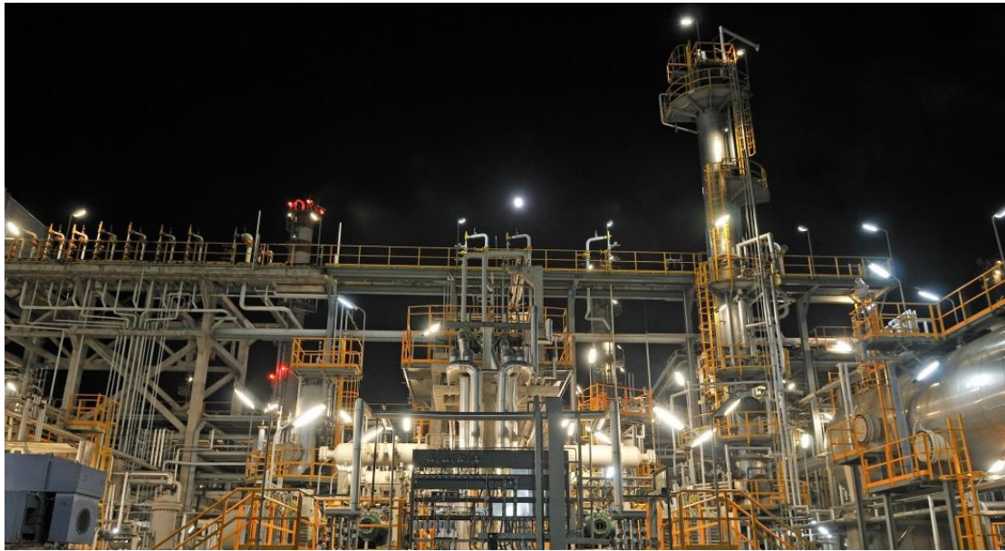
Εικ. 2.6 Σωληνώσεις διανομής υγρών και ατμού (πηγή: http://www.helpe.gr/media-center/media-gallery )
