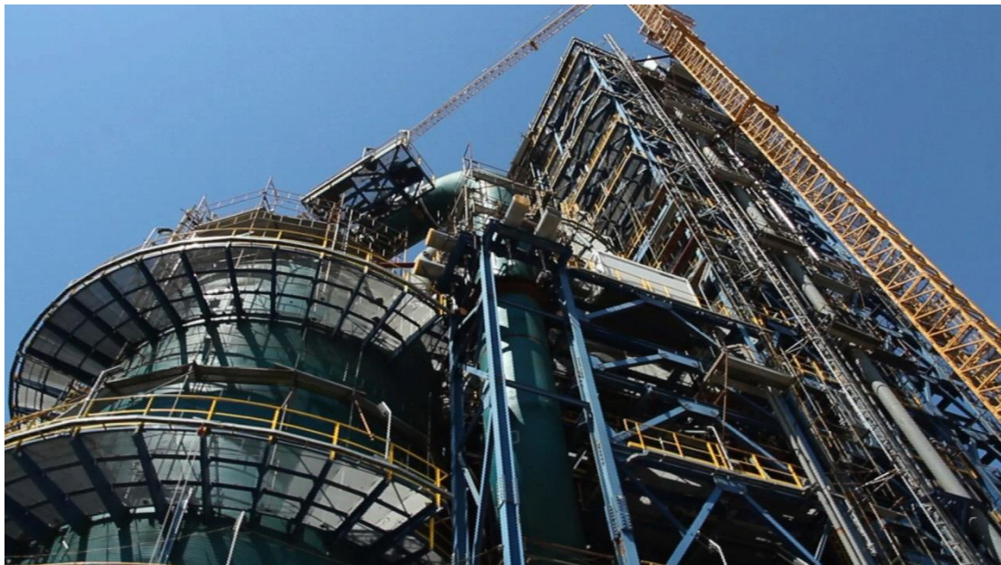
Εικ. 3.15 Εγκαταστάσεις δυλιστηρίου όπου διακρίνονται πατάρια με προστατευτικά κιγκλιδώματα
