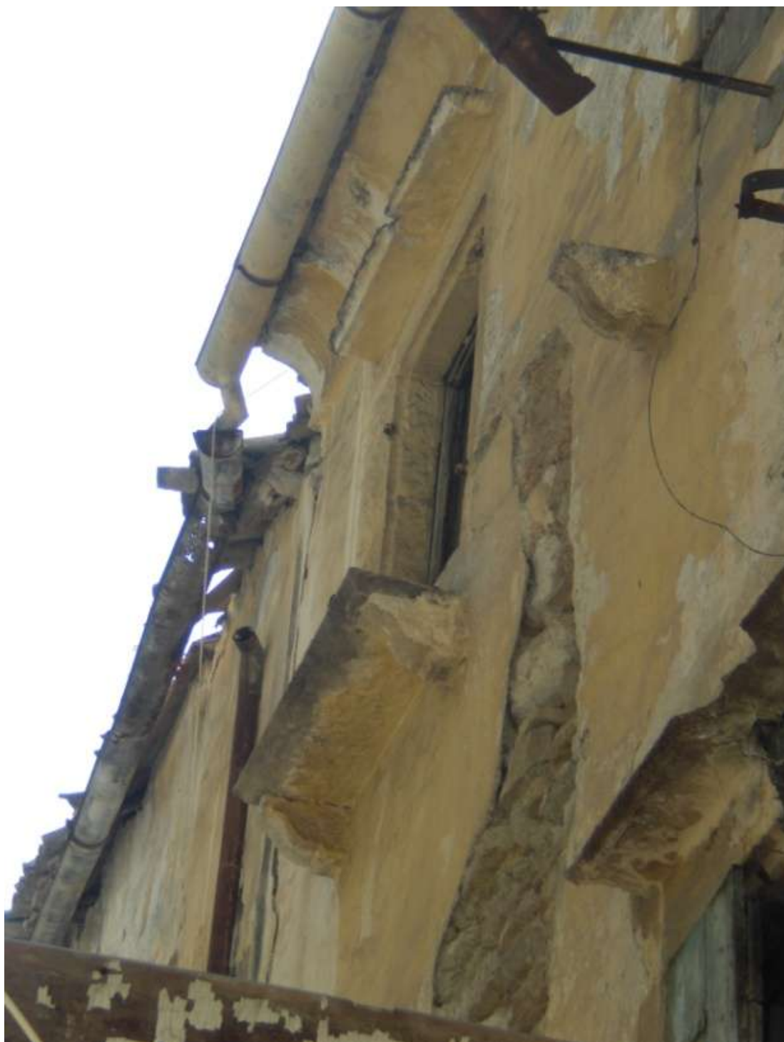
Εικόνα 33 Η απορροή του νερού γινόταν μέσα από λούκια (ντερέδες) που τρέχουν σε όλο το μήκος των στεγών με ελαφρά κλίση προς τις υδρορροές, οι οποίες βρίσκονται σε συγκεκριμένες θέσεις των όψεων και είναι ορατές σε όλο το ύψος των κτιρίων
