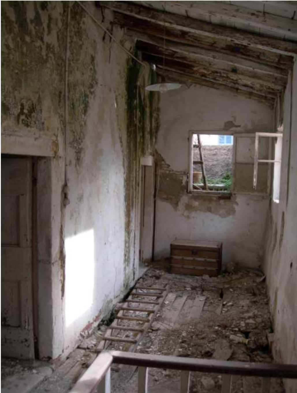
Εικόνα 34 Διάδρομος Β ορόφου. Το πάτωμα του ορόφου έχει φουσκώσει από την υγρασία. Υγρασία διακρίνεται επίσης και στη τοιχοποιία. Το μεγαλύτερο τμήμα του επιχρίσματος της τοιχοποιίας έχει αποκολληθεί, ενώ τέλος οι ξύλινες τεγίδες φαίνονται αποσαθρωμένες.
