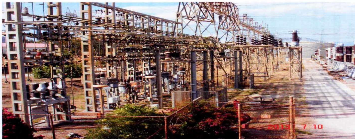
Μονάδα IV του ΑΗΣ Αλιβερίου
