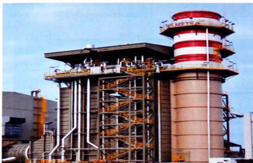
Λέβητας ανάκτησης Θερμότητας του ΑΗΣ Αλιβερίου
