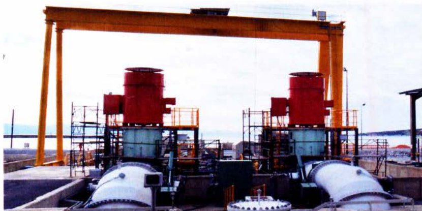
Υδροληψία Θαλασσινού νερού του ΑΗΣ Αλιβερίου
