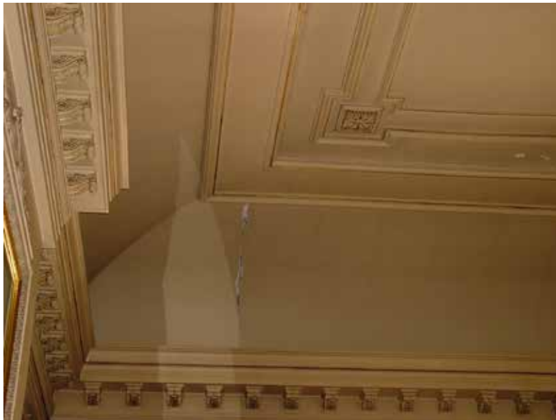
Εικόνα 22: Στη συγκεκριμένη τοιχοποιία προκλήθηκε μεγάλη ρωγμή από το σεισμό και αποκαταστάθηκε με την χρήση εποξειδικής ρητίνης.
