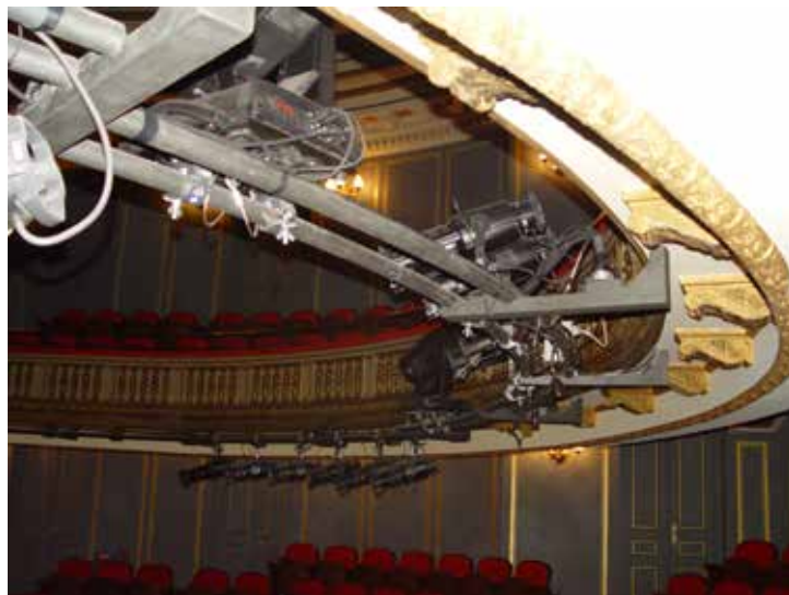
Εικόνα 17 & 18: Φωτιστικός εξοπλισμός στους εξώστες
