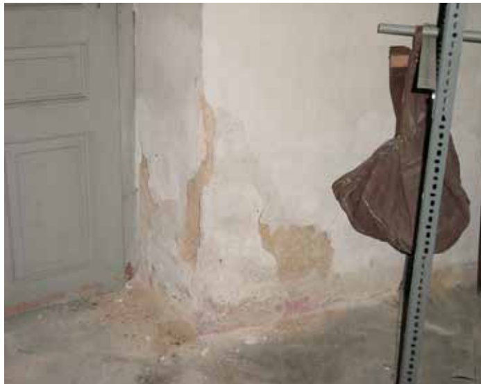
Εικόνα 24: Διάβρωση τοίχου. Έγινε ξύσιμο και σοβατίστηκε
