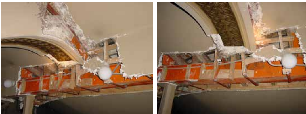
Εικόνα 36 & 37: Ταβάνι με βάση ξύλινης δοκού, καλυμμένο με γυψοσανίδα, με τη βοήθεια πλέγματος.
