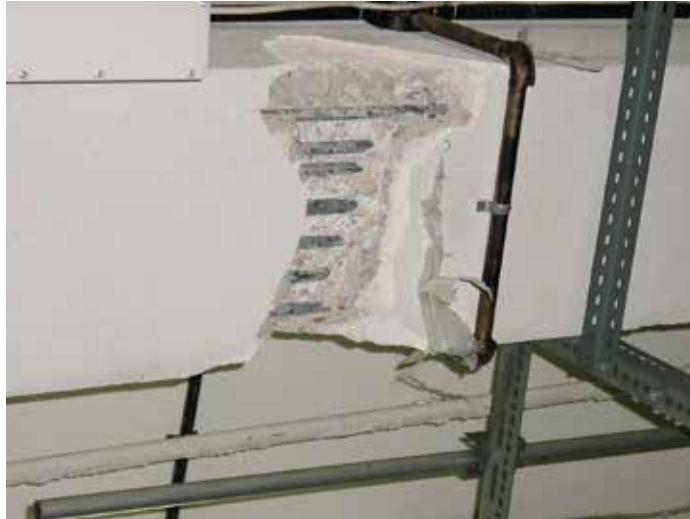
Εικόνα 23: Καταστροφή δοκαριού στο χώρο των παρασκηνίων. Έγινε καθαρισμός για να φανούν οι εσωτερικές του λεπτομέρειες (σίδερα, χάλυβας, σκυρόδεμα) και γεμίστηκε με μη συρρικνωμένο τσιμέντο, γιατί κρατάει τον χάλυβα και έχει καλύτερες αντοχές.
