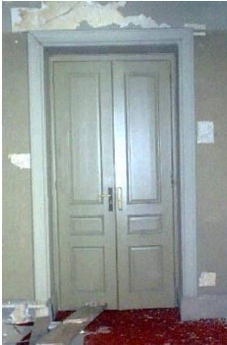
Εικόνα 19: Εξωτερική πόρτα που οδηγεί στον β' εξώστη. Πόρτα που οδηγεί στην αριστερή πλευρά της σκηνής του εθνικού. Είναι εμφανής η διάβρωση και η υγρασία στους τοίχους.
