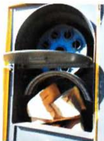
Εικόνα 2.18 Εσωτερικό λέβητα πολλαπλής καύσης
