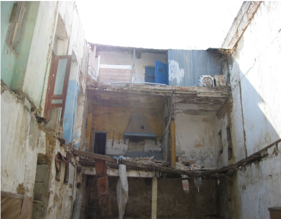
Εικόνα 11 Τα πατώματα του μπροστινού τμήματος έχουν καταστραφεί.
