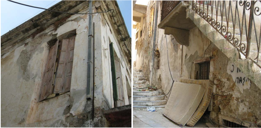
Εικόνα 20 Τμηματικά θα πρέπει να καθαιρευθούν υλικά που έχουν αστοχήσει.
