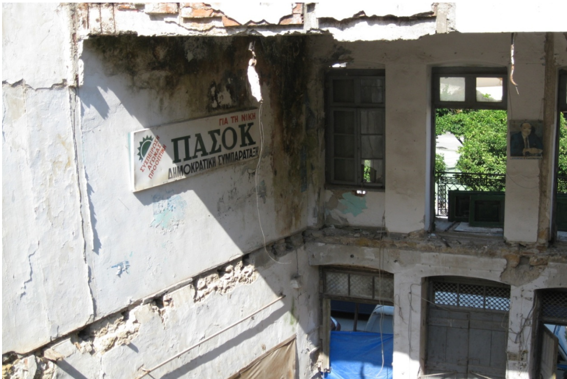
Εικόνα 8 Η υγρασία που έχει εισχωρήσει στο εσωτερικό του κτιρίου έχει προκαλέσει σήψη στα περισσότερα ξύλινα μέλη και έχει καταστρέψει το επίχρισμα τμημάτων της τοιχοποιίας.
