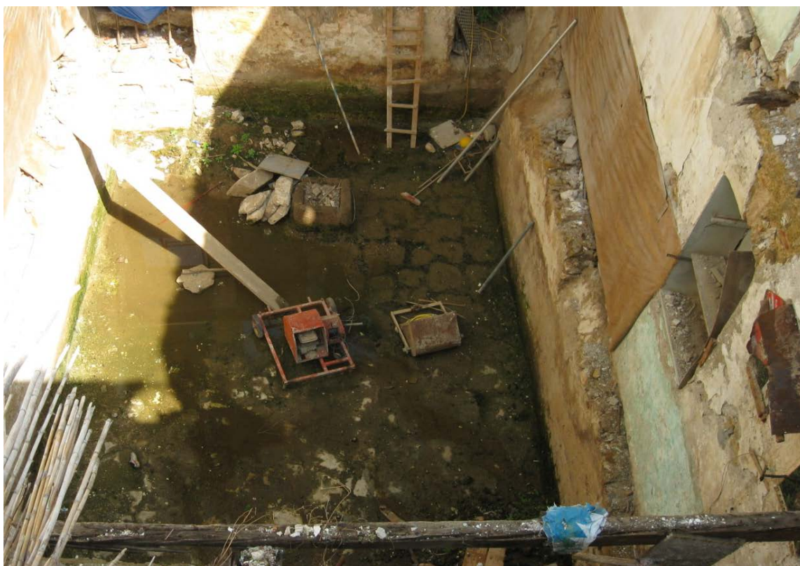
Εικόνα 9 Η ανυπαρξία της σκεπής έχει προκαλέσει στο κτίριο σημαντικά προβλήματα. Το κυριότερο είναι η έκθεση του εσωτερικού του στα καιρικά στοιχεία.
