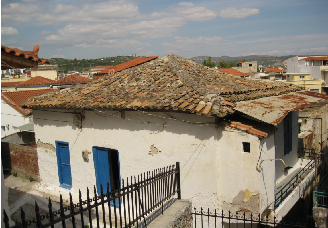
Εικόνα 5 Το πίσω τμήμα του κτιρίου βρίσκεται σε καλύτερη κατάσταση σε σχέση με το υπόλοιπο.
