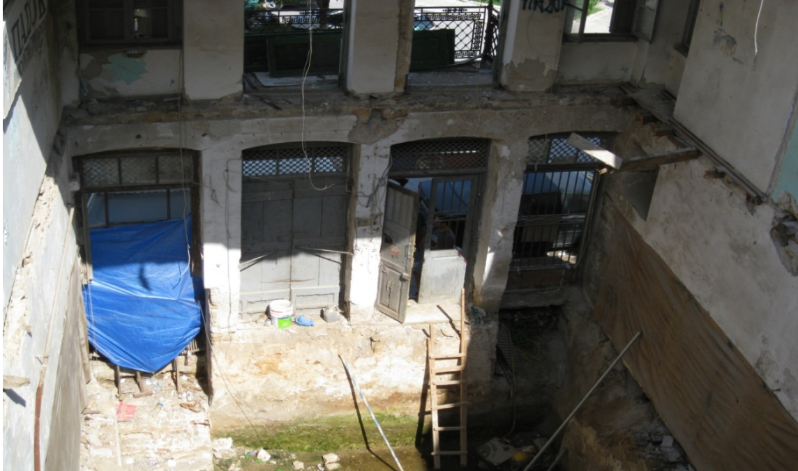
Εικόνα 4 Στο μπροστινό μέρος του κτίσματος παρατηρείται σε όλα τα επίπεδα μερική αποδιοργάνωση έως και ολική καταστροφή των τοίχων, των πατωμάτων και των επιχρισμάτων.
