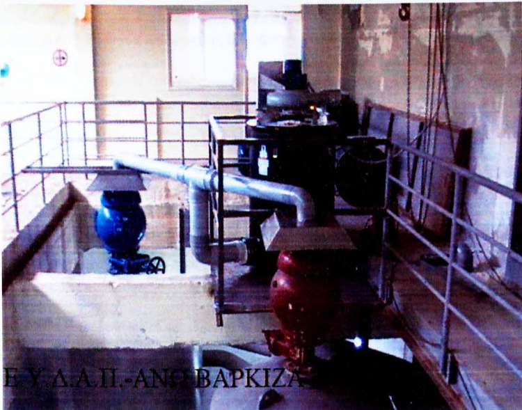
Εικόνα 3.10: Σύστημα Απόσμησης DS300 στο Αντλιοστάσιο Αποχέτευσης Νο38Α
