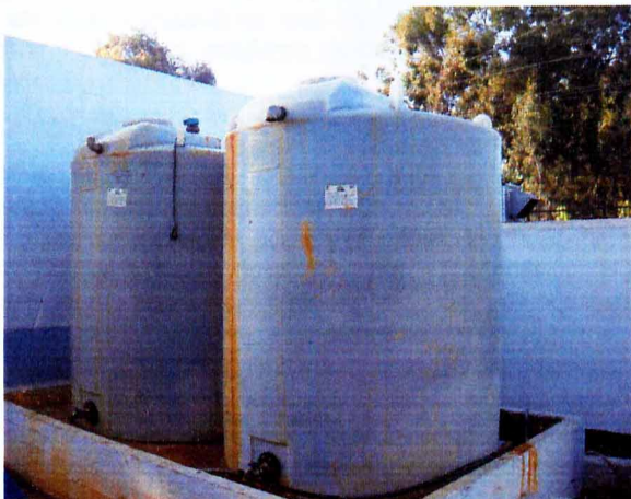
Σχήμα 3.7: Δεξαμενές αποθήκευσης διαλύματος αλάτων δισθενούς σιδήρου και νιτρικών στο Αντλιοστάσιο Αποχέτευσης Νο31
