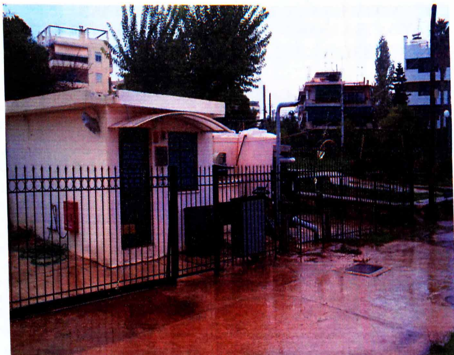
Εικόνα 3.11: Σύστημα Απόσμησης DS300 στο Αντλιοστάσιο Αποχέτευσης Νο35
