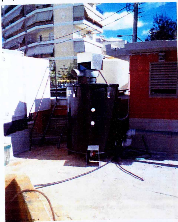
Εικόνα 3.8 : Σύστημα Απόσμησης DS 500 στο Αντλιοστάσιο Αποχέτευσης Νο35
