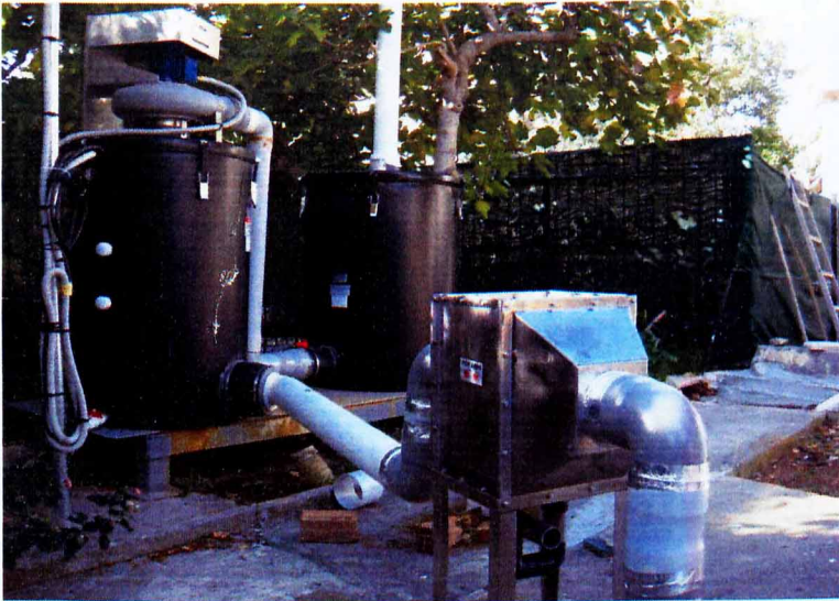
Εικόνα 3.9 : Σύστημα Απόσμησης DS 500 και DS300 στο Αντλιοστάσιο Αποχέτευσης Νο29
