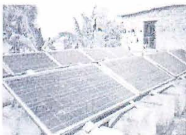
Εικόνα 1.2 : Συστοιχίες φωτοβολταϊκών panel (PV) για την τροφοδοσία ενός σπιτιού σε απομακρυσμένη περιοχή. 177
