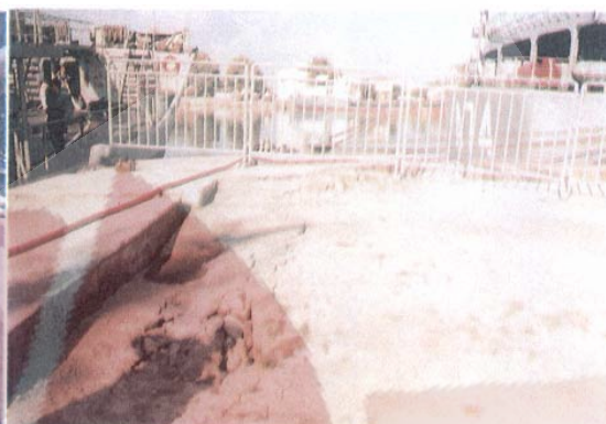
καθίζηση του εδαφους πίσω από τον κρηπιδοτοιχο
