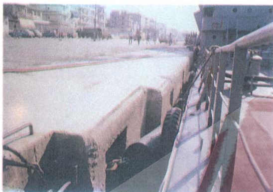
Σχετική μετατόπιση τμημάτων του κρηπιδοτοιχού
