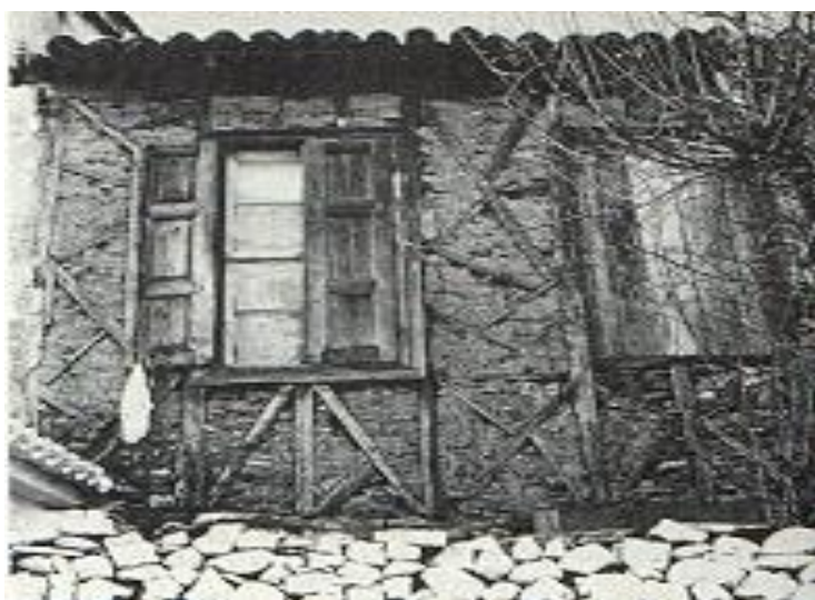
ΣΧ 6.14 Όψη ορόφου σπιτιού με φανερό το σκελετό του τσατμά του οποίου τα κενά έχουν γεμιστεί με τούβλα και μικρές πέτρες
