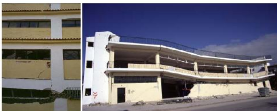
Εικόνα 4. Αστοχίες κοντών υποστυλωμάτων (σεισμός Αθήνας 1999)
